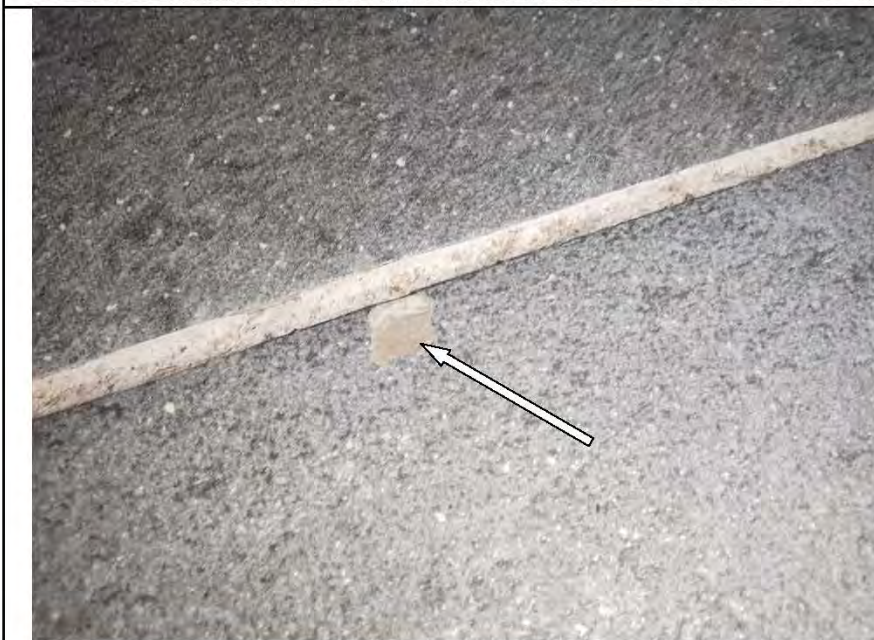
Фото №41. Отбитости на напольной керамической плитке в ванной комнате.
