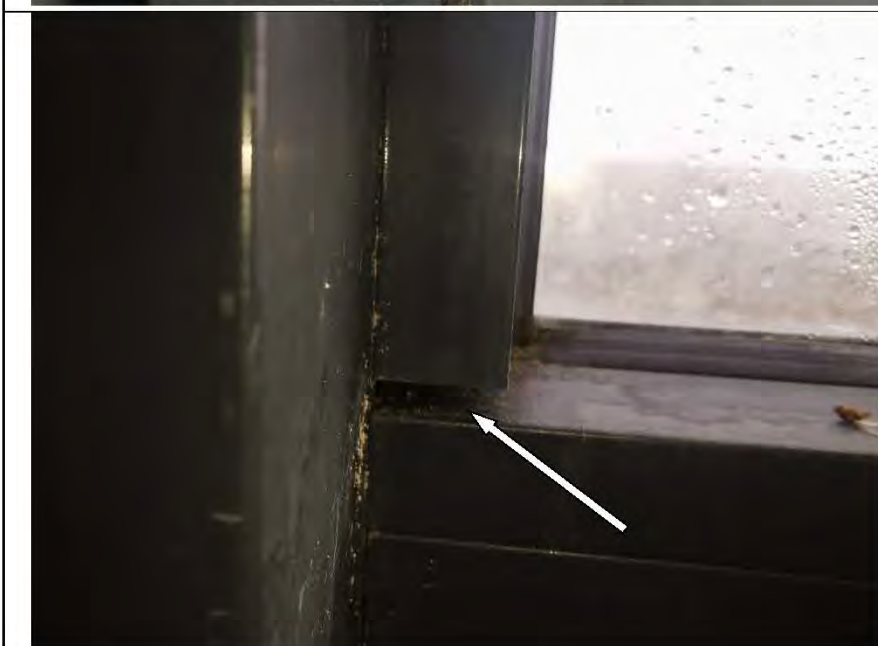
Фото №60. Зазор в месте стыка металлических профилей оконного блока на лоджии.
