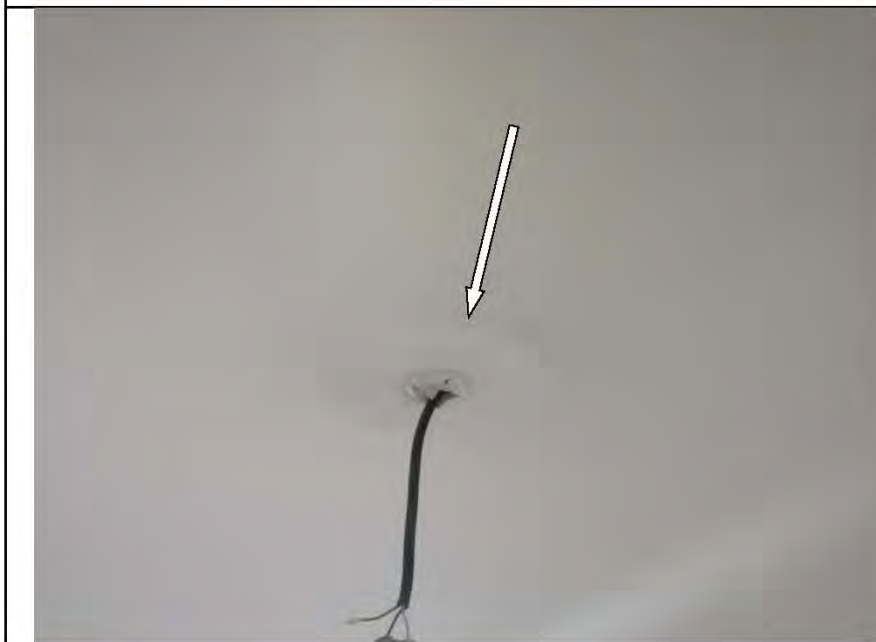
Фото №44. Видимость инженерных сетей на полотне натяжного потолка в спальне.
