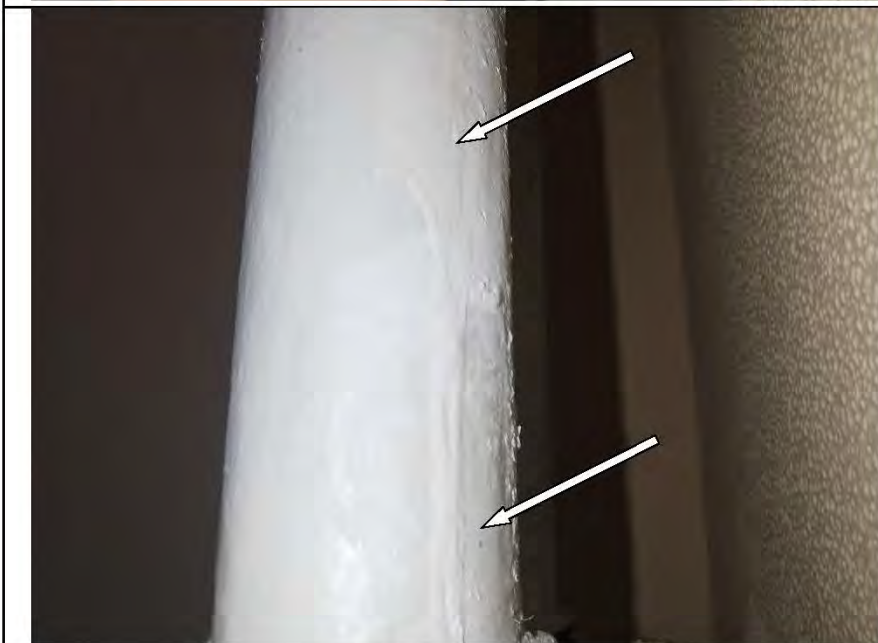
Фото №75. Окрашивание труб отопления выполнено с дефектами в спальне.
