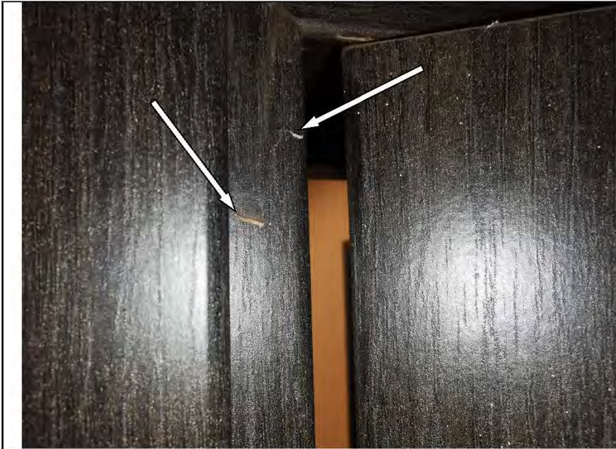
Фото №64. Царапины на коробе деревянного дверного блока в гостиной.
