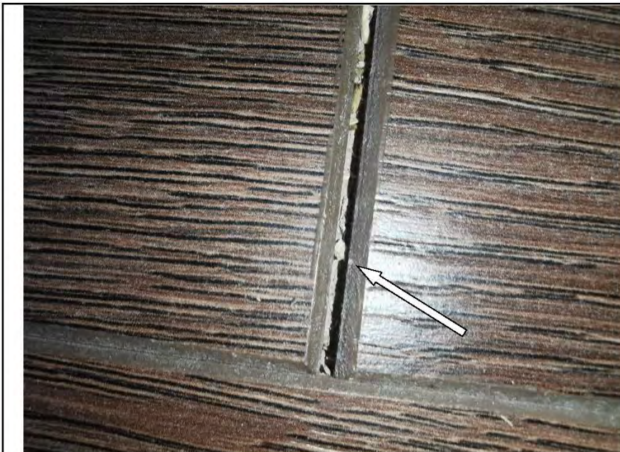
Фото №31. Зазор между соседними досками ламината в гостиной.
