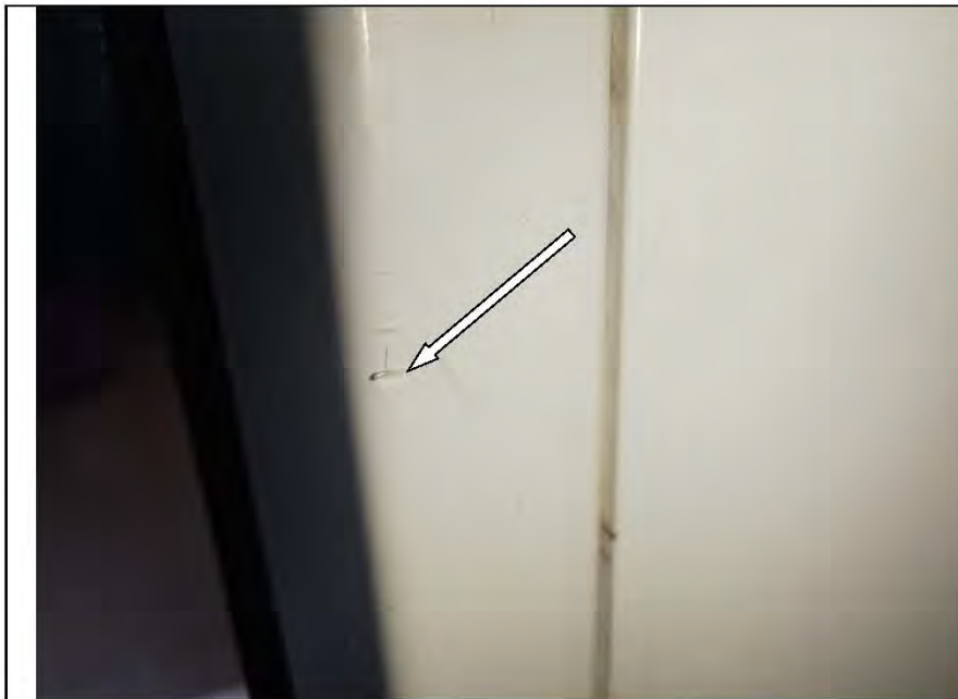
Фото №52. Царапины на профиле ПВХ дверного блока на кухне.
