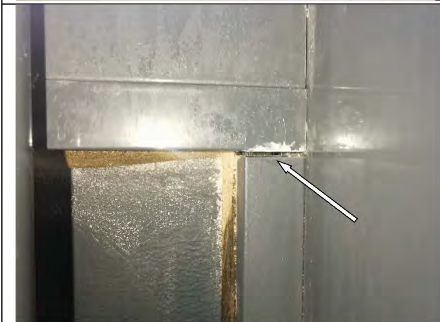
Фото №59. Зазор в месте стыка металлических профилей оконного блока на лоджии.
