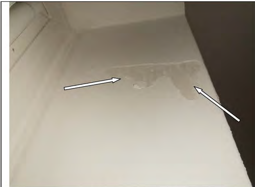
Фото №58. Окрашенные откосы оконного блока ПВХ выполнены с дефектами в кухне.
