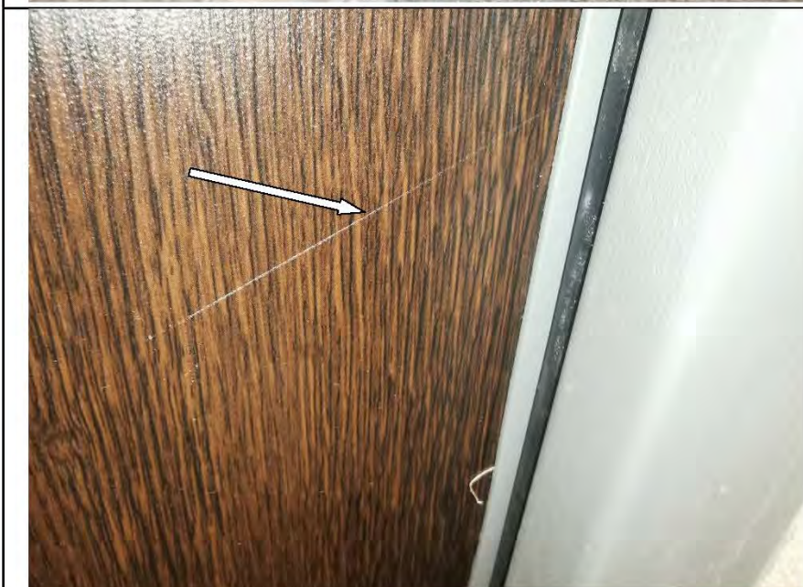
Фото №71. Царапины на полотне входного дверного блока.
