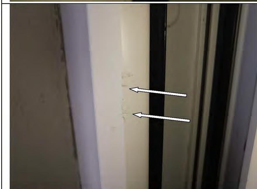
Фото №54. Царапины на профиле ПВХ дверного блока на кухне.
