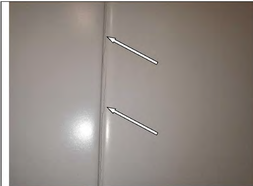
Фото №25. Трещины в затирочных швах настенной керамической плитки в ванной комнате.
