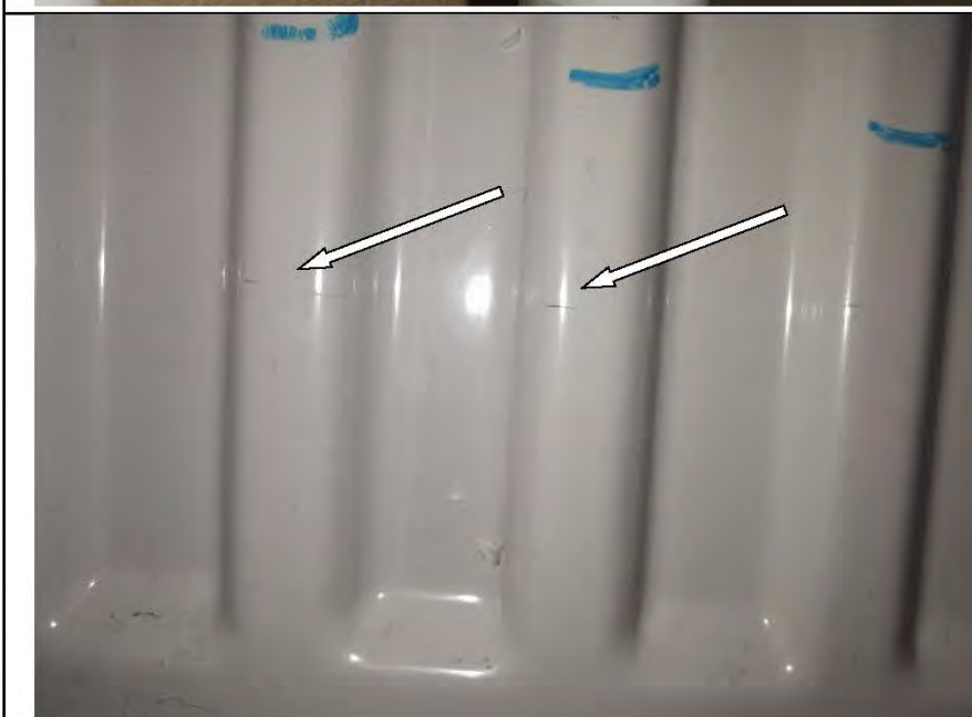
Фото №78. Царапины на радиаторе в спальне.
