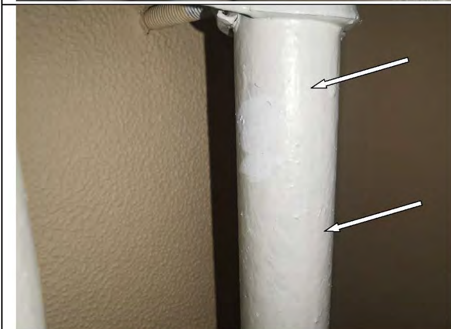
Фото №77. Окрашивание труб отопления выполнено с дефектами в кухне.
