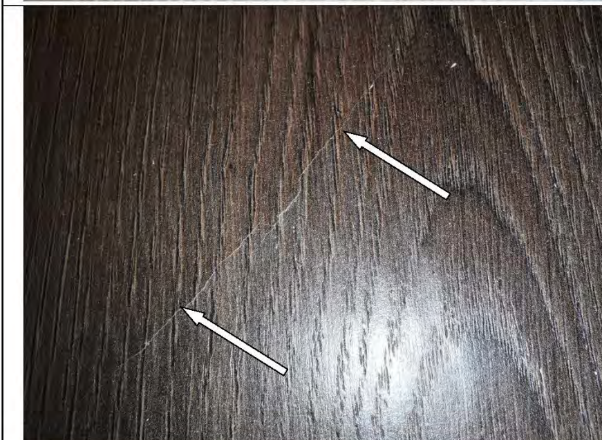
Фото №29. Царапины на напольном покрытии из ламината в коридоре.
