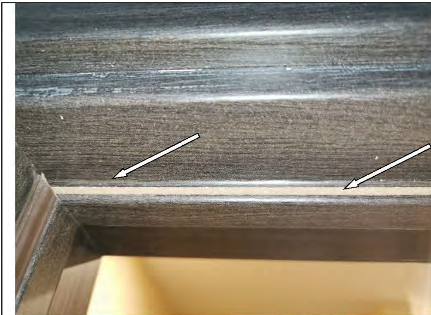
Фото №67. Отсутствует часть уплотняющей прокладки на деревянном дверном блоке в кухне.
