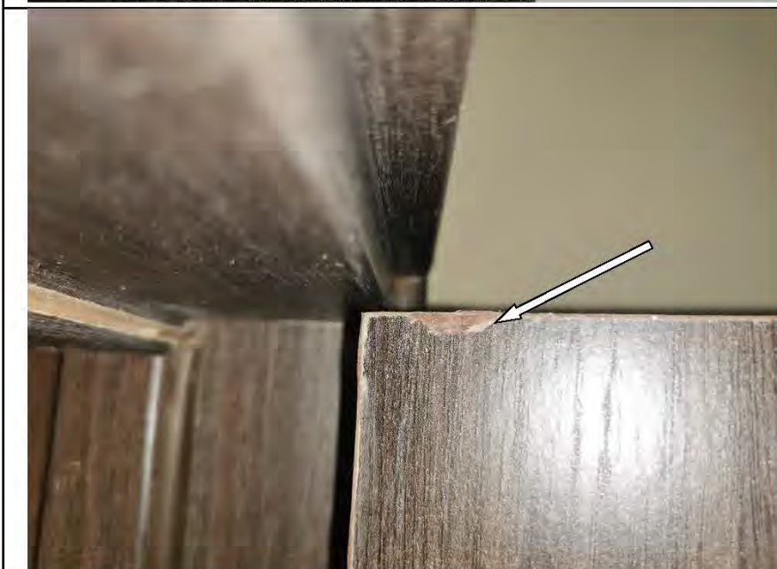
Фото №66. Повреждение ламинации полотна деревянного дверного блока в кухне.
