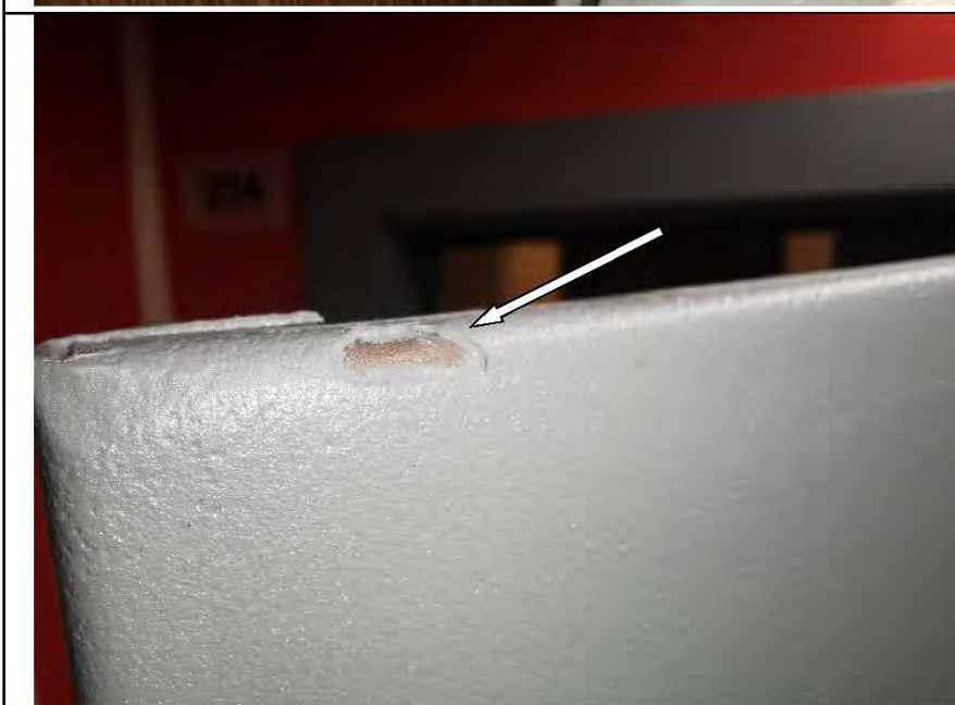
Фото №72. Потертости на полотне входного дверного блока.
