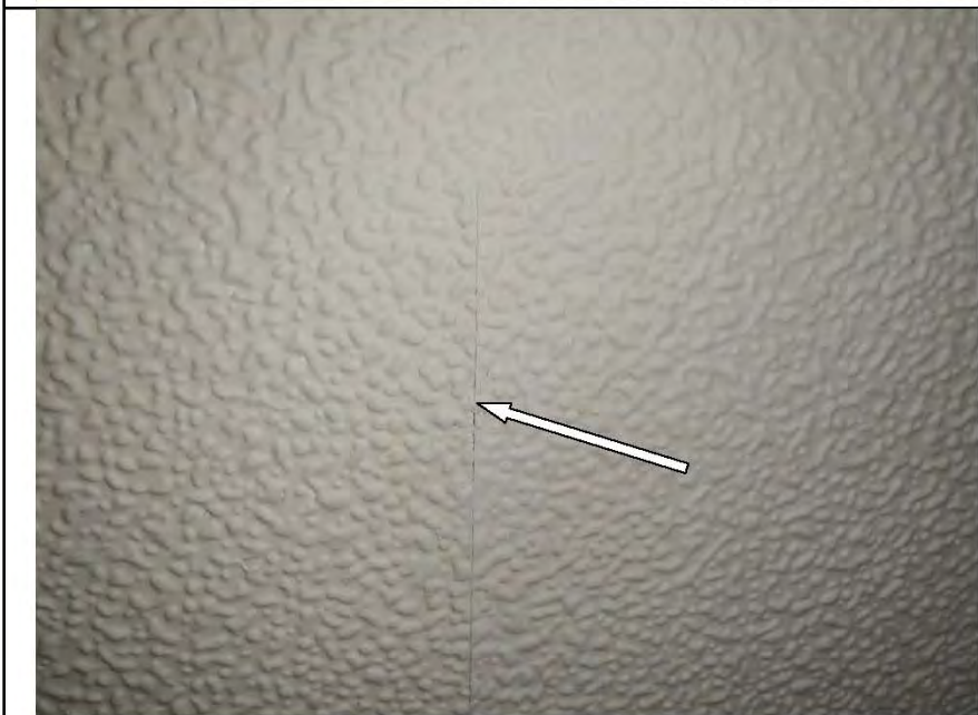
Фото №17. Читаемые обойные стыки в спальне.
