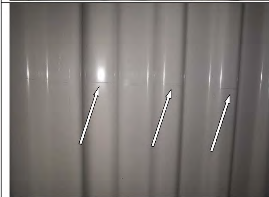
Фото №80. Царапины на радиаторе в кухне.
