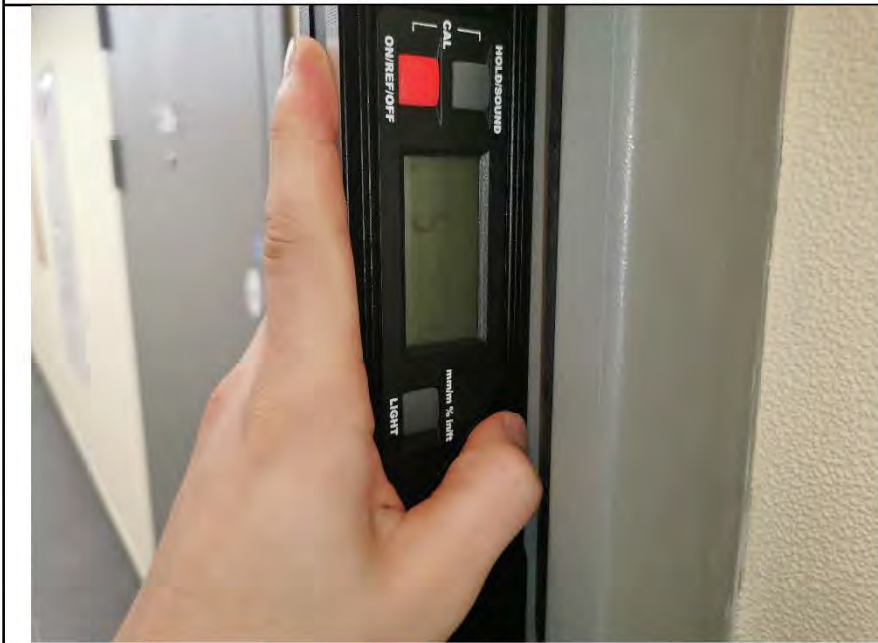
Фото №74. Отклонение короба входного дверного блока.
