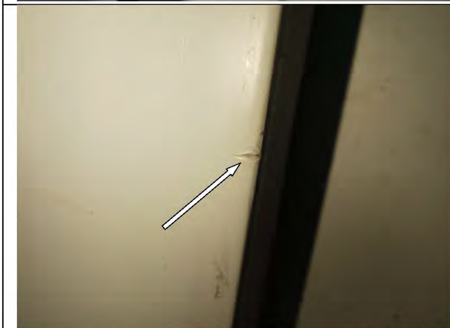
Фото №53. Царапины на профиле ПВХ дверного блока на кухне.
