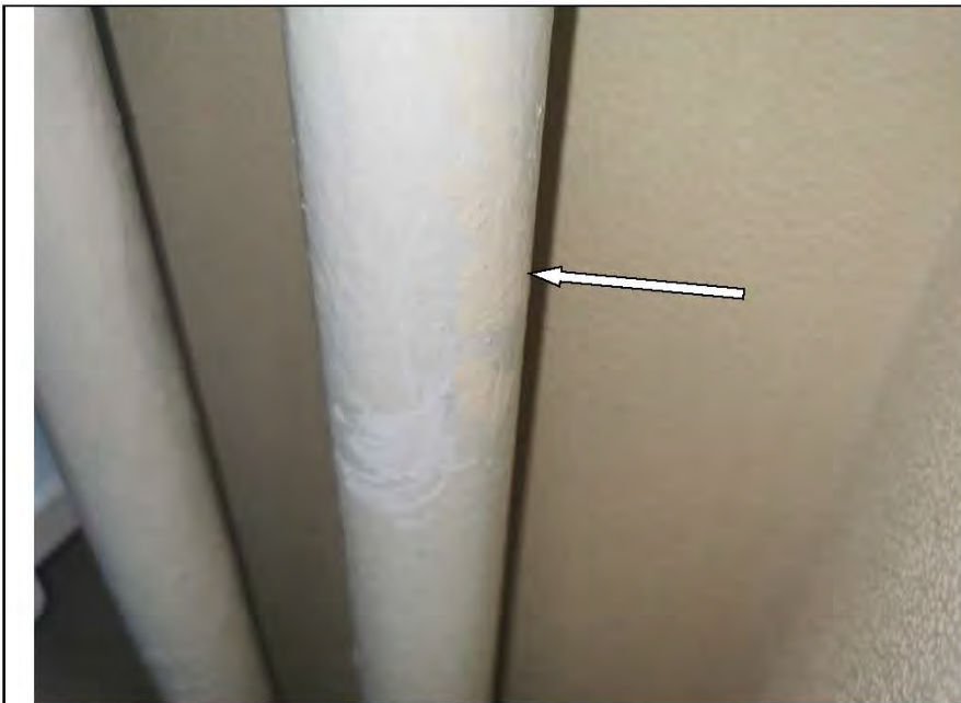
Фото №76. Окрашивание труб отопления выполнено с дефектами в гостиной.
