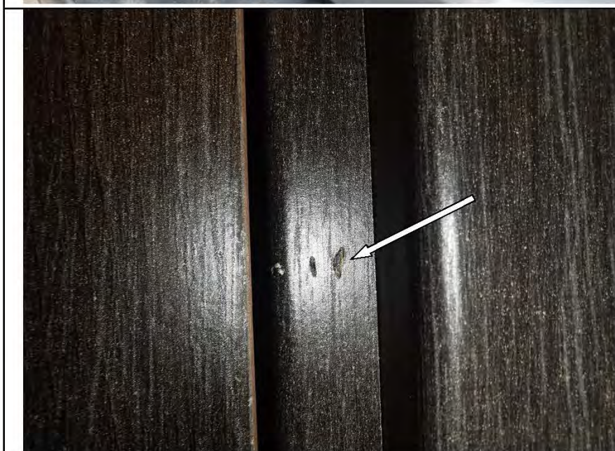
Фото №63. Царапины на коробе деревянного дверного блока в ванной комнате.
