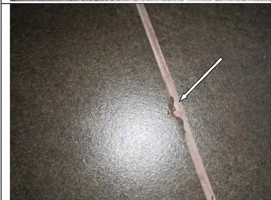
Фото №42. Отбитости на напольной керамической плитке в кухне.
