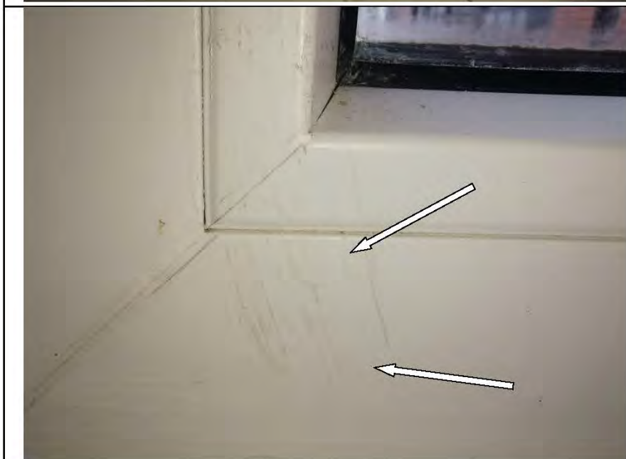
Фото №48. Царапины на профиле ПВХ оконного блока в спальне.
