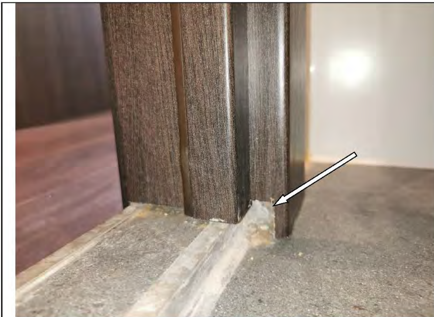
Фото №70. Неплотное прилегание дверного наличника к стене в ванной комнате.
