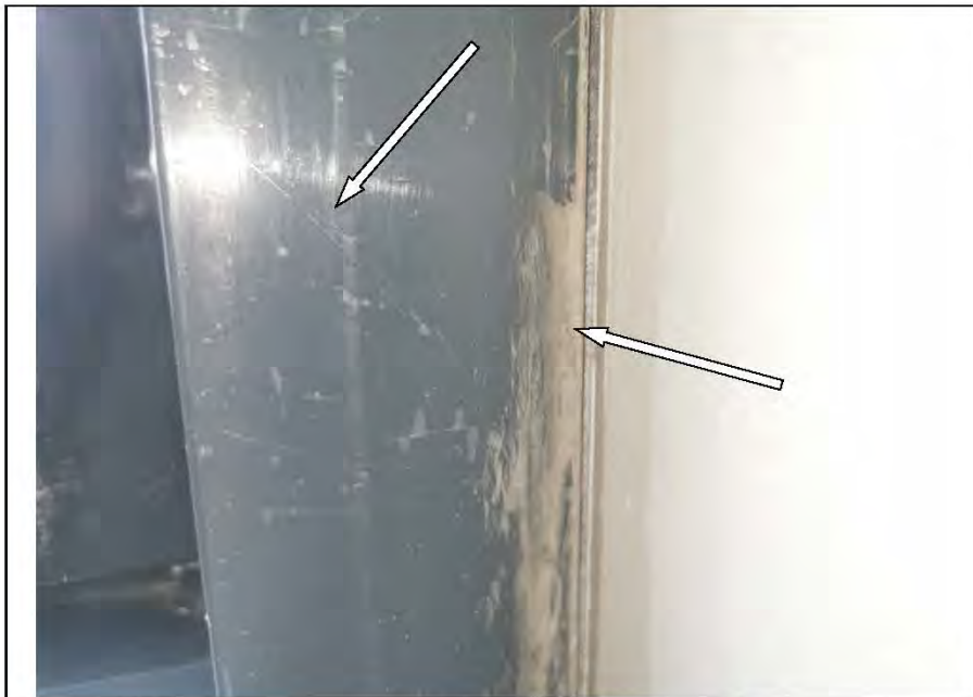
Фото №61. Загрязнения и царапины на профиле металлического оконного блока.
