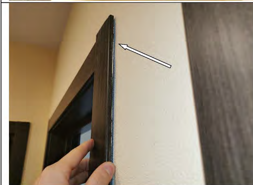
Фото №68. Элементы дверного блока (наличники) соединены не надежно в гостиной.
