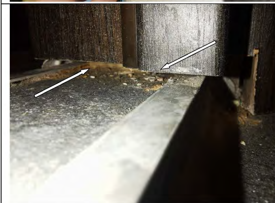
Фото №69. Коротко подрезан короб деревянного дверного блока в ванной комнате.
