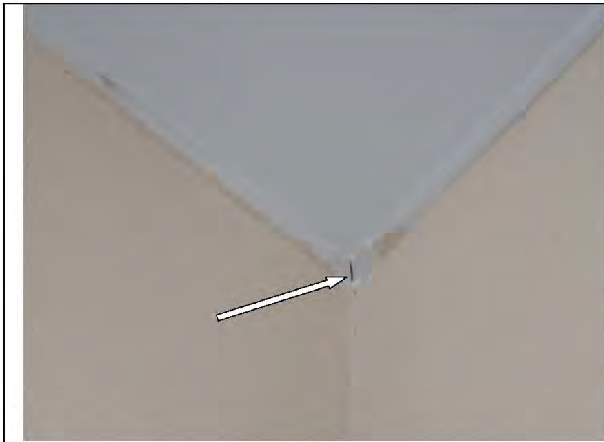
Фото №43. Загрязнение и дефект монтажа декоративного молдинга крепления натяжного потолка в гостиной.
