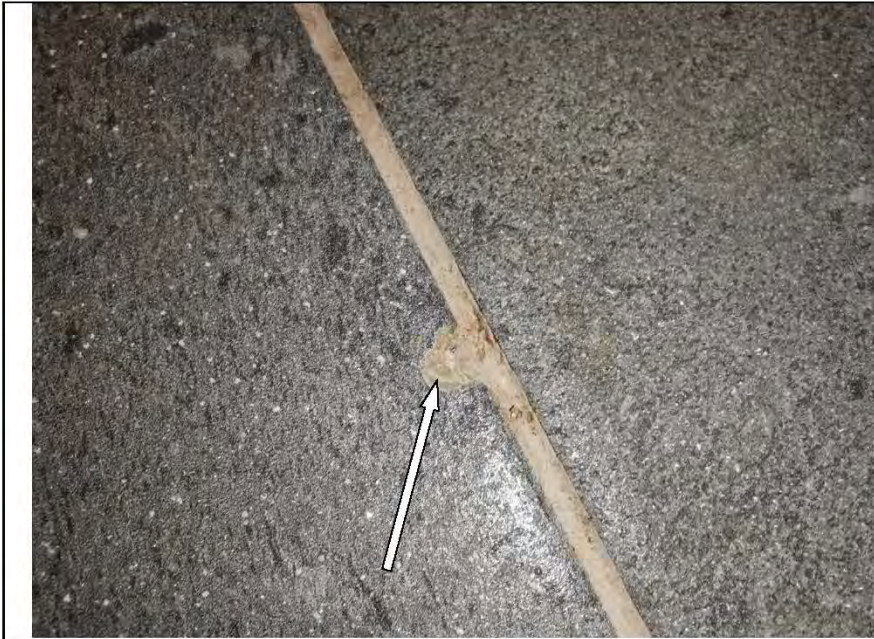
Фото №40. Отбитости на напольной керамической плитке в ванной комнате.
