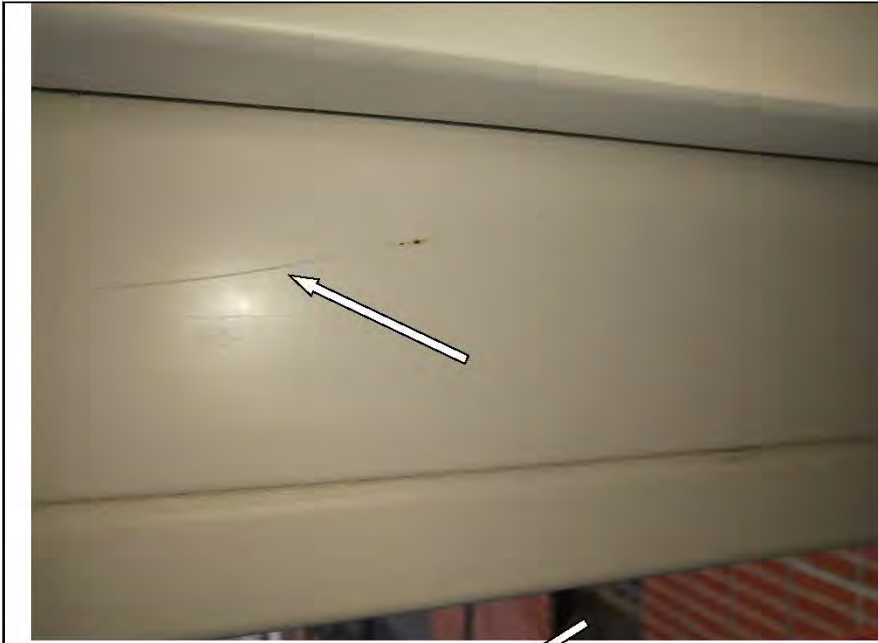
Фото №49. Царапины на профиле ПВХ оконного блока в спальне.
