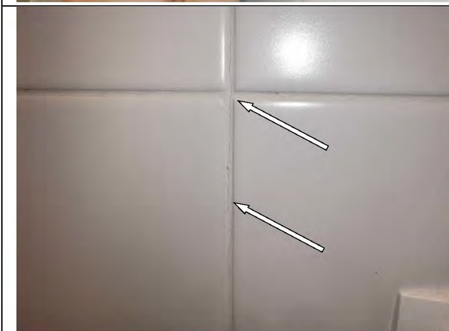
Фото №24. Трещины в затирочных швах настенной керамической плитки в ванной комнате.
