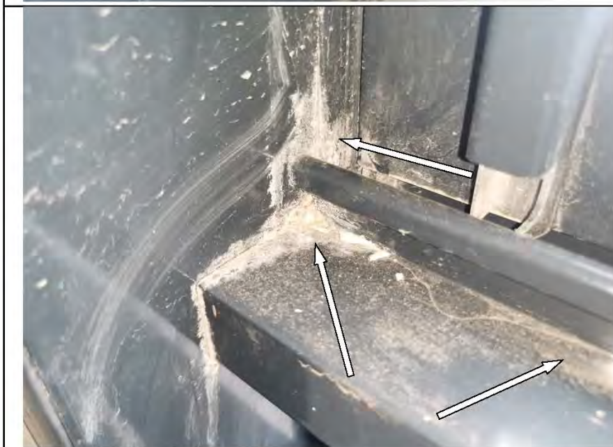
Фото №62. Загрязнения на профиле металлического оконного блока на лоджии.
