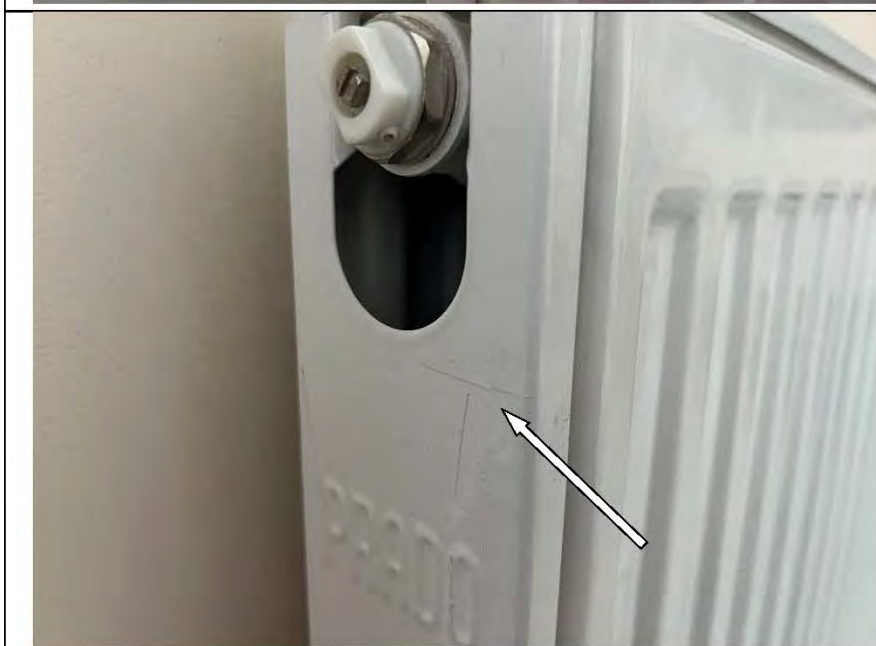
Фото №86. Царапина на отопительном приборе в спальне.
