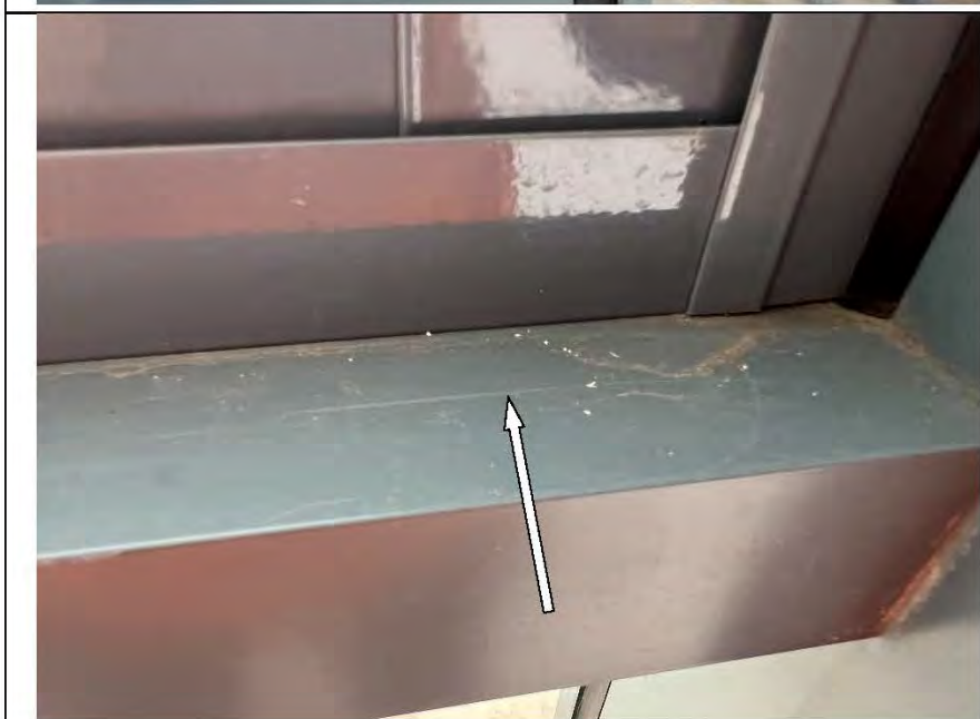
Фото №57. Царапина на металлическом профиле оконного блока на лоджии.
