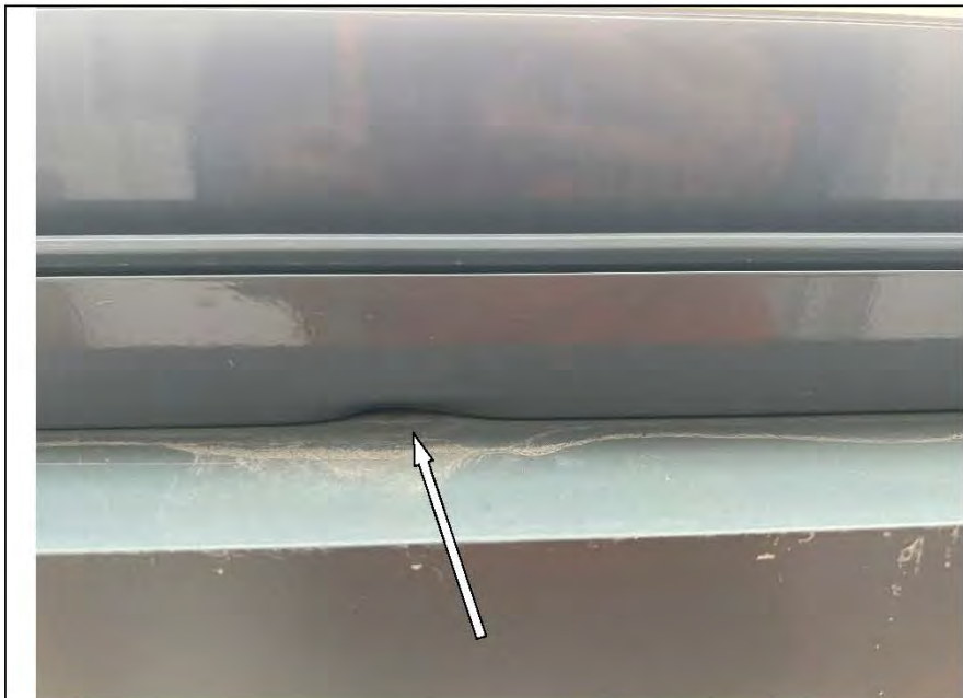
Фото №55. Вмятина на металлическом профиле оконного блока на лоджии.
