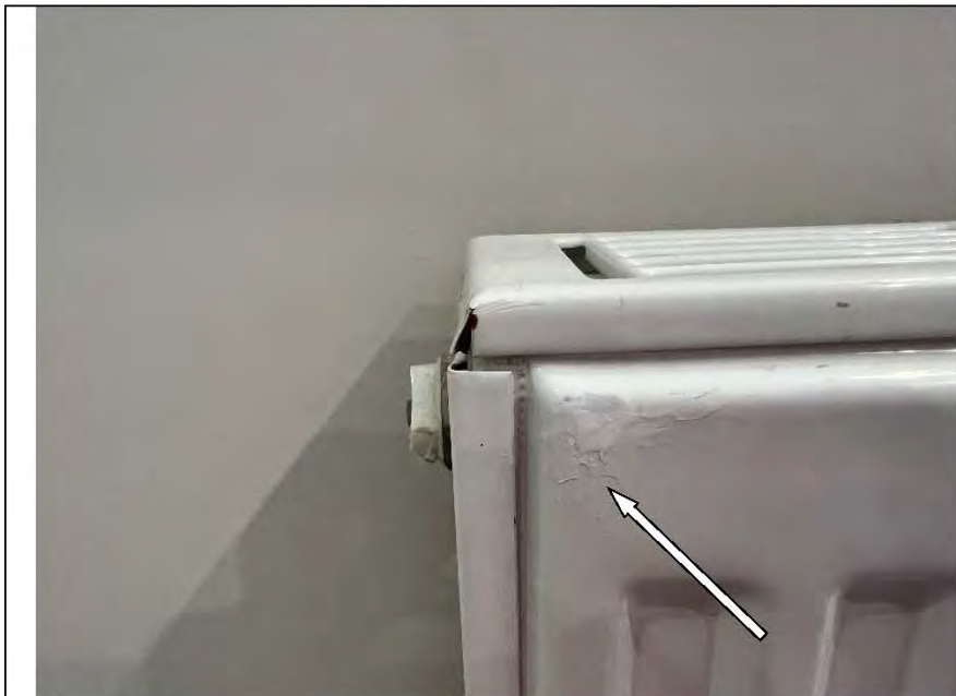
Фото №85. Царапина на отопительном приборе в кухне.
