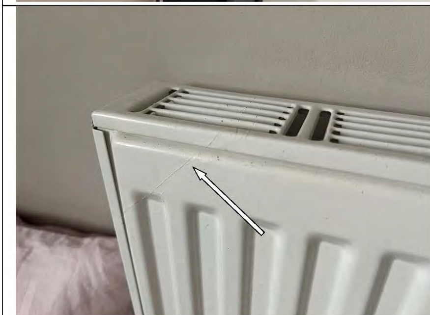
Фото №83. Царапина на отопительном приборе в гостиной.
