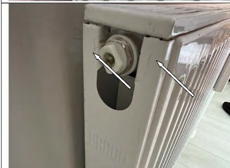
Фото №84. Царапина на отопительном приборе в гостиной.
