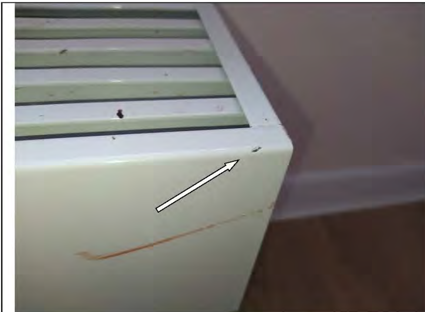
Фото №37. Отопительный прибор имеет дефект покраски защитного кожуха в кухне (сколы).
