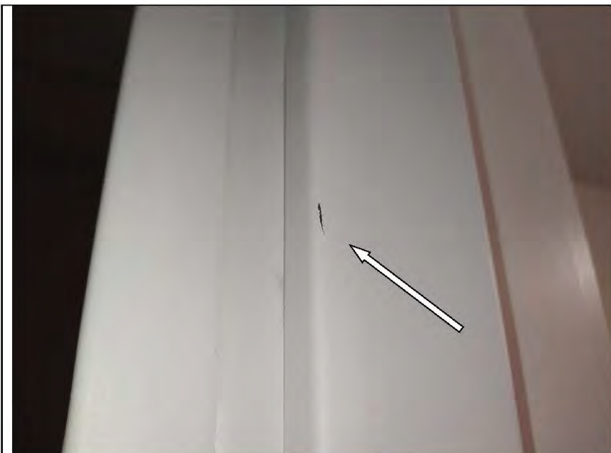
Фото №73. Коробка входной металлической двери имеет дефекты (сколы).
