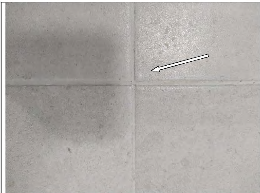
Фото №64. Затирка напольной плитки выполнена с нарушениями в санузле: разность ширины шва.
