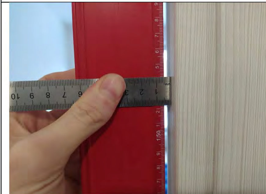
Фото №41. Отклонение коробки дверного блока в спальне.
