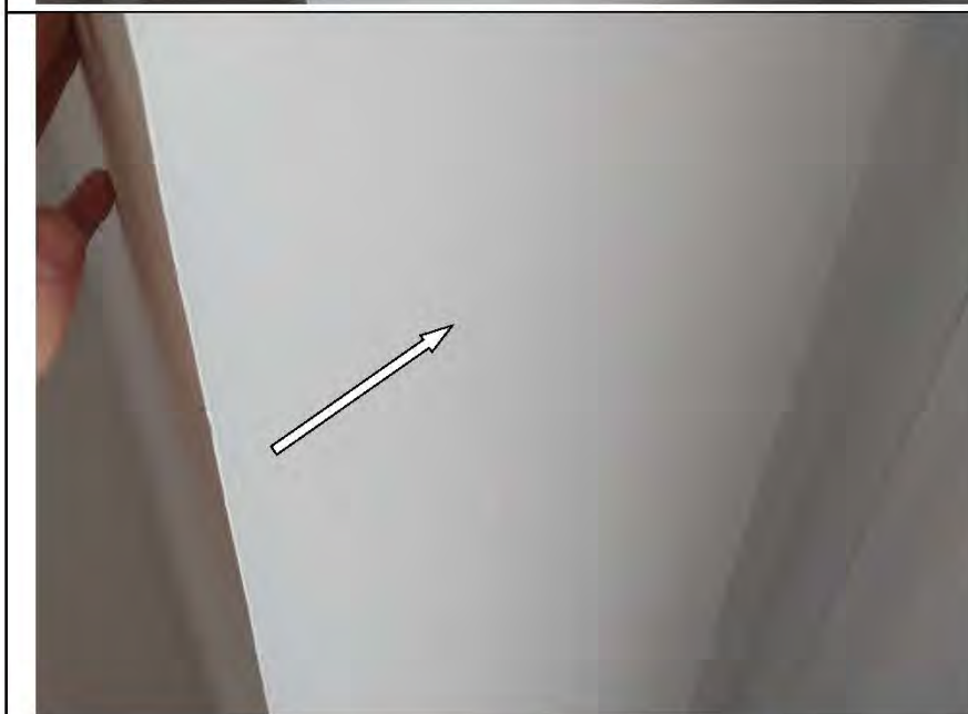
Фото №26. Окрашенные откосы дверного блока ПВХ в кабинете выполнены с дефектами (подтеки).
