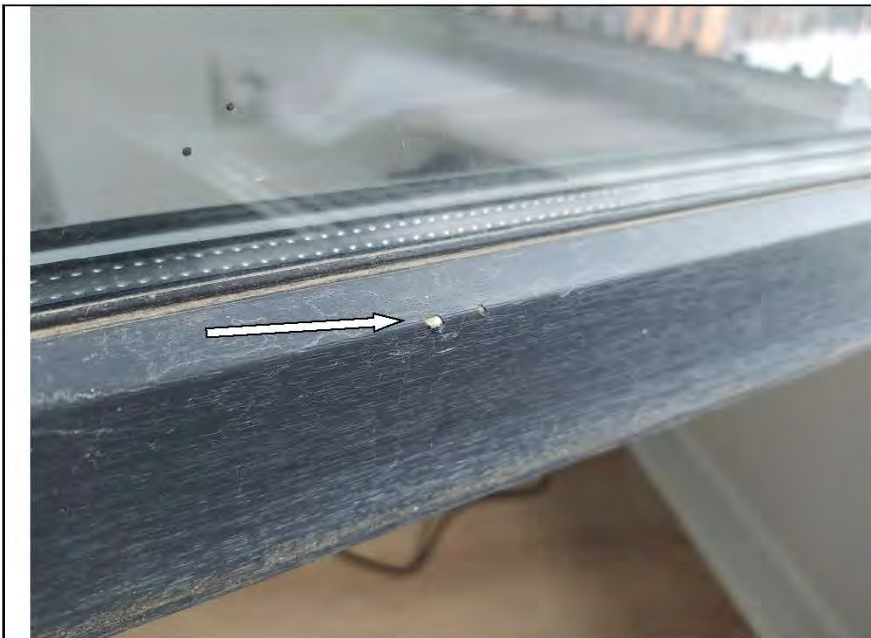
Фото №31. Профиль ПВХ дверного блока в спальне имеет дефекты (скол).
