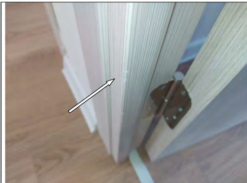
Фото №46. Коробка деревянного дверного блока в спальне имеет дефекты (загрязнение малярными составами).
