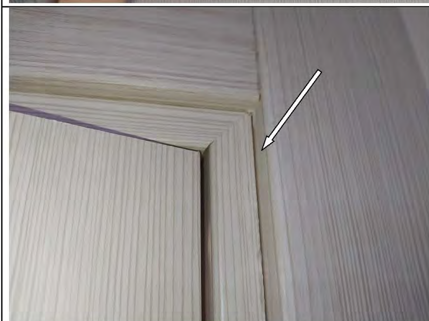
Фото №51. Элементы дверного блока соединены не надежно в кабинете.
