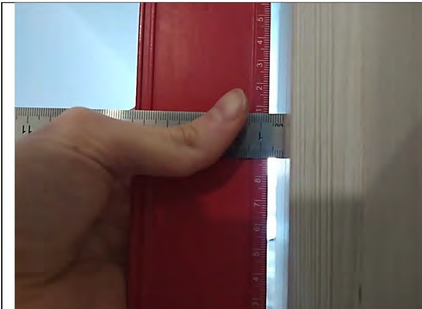
Фото №43. Отклонение коробки дверного блока в кабинете.
