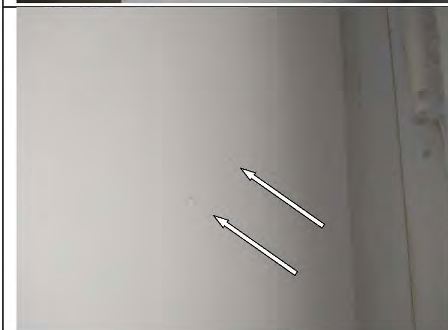
Фото №24. Окрашенные откосы дверного блока ПВХ в спальне выполнены с дефектами (брызги).
