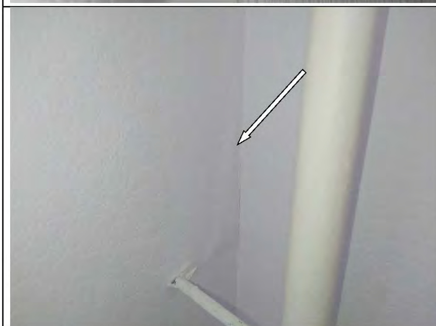
Фото №56. Воздушные пузыри обоев в спальне.
