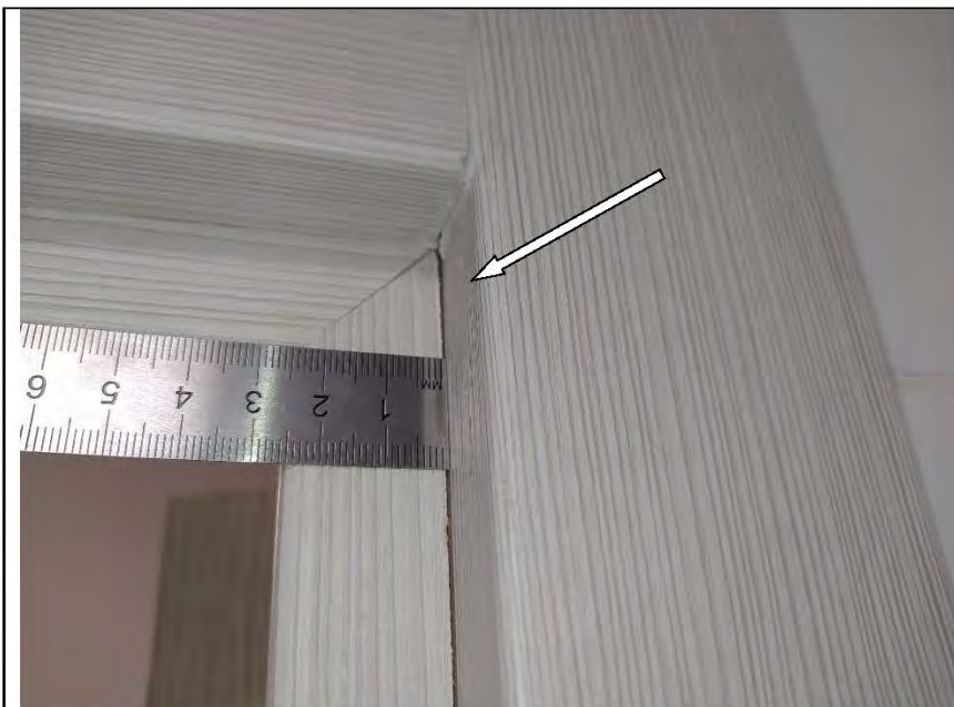
Фото №52. Элементы дверного блока соединены не надежно в санузле.
