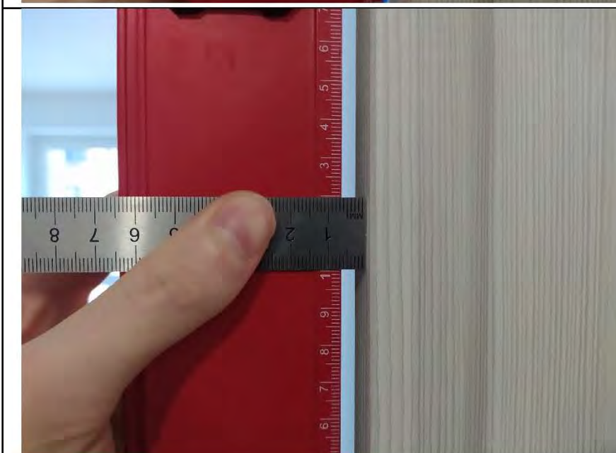
Фото №42. Отклонение коробки дверного блока в гостиной.
