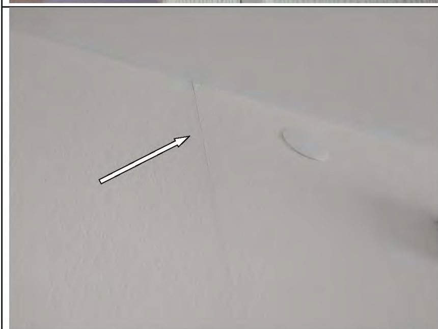
Фото №54. Отслоение швов обоев в кухне.
