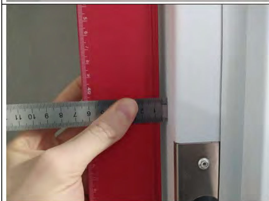
Фото №72. Отклонение коробки входного дверного блока
