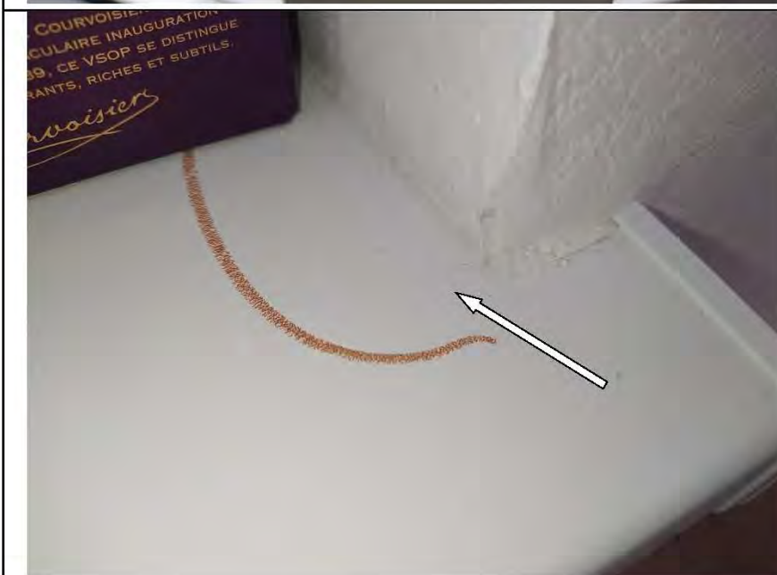
Фото №36. На лицевой поверхности подоконной доски в гостиной имеются дефекты (царапина).
