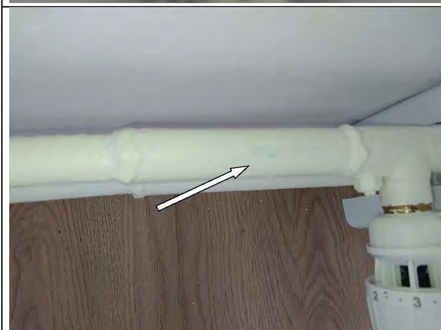
Фото №77. Окрашивание труб отопления выполнено с дефектами в гостиной (пятна)
