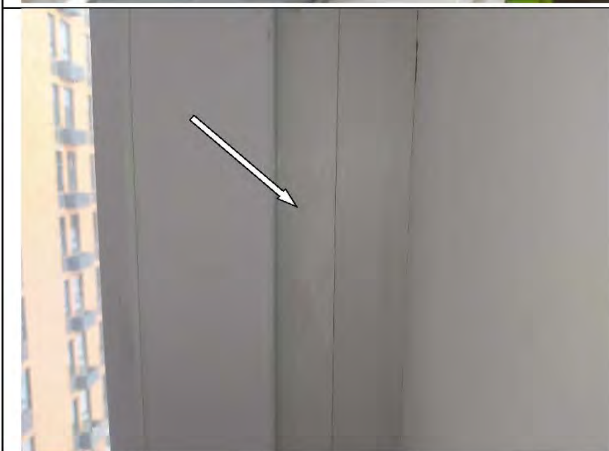
Фото №30. Профиль ПВХ оконного блока в кухне имеет дефекты (загрязнение малярными составами).
