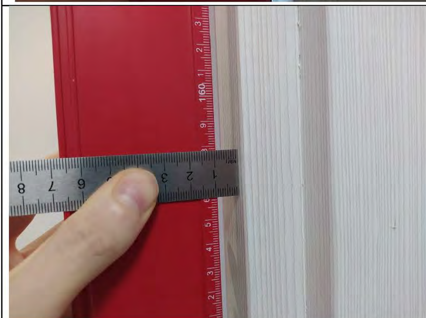
Фото №44. Отклонение коробки дверного блока в санузле.
