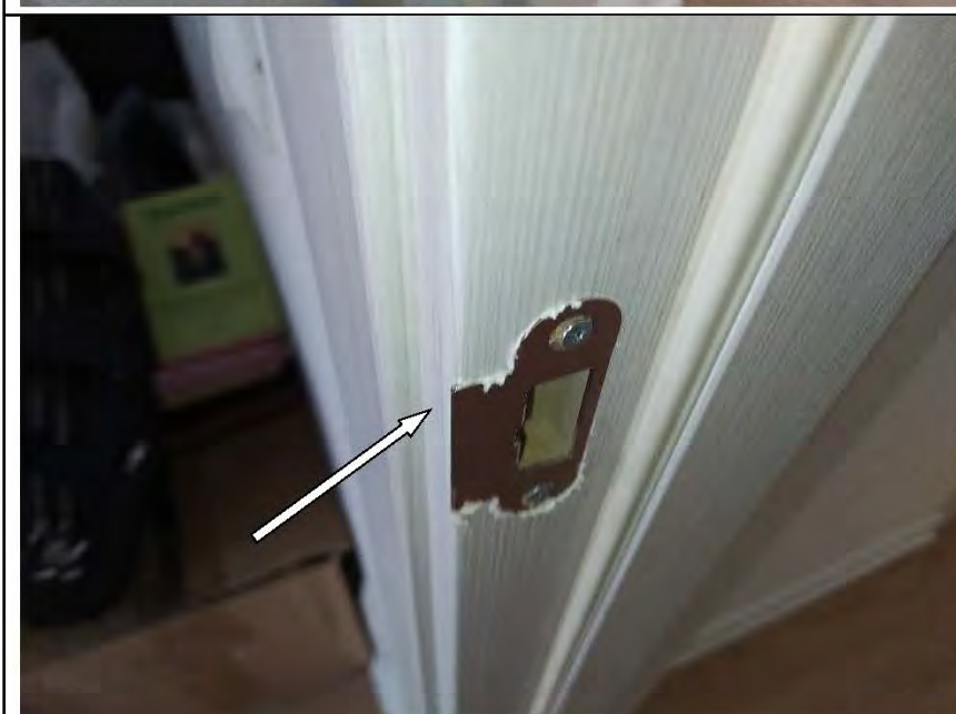
Фото №48. Коробка деревянного дверного блока в кабинете имеет дефекты (задиры).
