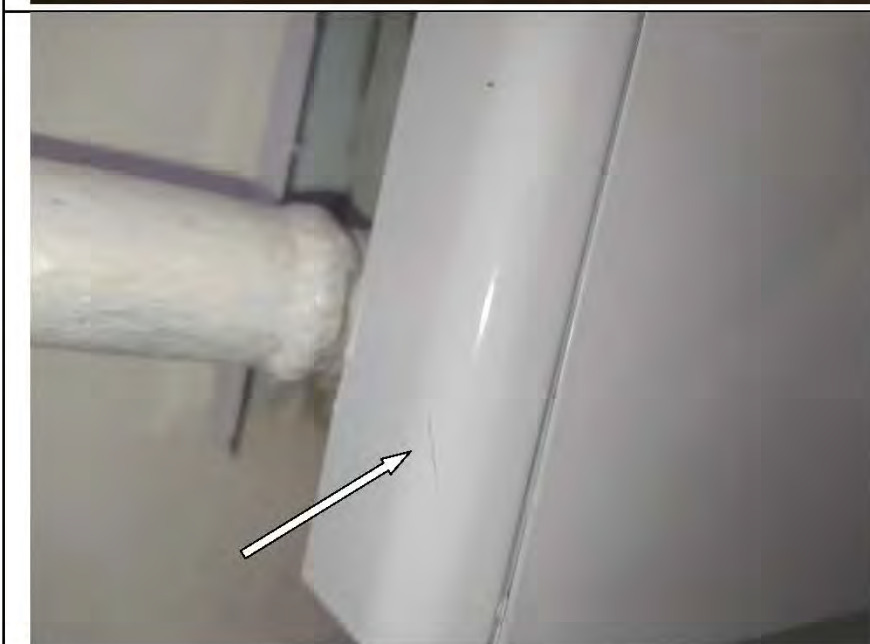
Фото №39. Отопительный прибор имеет дефект покраски защитного кожуха в гостиной (царапины).
