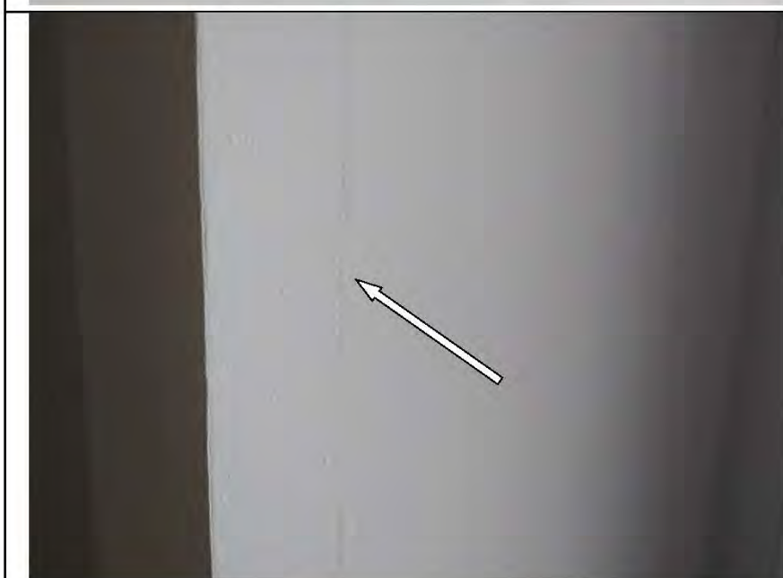
Фото №23. Окрашенные откосы оконного блока ПВХ в кухне выполнены с дефектами (следы от инструмента).
