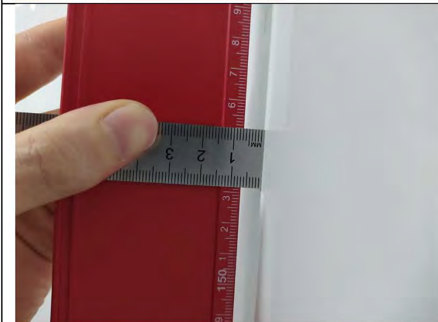
Фото №14. Измерения уровня стен в ванной комнате.
