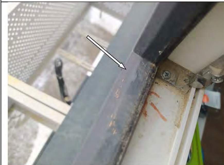
Фото №29. Профиль ПВХ оконного блока в кухне имеет дефекты (скол).
