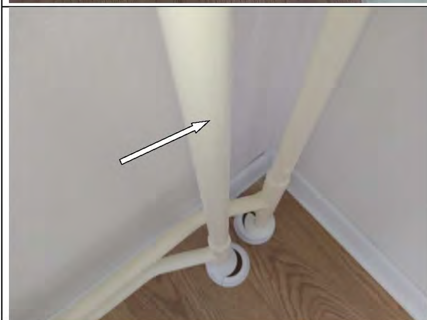
Фото №78. Окрашивание труб отопления выполнено с дефектами в кабинете (подтеки).
