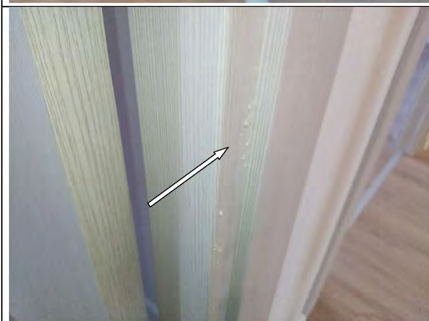
Фото №47. Коробка деревянного дверного блока в гостиной имеет дефекты (загрязнение монтажной пенной).
