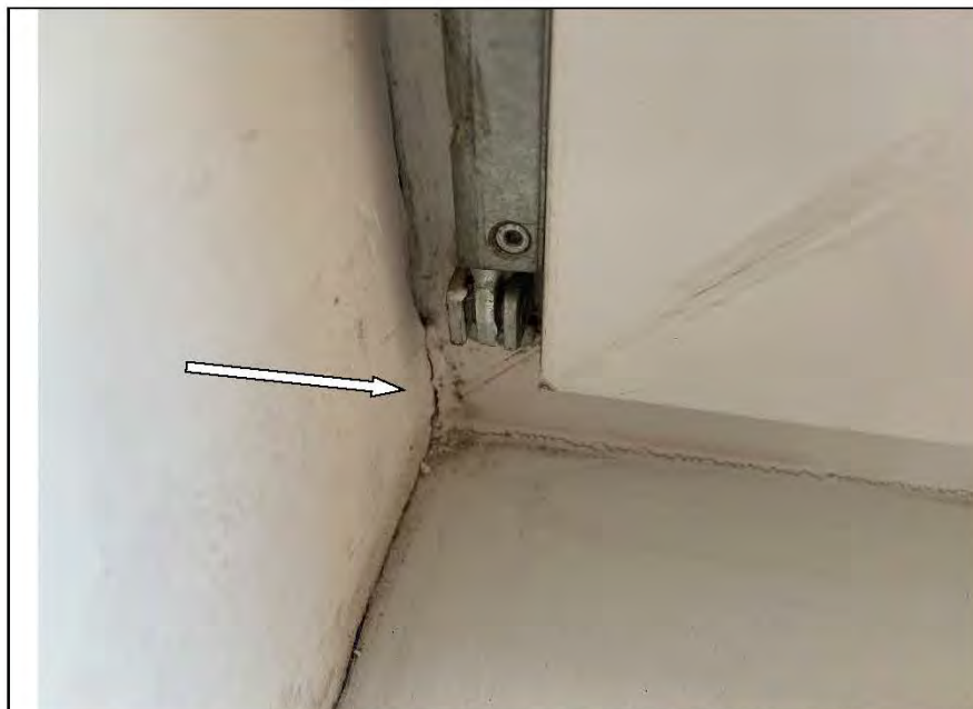
Фото №43. Инфильтрация воздуха и влаги и неровности, трещины, сколы на откосах оконного блока ПВХ в детской.
