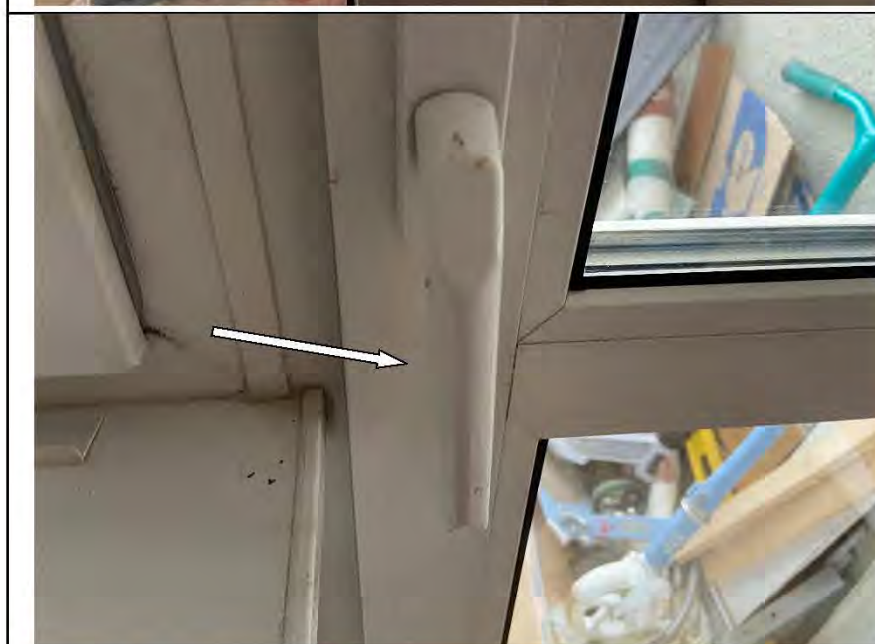
Фото №17. Не отрегулирована фурнитура оконного блока ПВХ в кухне.
