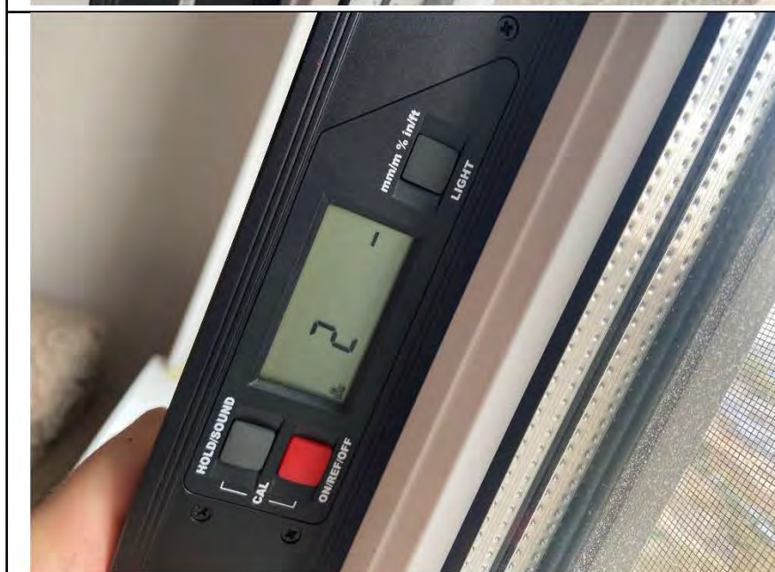
Фото №45. Отклонение от вертикали оконного блока ПВХ в кухне.
