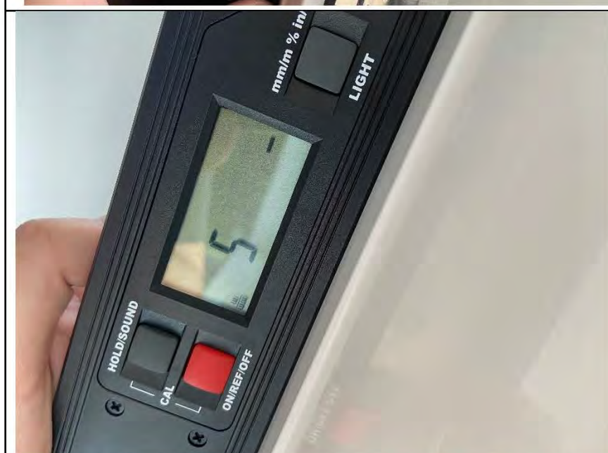
Фото №47. Отклонение от вертикали оконного блока ПВХ в детской.
