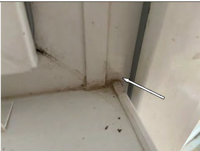
Фото №26. Дефект на профиле оконного блока ПВХ в кухне.
