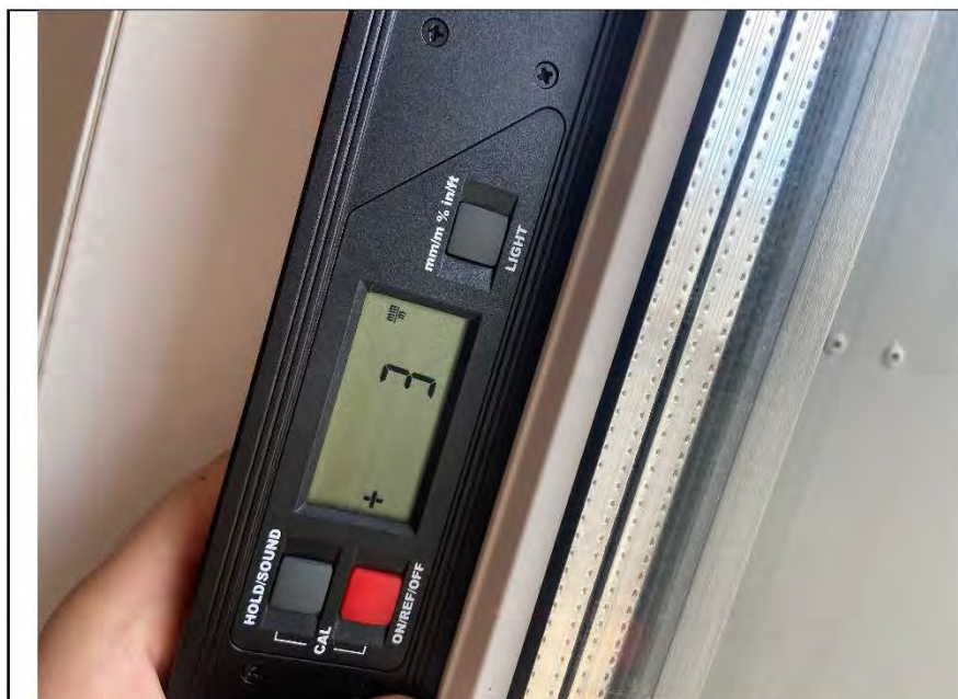
Фото №46. Отклонение от вертикали оконного блока ПВХ в спальне.
