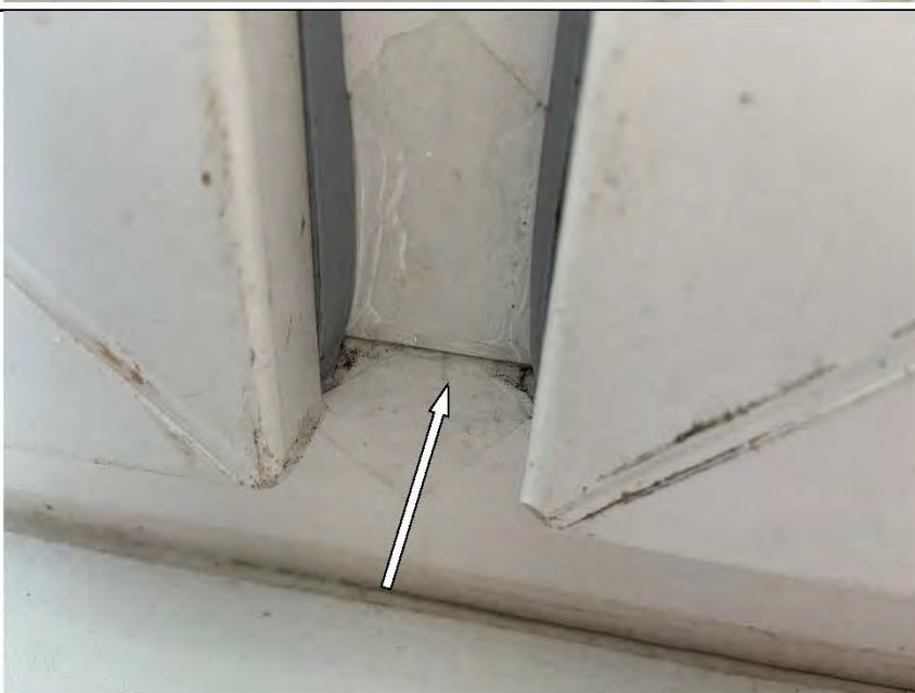
Фото №27. Дефект на профиле оконного блока ПВХ в кухне.
