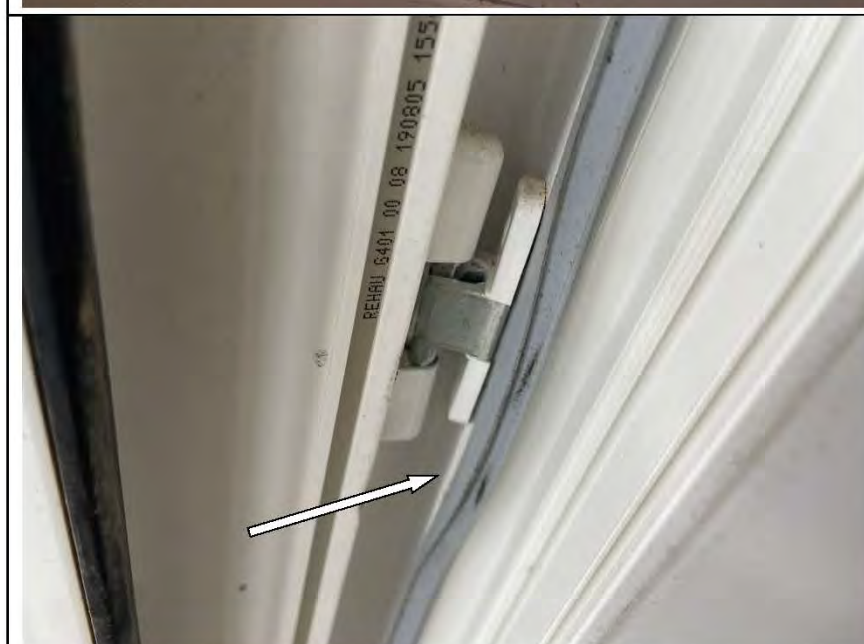
Фото №53. Дефект на уплотнительной ленте оконного блока ПВХ в кухне.
