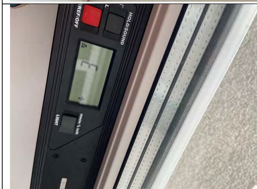
Фото №44. Отклонение от вертикали оконного блока ПВХ в кухне.
