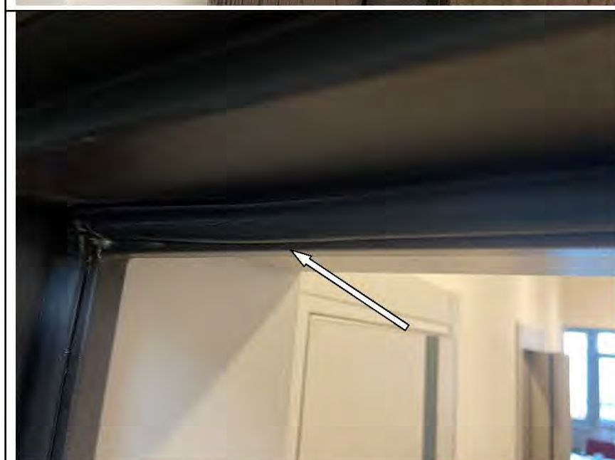
Фото №65. Дефект на уплотнительной противопожарной ленте входного дверного блока в коридоре.
