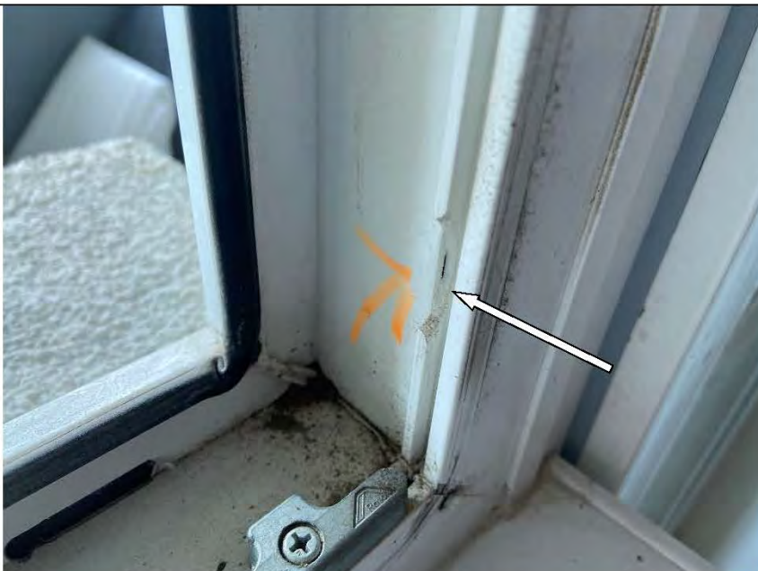
Фото №25. Дефект на профиле оконного блока ПВХ в кухне.
