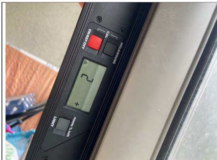
Фото №49. Отклонение от вертикали алюминиевого оконного блока на лоджии.
