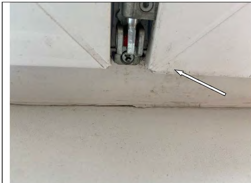
Фото №28. Дефект на профиле оконного блока ПВХ в спальне.
