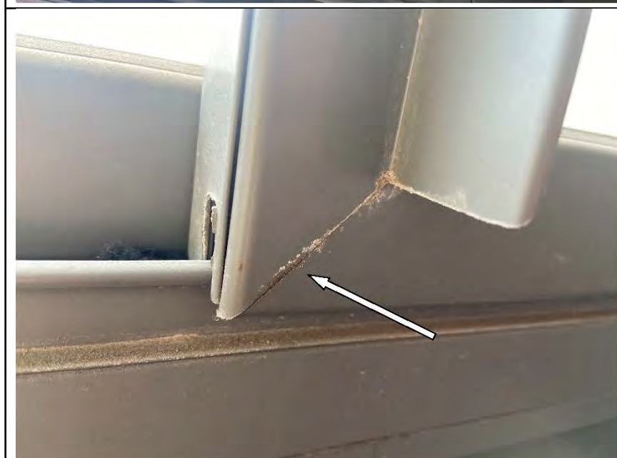
Фото №51. Дефект на алюминиевом профиле оконного блока на лоджии.
