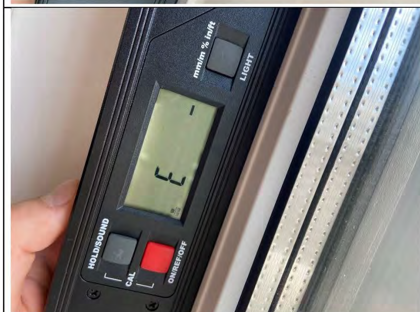
Фото №48. Отклонение от вертикали оконного блока ПВХ в детской.
