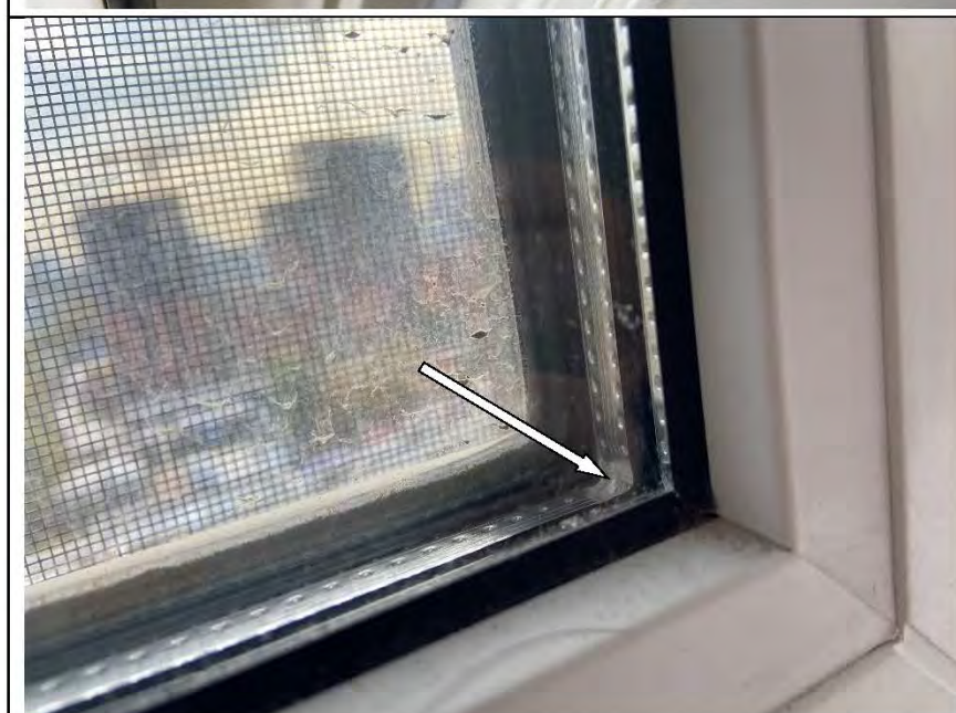
Фото №54. Дефект на уплотнительной ленте оконного блока ПВХ в кухне.
