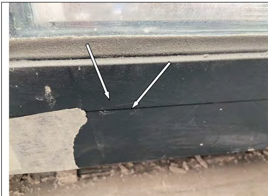
Фото №31. Дефекты на металлическом профиле оконного блока в квартире.
