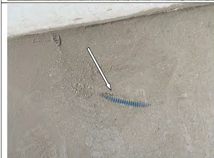
Фото №26. Неровности, выбоины, трещины на цементно- песчаной стяжке в квартире.
