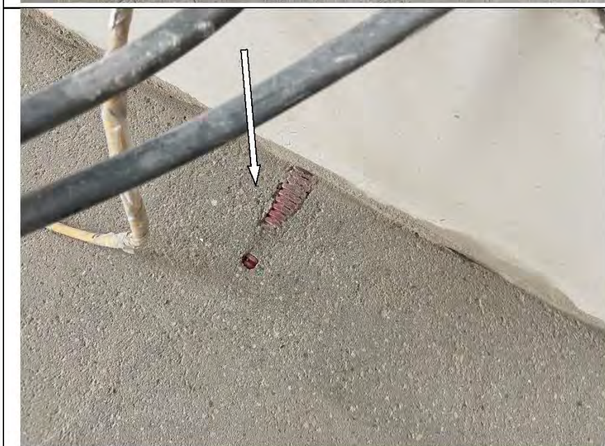
Фото №27. Неровности, выбоины, трещины на цементно- песчаной стяжке в квартире.
