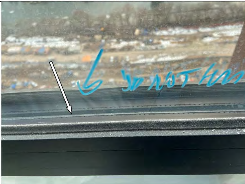
Фото №42. Дефект установки части уплотняющей прокладки на оконном блоке в квартире.
