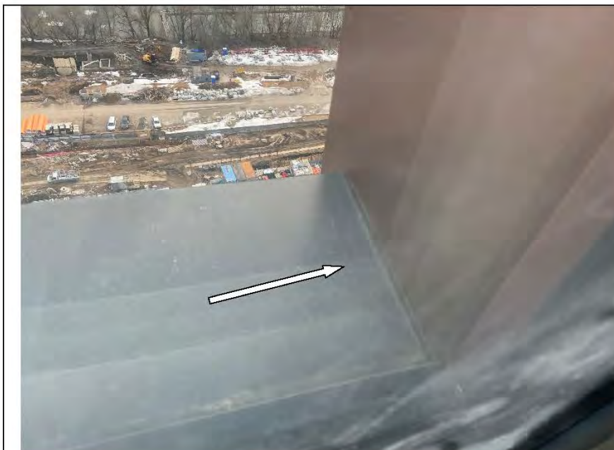
Фото №64. Дефекты на металлическом отливке оконного блока в квартире.
