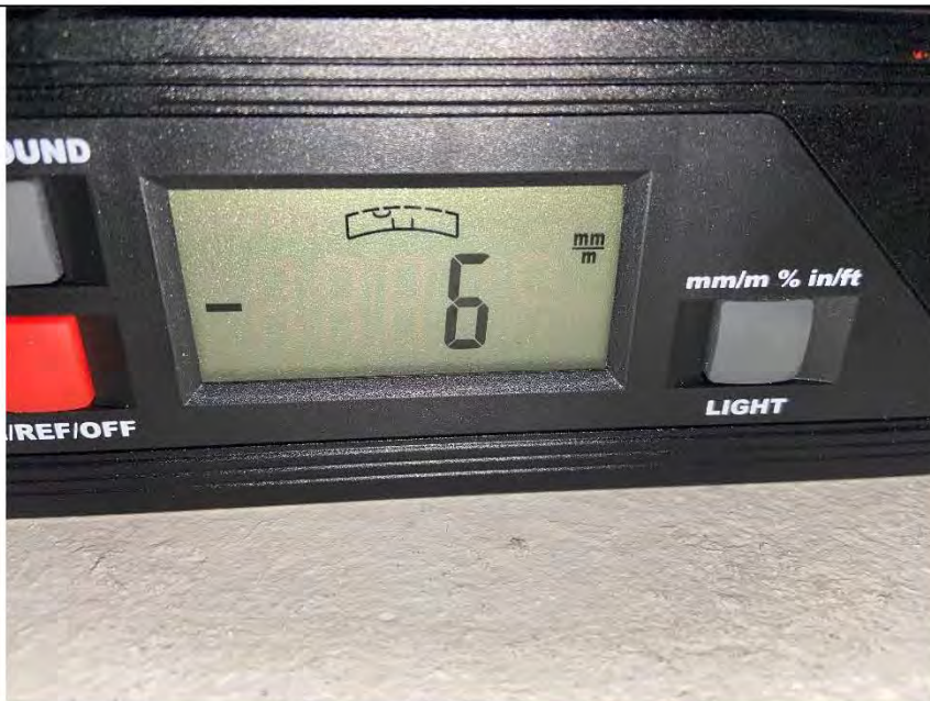
Фото №76. Отклонения поверхности напольного покрытия от плоскости в квартире.
