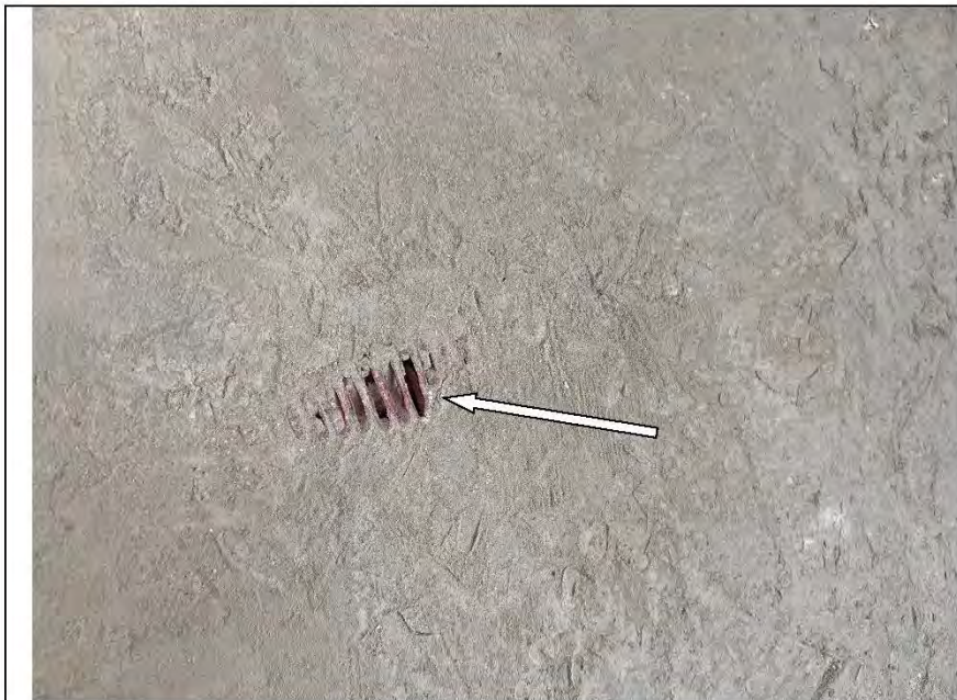
Фото №25. Неровности, выбоины, трещины на цементно- песчаной стяжке в квартире.
