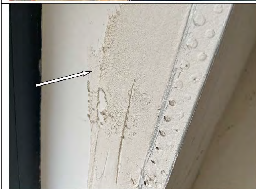
Фото №59. Неровности, сколы на откосах оконного блока в квартире.
