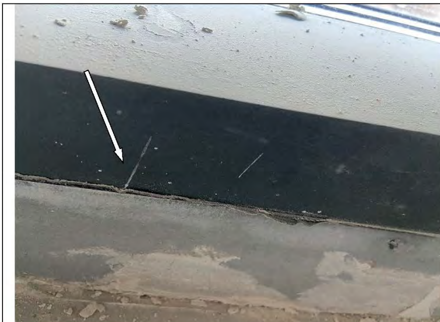
Фото №34. Дефекты на металлическом профиле оконного блока в квартире.
