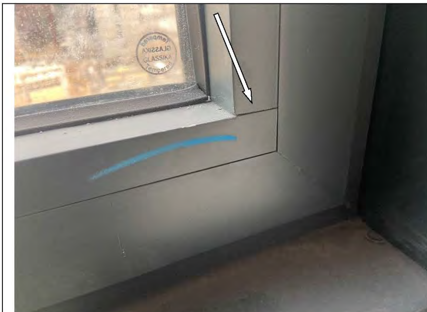
Фото №37. Дефекты на металлическом профиле оконного блока в квартире.
