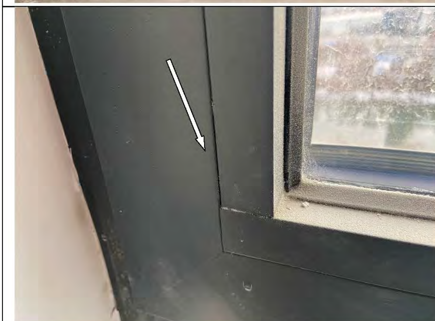
Фото №32. Дефекты на металлическом профиле оконного блока в квартире.
