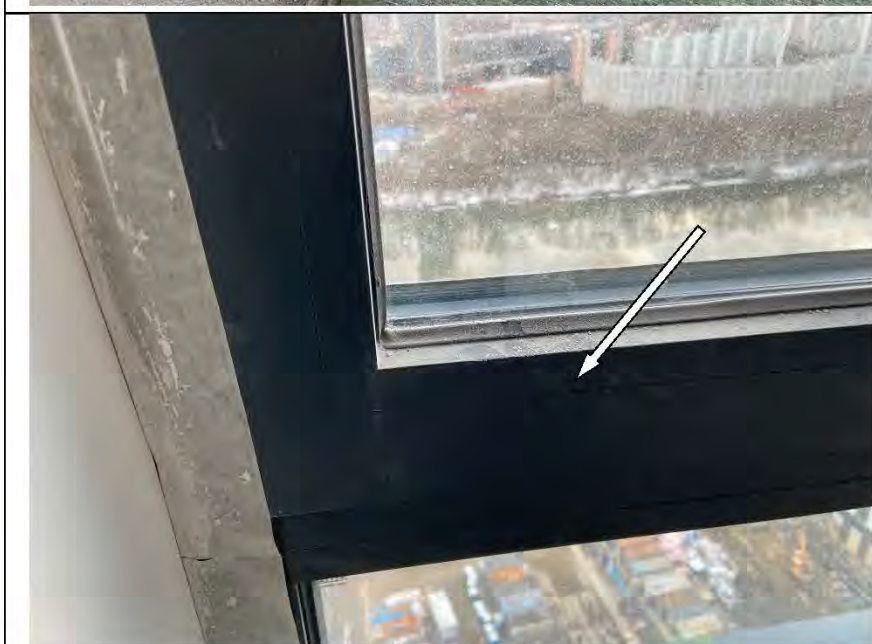
Фото №29. Дефекты на металлическом профиле оконного блока в квартире.
