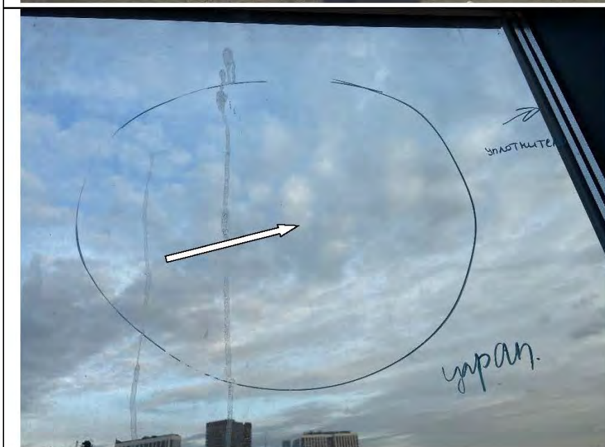
Фото №51. Дефекты на стеклопакете оконного блока в квартире.
