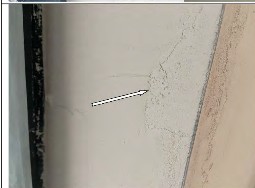
Фото №62. Неровности, сколы на откосах оконного блока в квартире.
