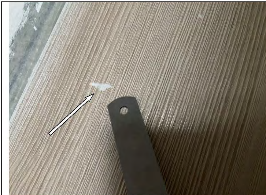
Фото №19. Загрязнения на наличниках входного дверного блока в квартире.
