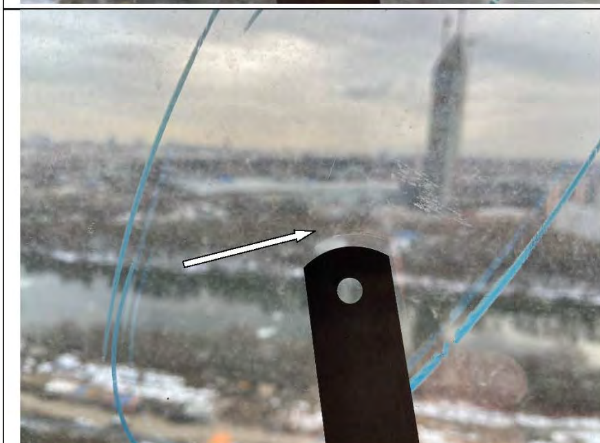
Фото №44. Дефекты на стеклопакете оконного блока в квартире.
