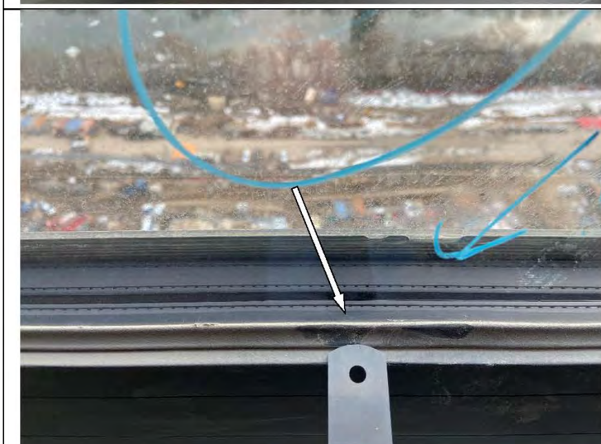
Фото №38. Дефект установки части уплотняющей прокладки на оконном блоке в квартире.
