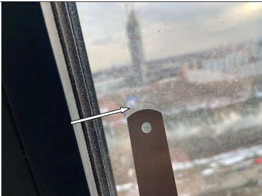
Фото №46. Дефекты на стеклопакете оконного блока в квартире.
