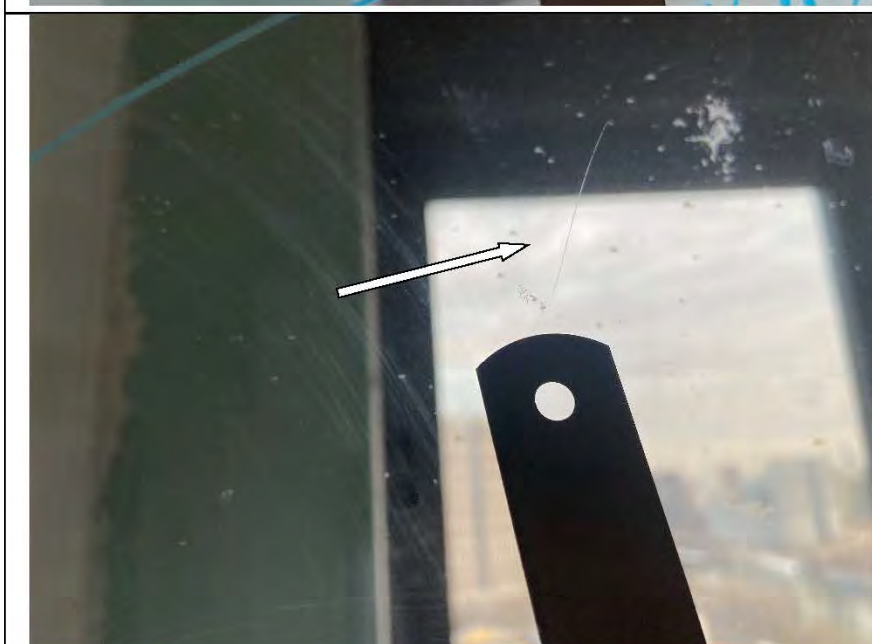
Фото №53. Дефекты на стеклопакете оконного блока в квартире.
