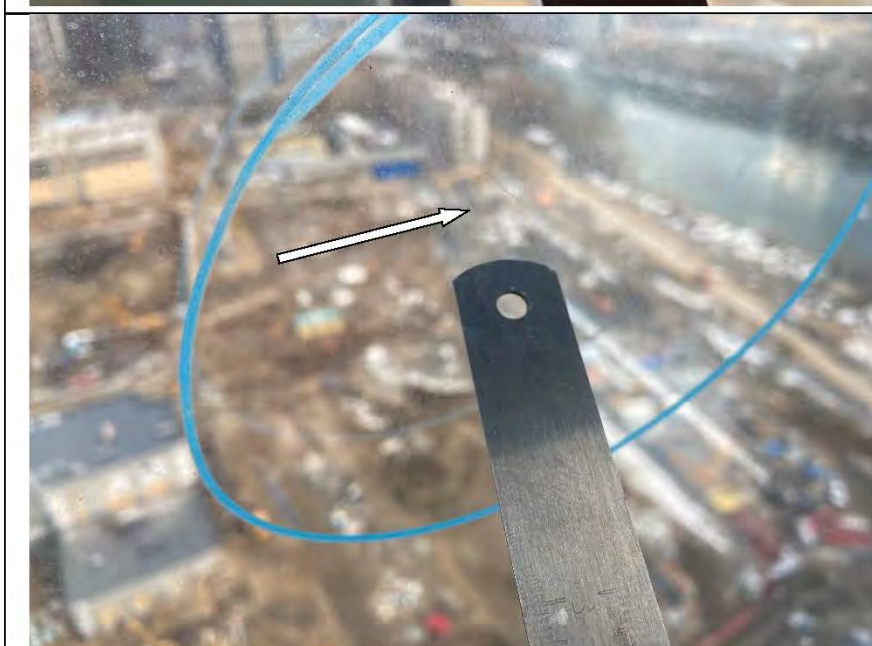
Фото №54. Дефекты на стеклопакете оконного блока в квартире.
