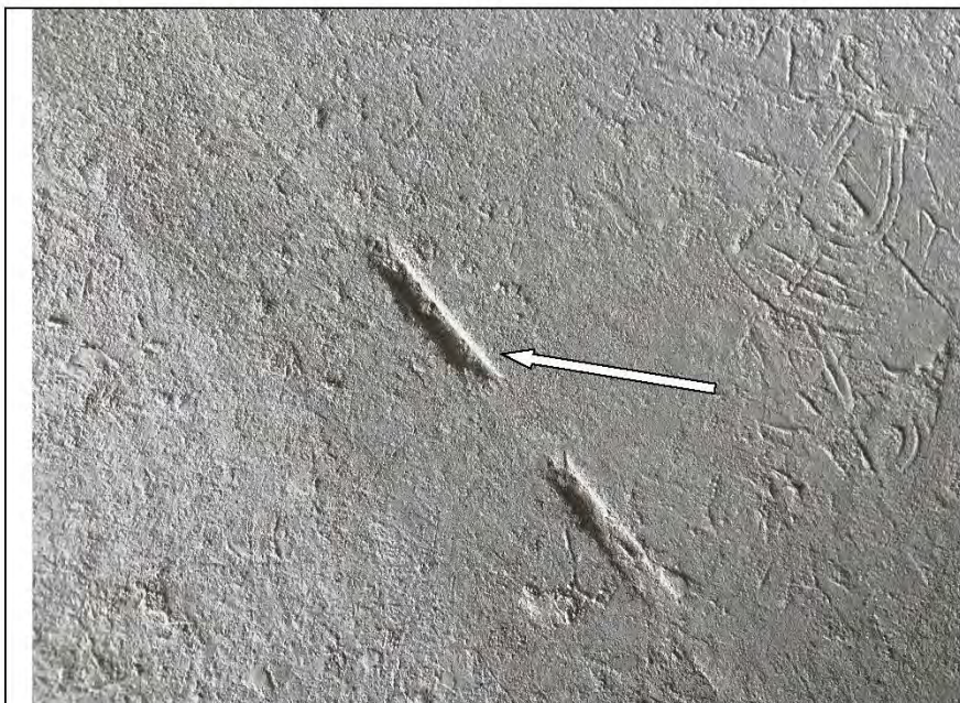
Фото №22. Неровности, выбоины, трещины на цементно- песчаной стяжке в квартире.
