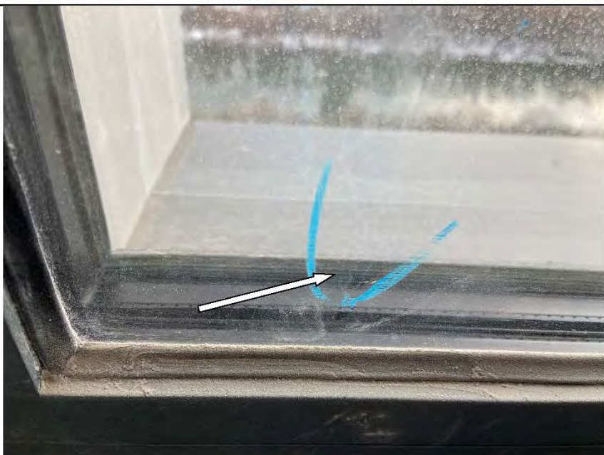
Фото №47. Дефекты на стеклопакете оконного блока в квартире.
