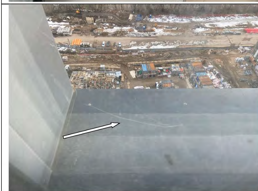
Фото №63. Дефекты на металлическом отливе оконного блока в квартире.
