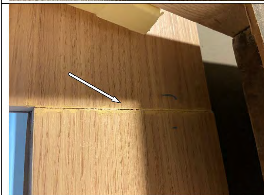
Фото №20. Загрязнения на наличниках входного дверного блока в квартире.
