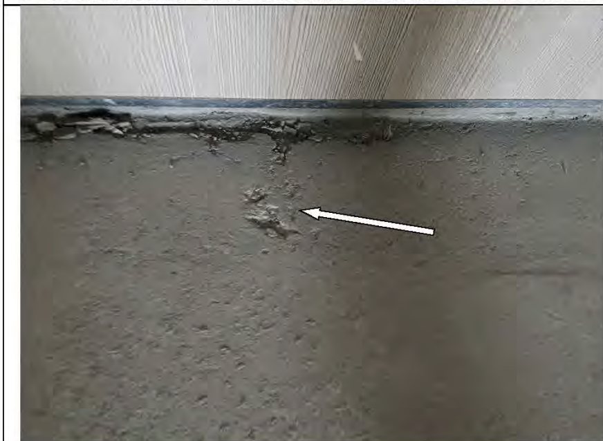
Фото №23. Неровности, выбоины, трещины на цементно- песчаной стяжке в квартире.
