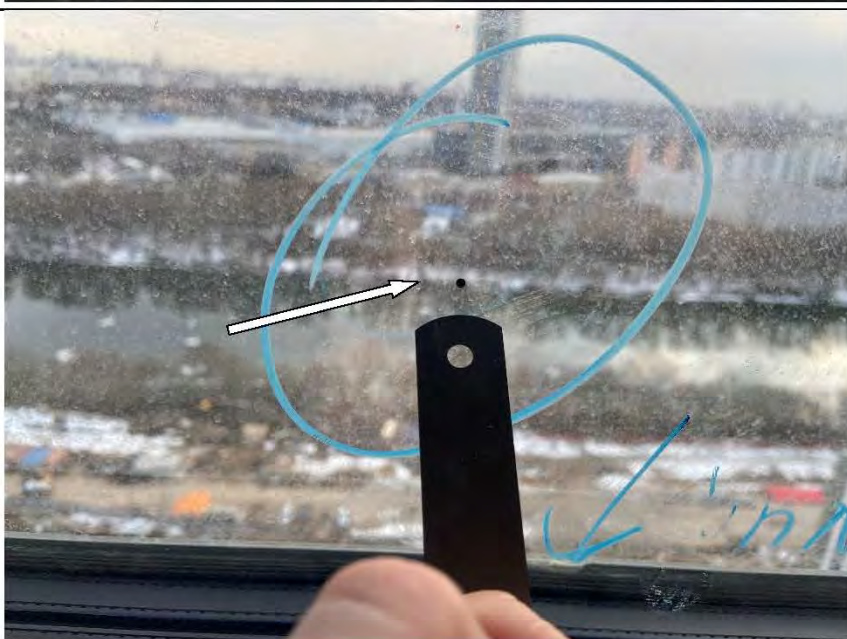
Фото №48. Дефекты на стеклопакете оконного блока в квартире.
