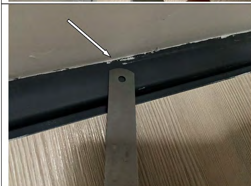
Фото №17. Загрязнения на коробке входного дверного блока в квартире.
