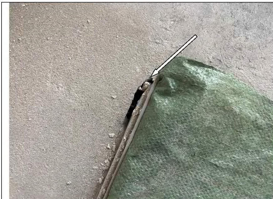
Фото №28. Неровности, выбоины, трещины на цементно- песчаной стяжке в квартире.
