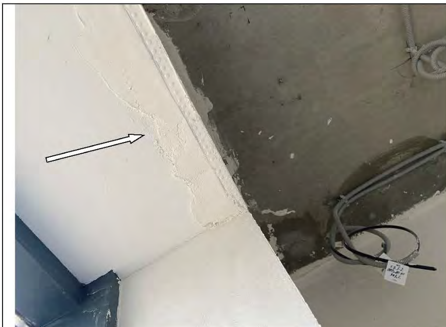
Фото №61. Неровности, сколы на откосах оконного блока в квартире.
