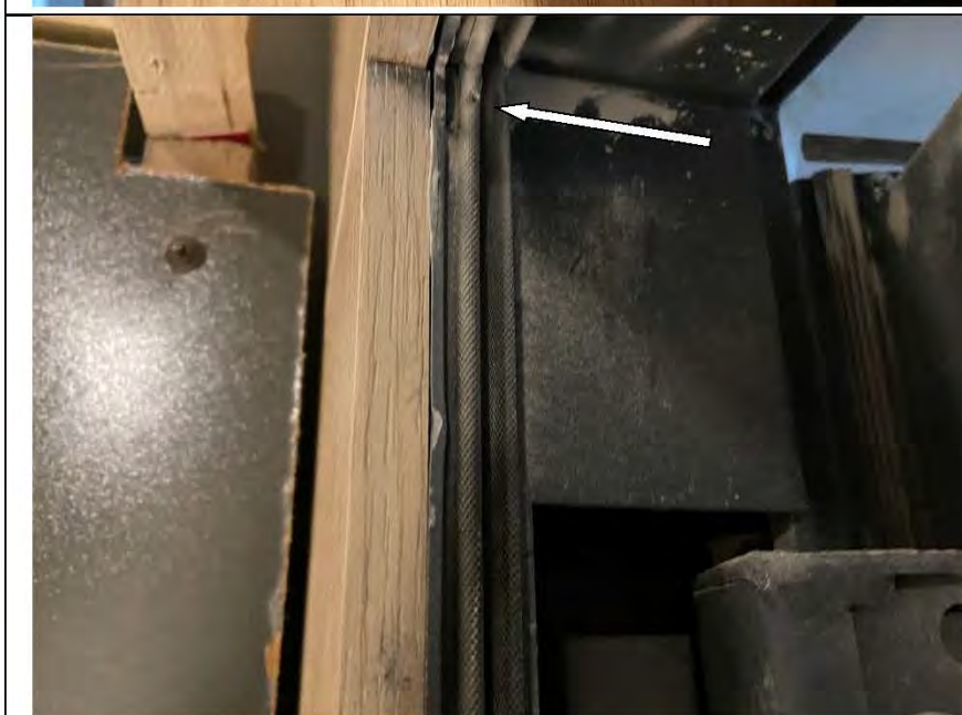
Фото №21. Дефект на противоположной уплотняющей ленте на блоке входной двери в квартире.
