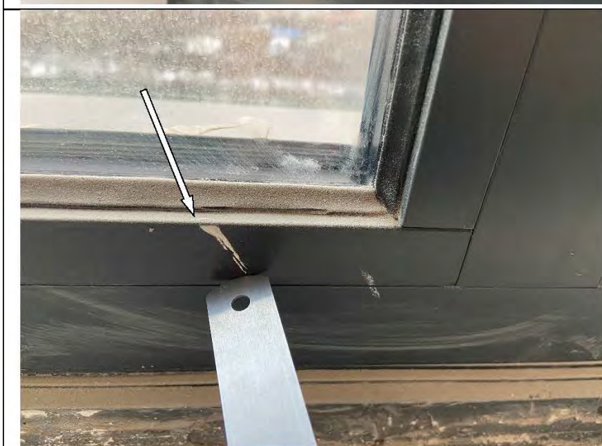
Фото №33. Дефекты на металлическом профиле оконного блока в квартире.
