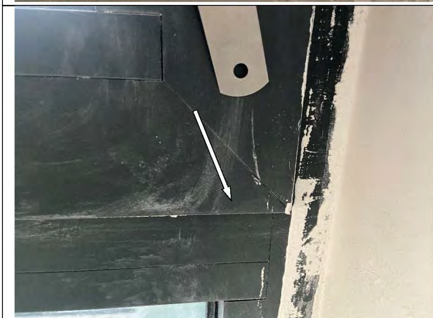
Фото №35. Дефекты на металлическом профиле оконного блока в квартире.
