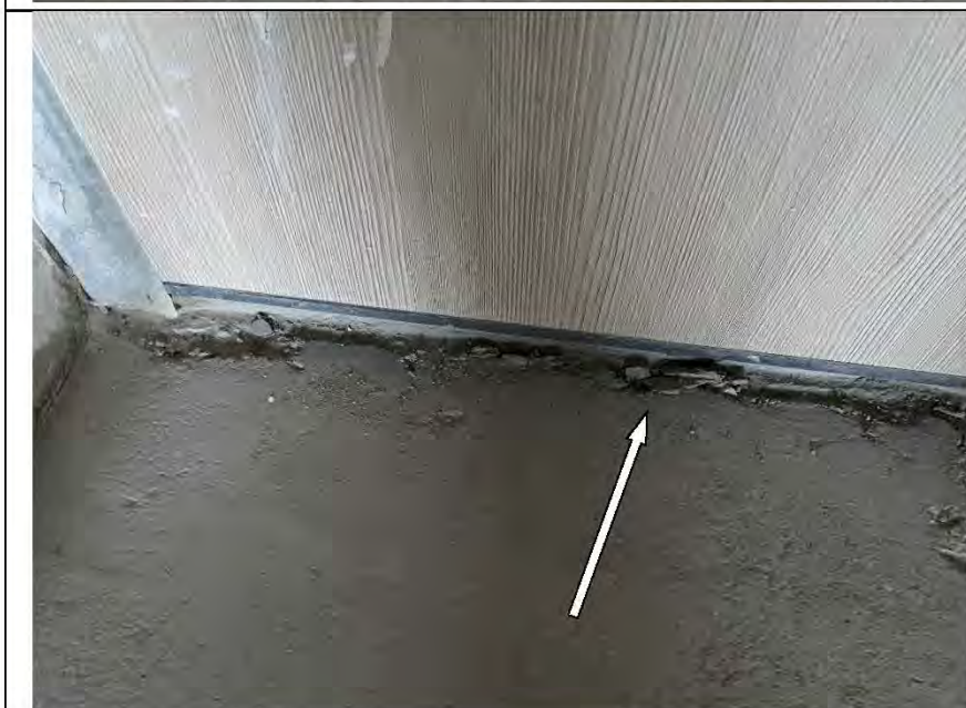
Фото №24. Неровности, выбоины, трещины на цементно- песчаной стяжке в квартире.
