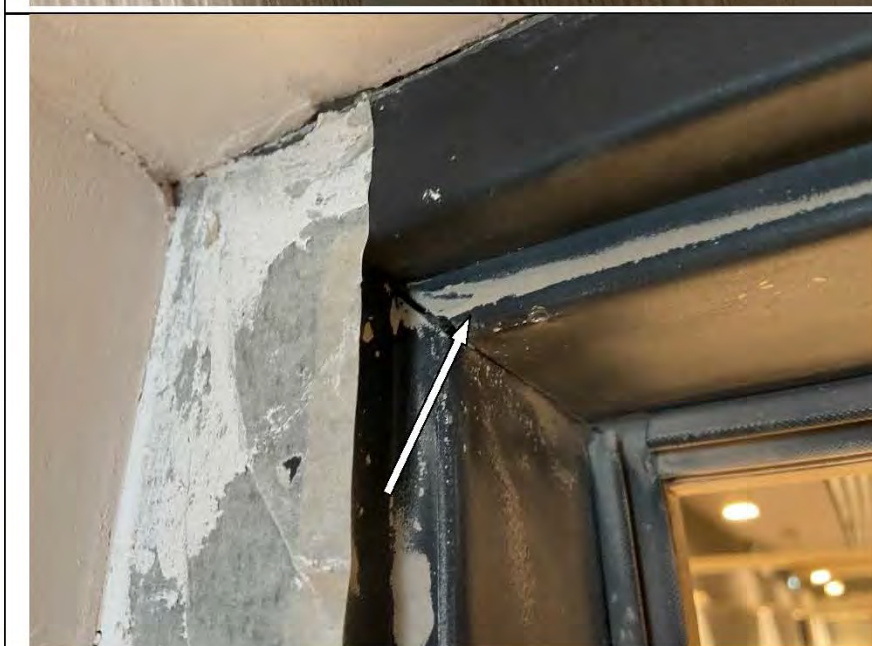
Фото №18. Загрязнения на коробке входного дверного блока в квартире.
