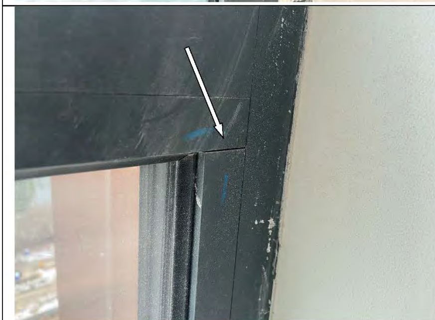
Фото №36. Дефекты на металлическом профиле оконного блока в квартире.
