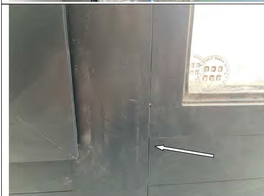
Фото №30. Дефекты на металлическом профиле оконного блока в квартире.
