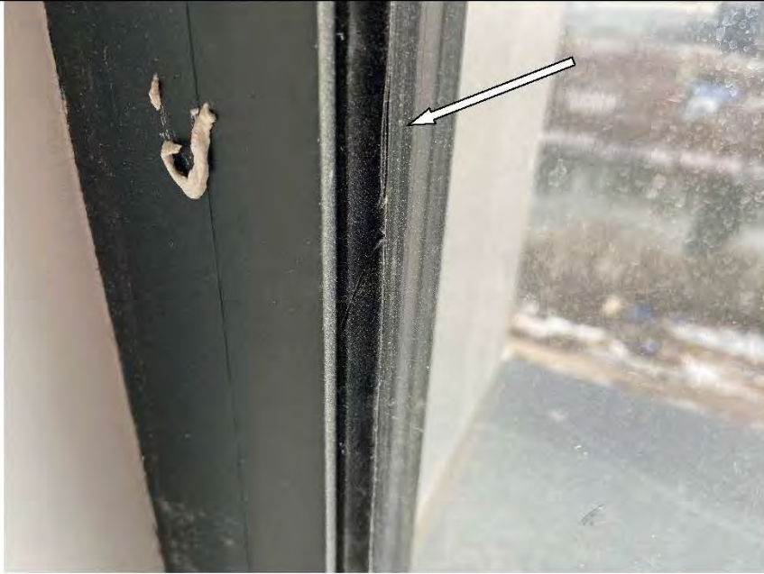
Фото №40. Дефект установки части уплотняющей прокладки на оконном блоке в квартире.
