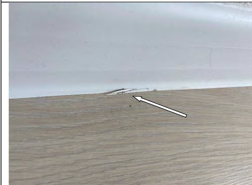
Фото №29. Дефект на напольном плинтусе ПВХ в кухне.
