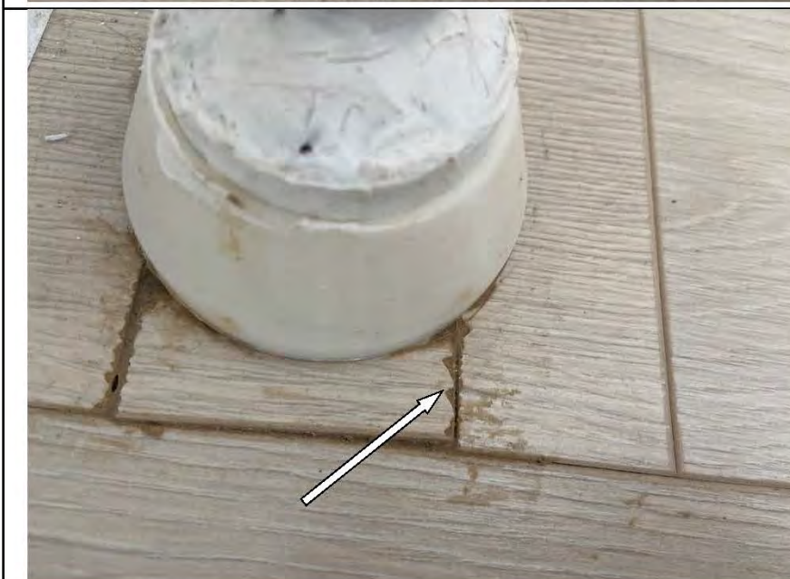
Фото №24. Сколы на поверхности ламината в кухне.
