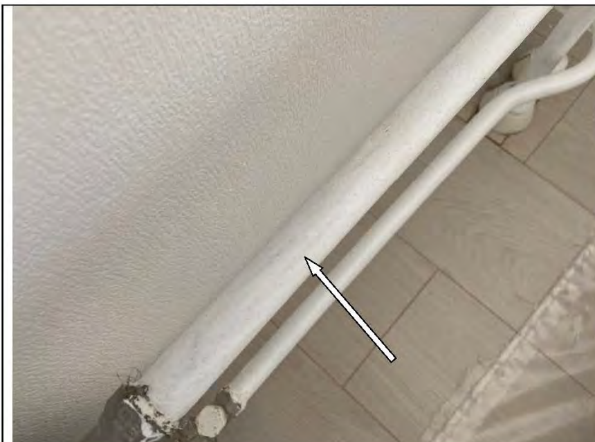
Фото №64. Неровности, подтеки на окрашенных трубах отопления в кухне.
