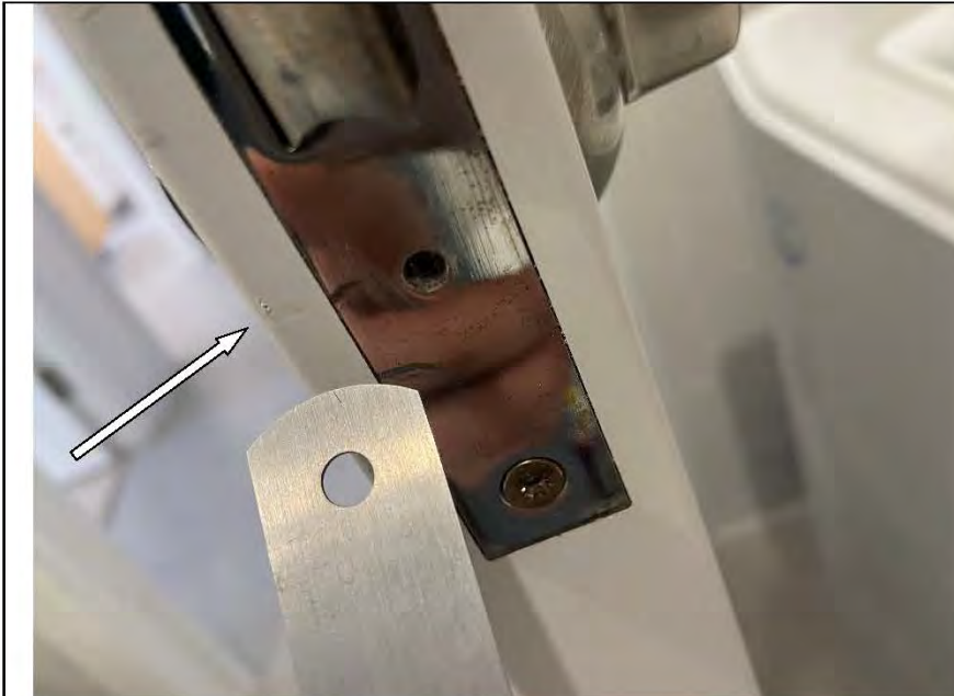
Фото №37. Царапина на полотне деревянного дверного блока в ванной комнате.
