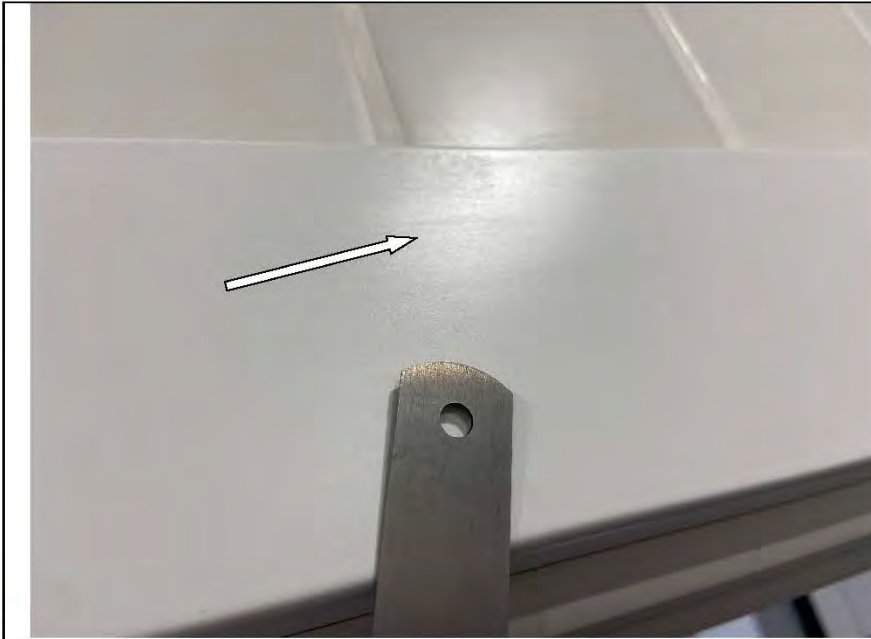
Фото №43. Дефект на наличнике деревянного дверного блока в ванной комнате.
