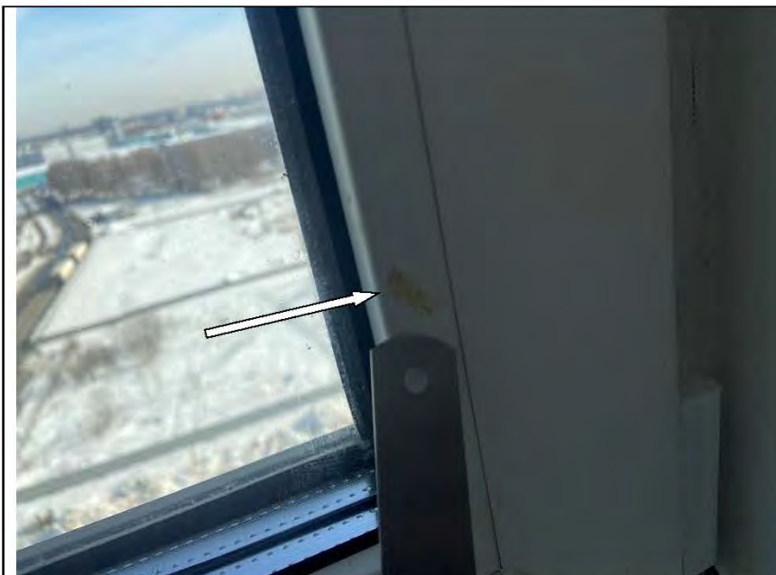
Фото №52. Загрязнения на профиле оконного блока ПВХ в кухне.
