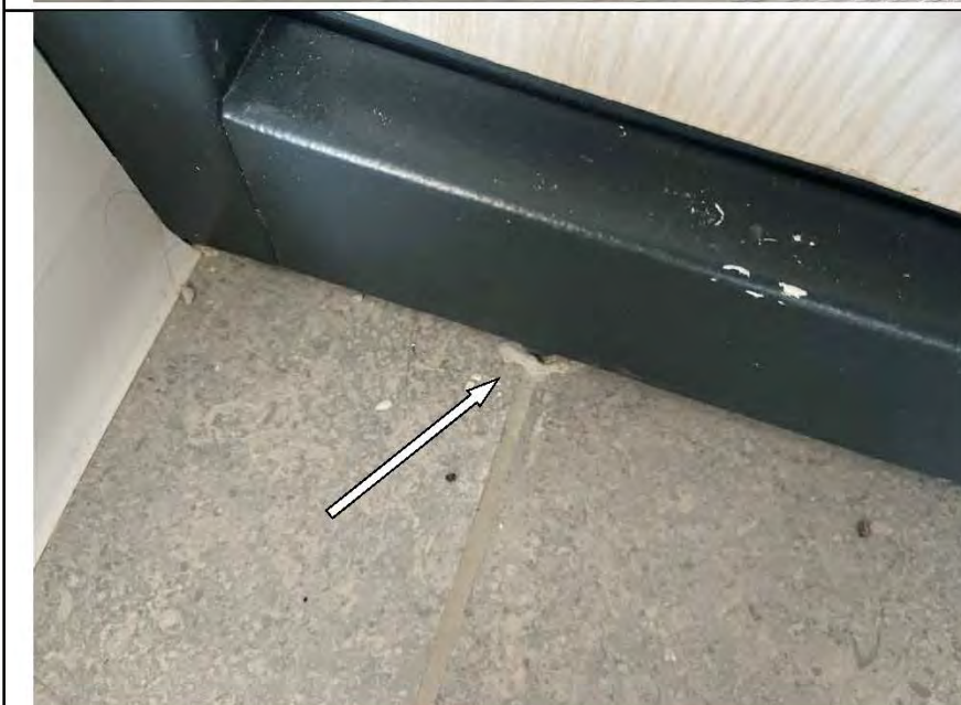
Фото №30. Скол на напольной керамической плитке в коридоре.
