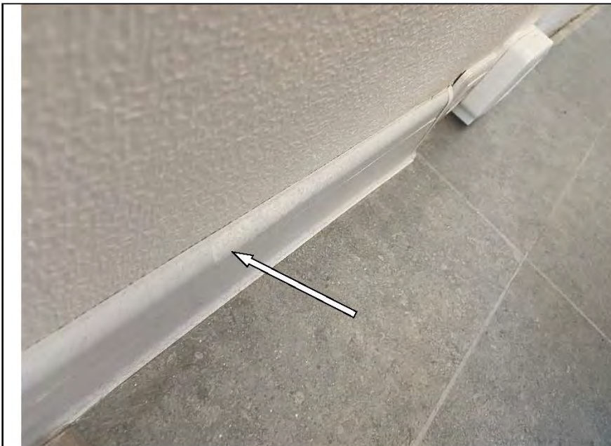
Фото №28. Дефект на напольном плинтусе ПВХ в кухне.
