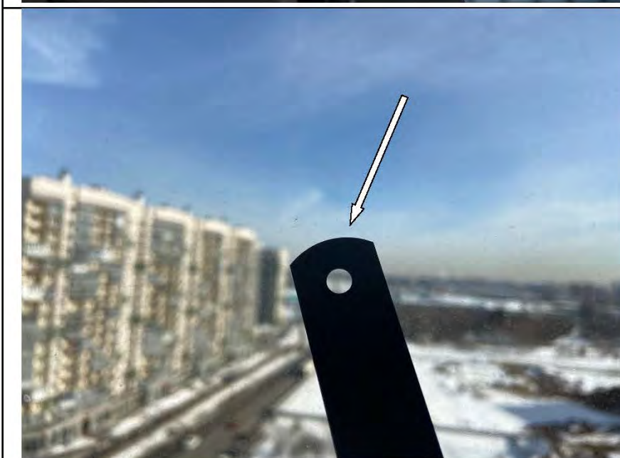
Фото №47. Царапина на стеклопакете алюмелевого оконного блока на лоджии.
