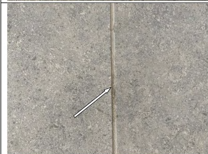
Фото №21. Неровные швы напольной керамической плитки в кухне.
