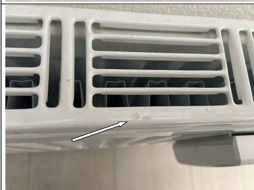
Фото №62. Дефект на металлическом кожухе отопительного прибора в спальне.
