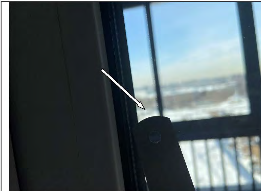
Фото №46. Царапина на стеклопакете оконного блока ПВХ в спальне.
