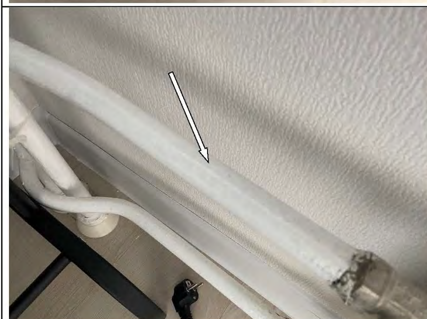
Фото №63. Неровности, подтеки на окрашенных трубах отопления в спальне.
