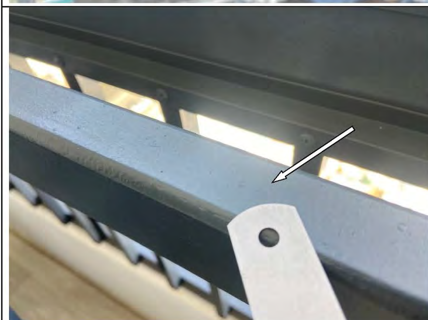
Фото №69. Царапины на металлическом ограждении на лоджии.
