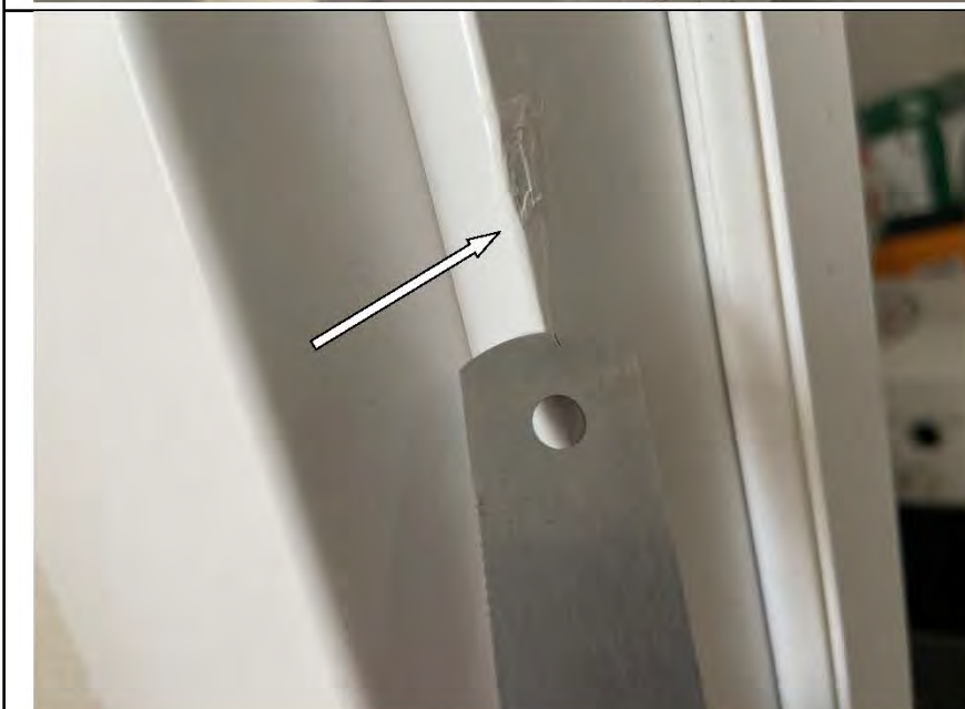
Фото №39. Дефект на коробке деревянного дверного блока в кухне.
