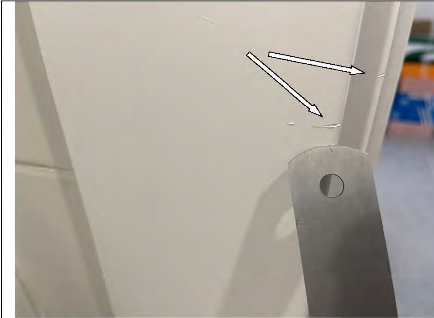
Фото №40. Дефект на коробке и наличнике деревянного дверного блока в ванной комнате.
