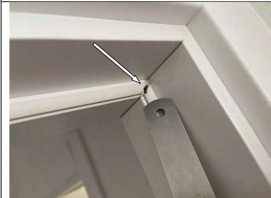
Фото №38. Дефект на коробке деревянного дверного блока в спальне.
