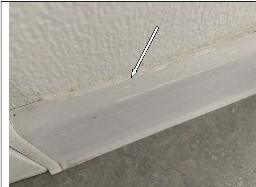
Фото №25. Дефект на напольном плинтусе ПВХ в коридоре.
