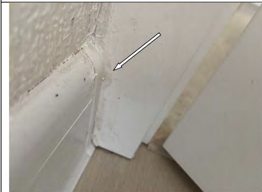
Фото №41. Дефект на наличнике деревянного дверного блока в спальне.
