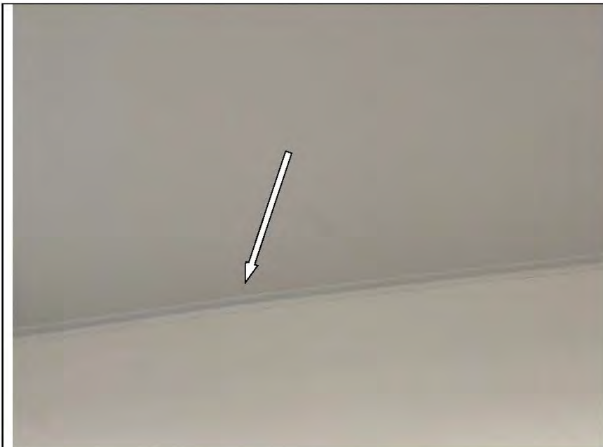
Фото №58. Загрязнения на полотне натяжного потолка в коридоре.
