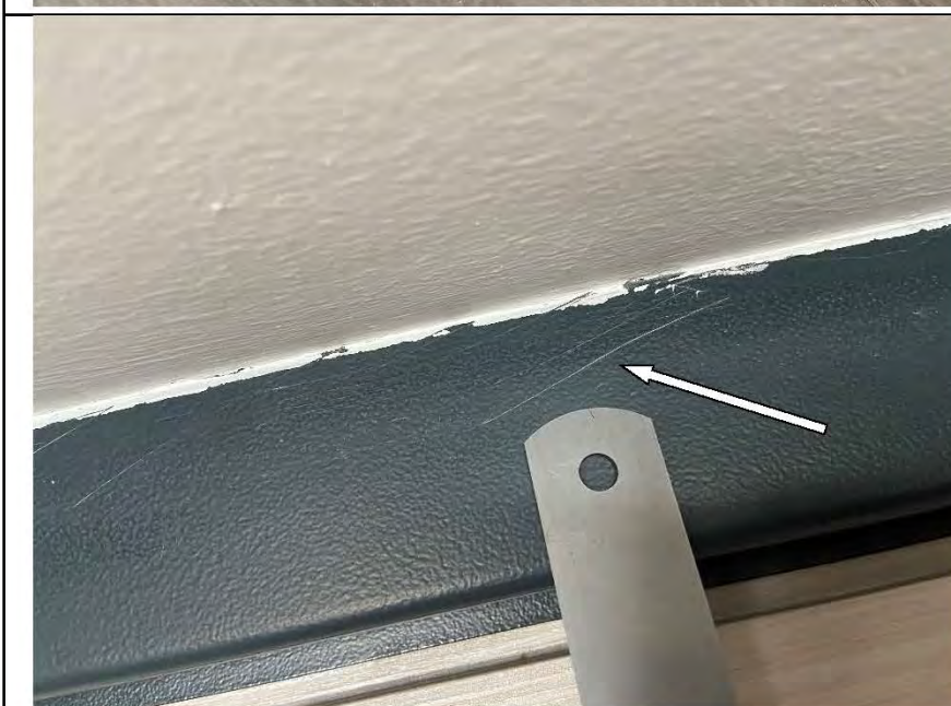
Фото №33. Царапина на коробке входного дверного блока в коридоре.
