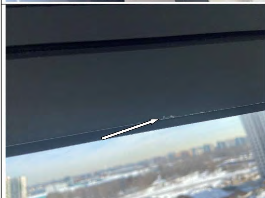
Фото №68. Загрязнения на алюминиевом профиле оконного блока на лоджии.
