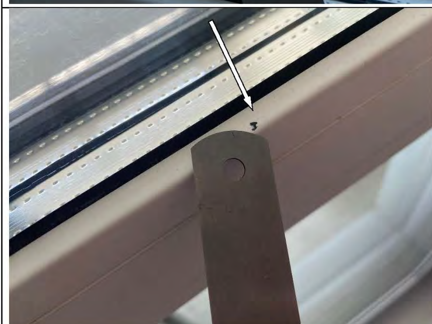
Фото №50. Загрязнения на профиле оконного блока ПВХ в спальне.
