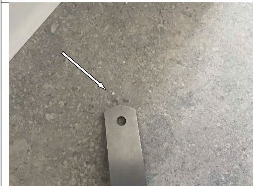
Фото №17. Загрязнения на напольной керамической плитке в коридоре.
