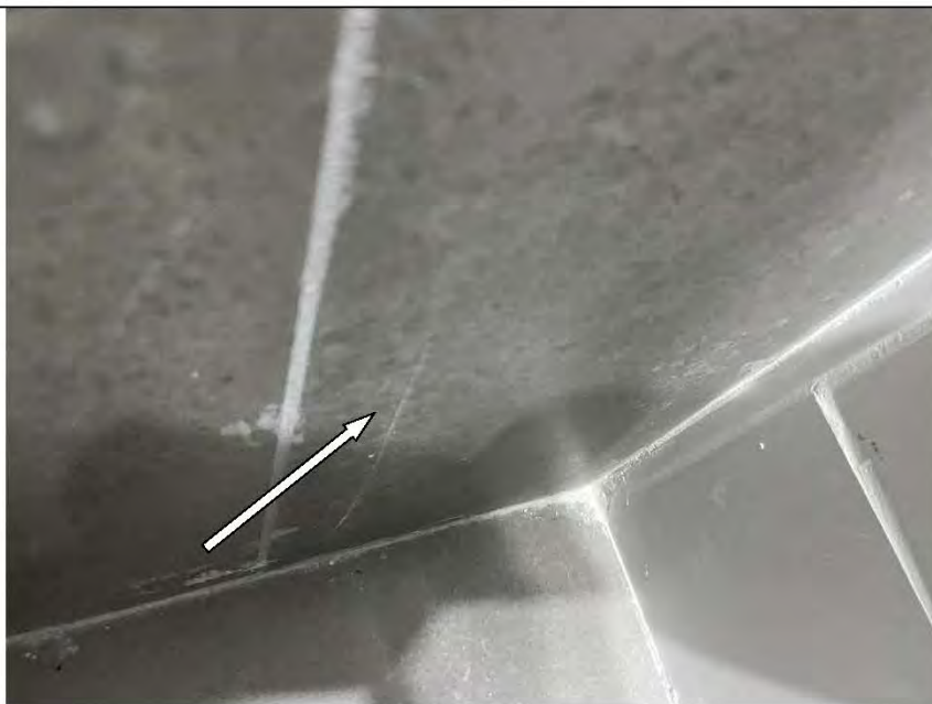
Фото №12. Трещина на настенной керамической плитке в ванной комнате.
