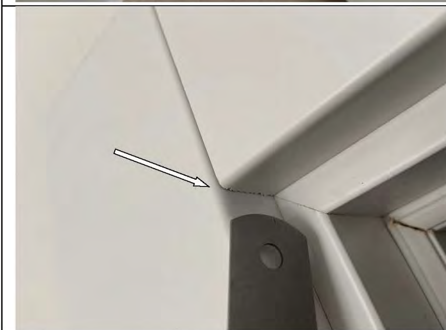
Фото №42. Дефект на наличнике деревянного дверного блока в кухне.
