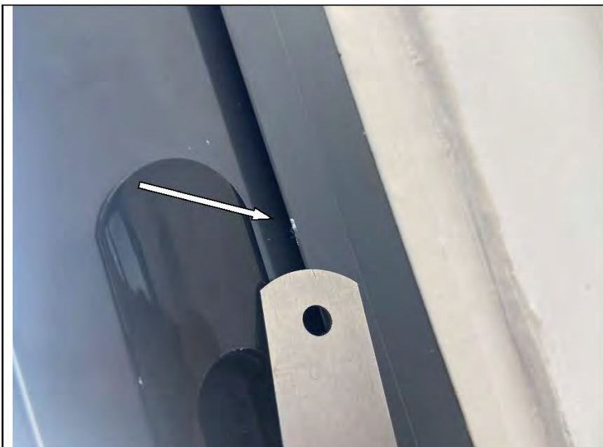
Фото №67. Загрязнения на алюминиевом профиле оконного блока на лоджии.
