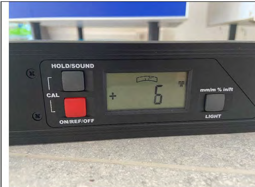
Фото №16. Отклонение напольного покрытия из керамической плитки в кухне.
