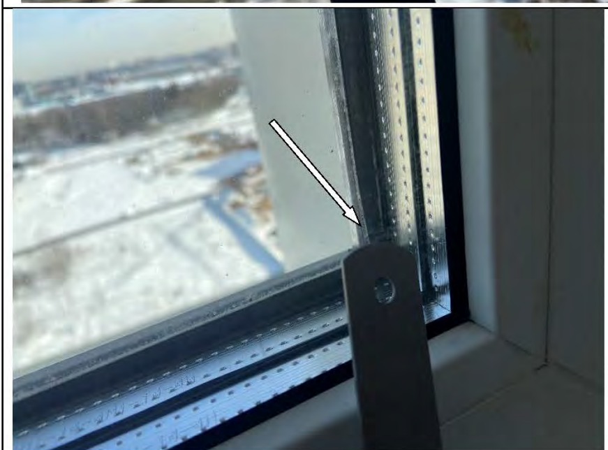
Фото №48. Царапина на стеклопакете оконного блока ПВХ в кухне.
