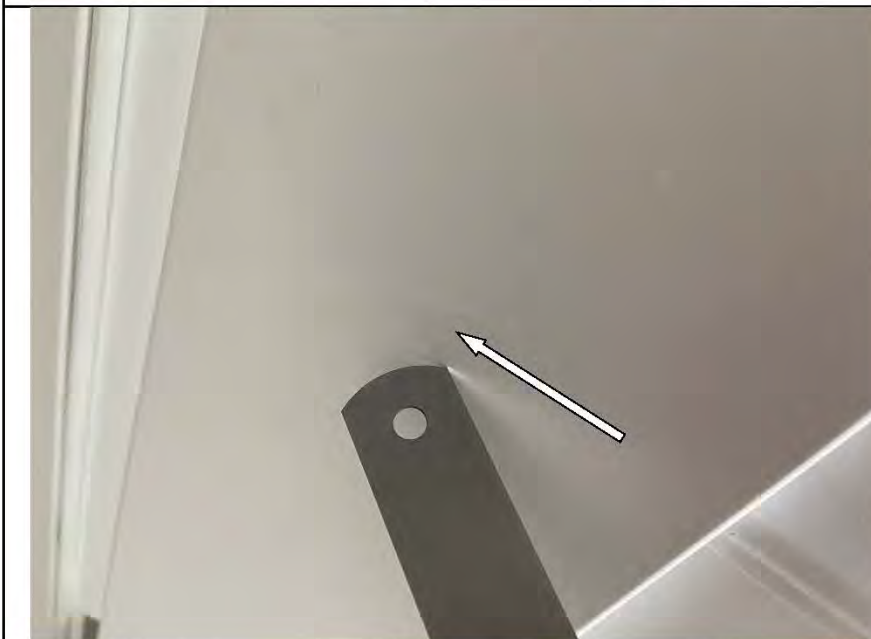
Фото №36. Загрязнения на полотне деревянного дверного блока в кухне.
