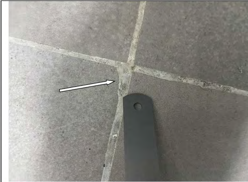
Фото №19. Загрязнения на напольной керамической плитке в ванной комнате.
