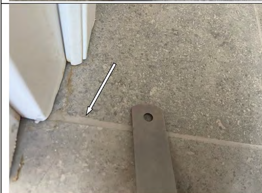
Фото №18. Загрязнения на напольной керамической плитке в кухне.
