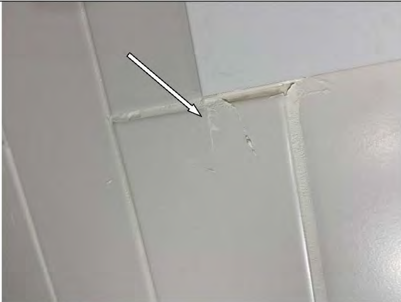
Фото №10. Загрязнения на настенной керамической плитке в ванной комнате.
