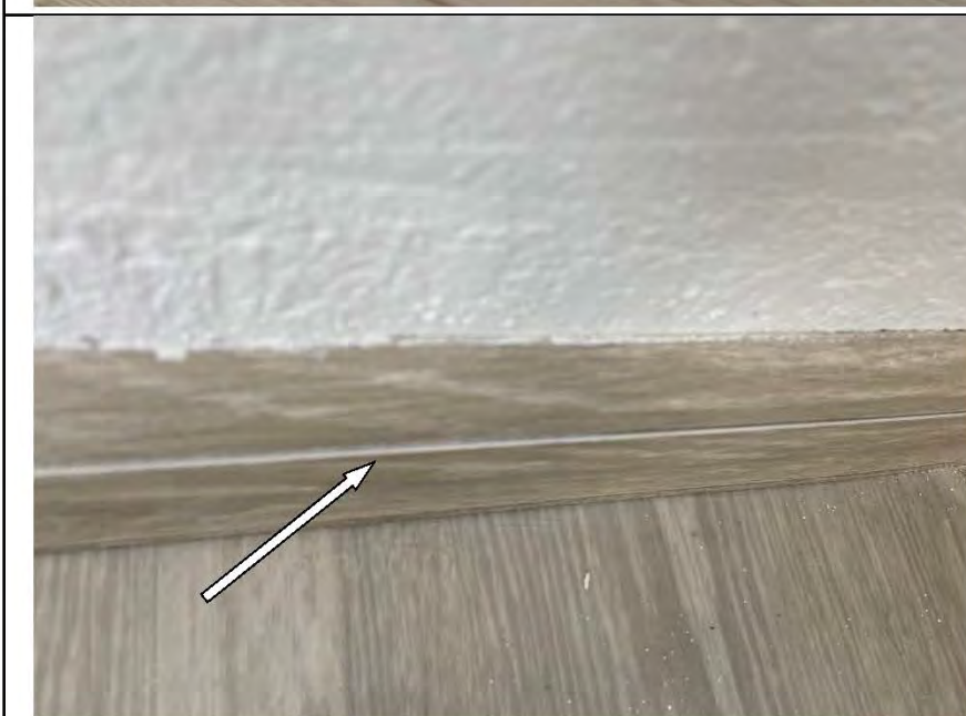
Фото №27. Дефект на напольном плинтусе ПВХ на лоджии.
