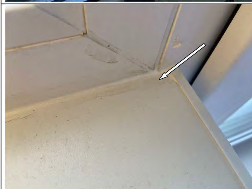
Фото №53. Загрязнения на лицевой стороне подоконной доски в спальне.
