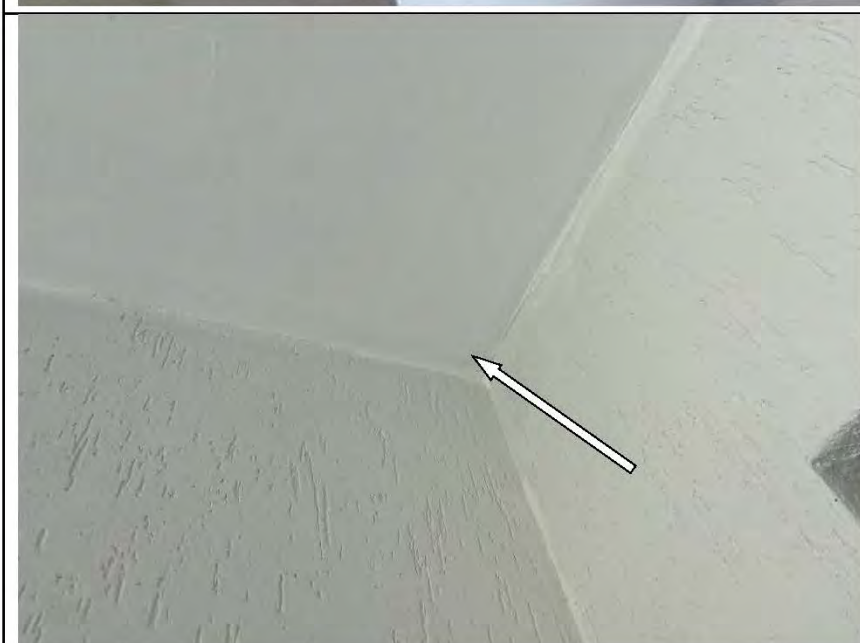
Фото №57. Выбоины, сколы, неровности на окрашенном потолке на лоджии.
