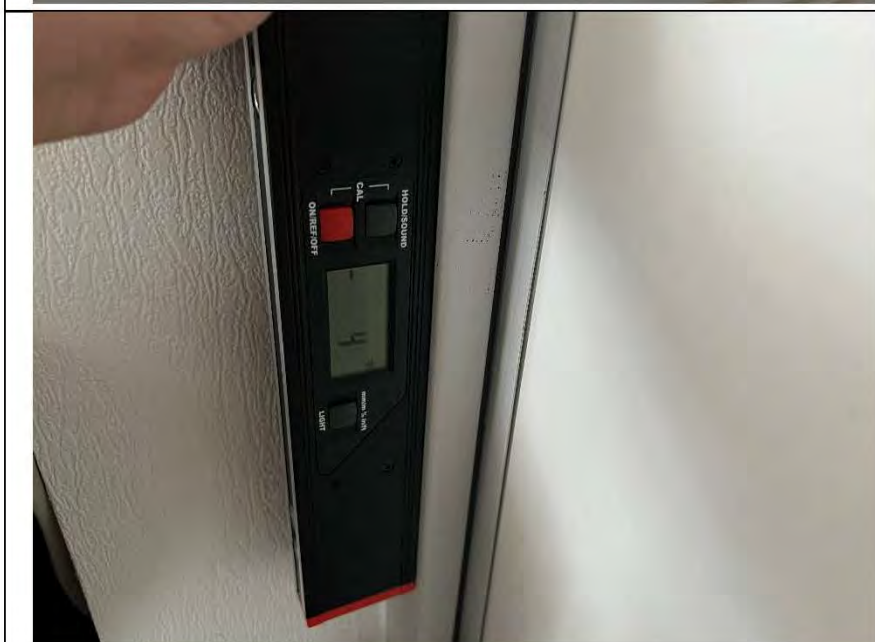
Фото №71. Отклонение коробки входного дверного блока по уровню вертикальности составляет 4 мм.
