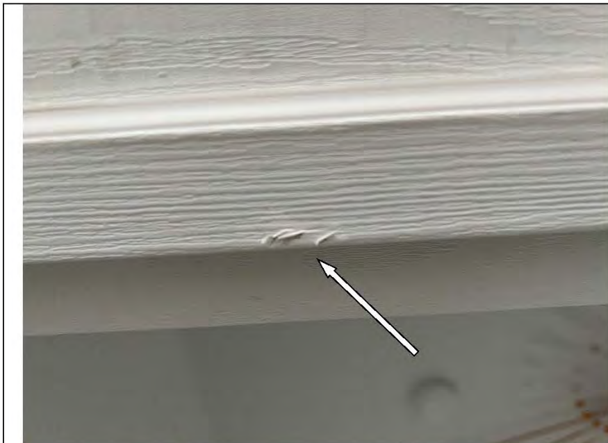
Фото №70. Скол на коробке дверного блока в спальне.
