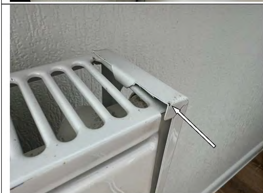
Фото №72. Скол покраски защитного кожуха отопительного прибора в спальне.
