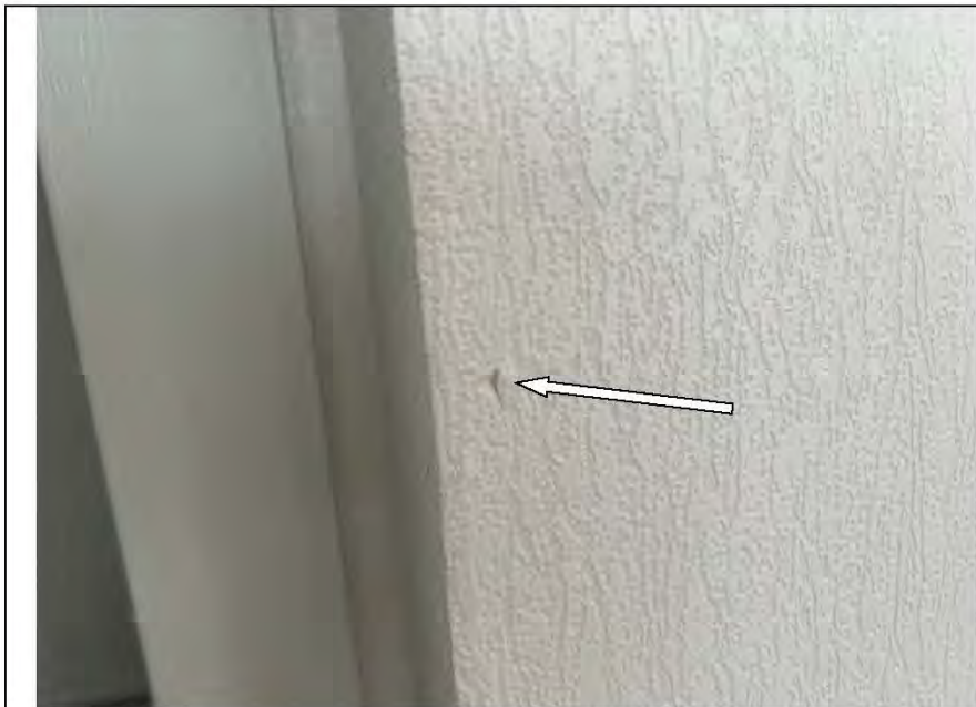
Фото №16. Скол обоевого полотна в кухне.
