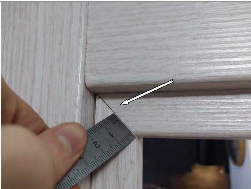
Фото №24. Элементы дверного блока соединены (коробка) не надежно в ванной комнате
