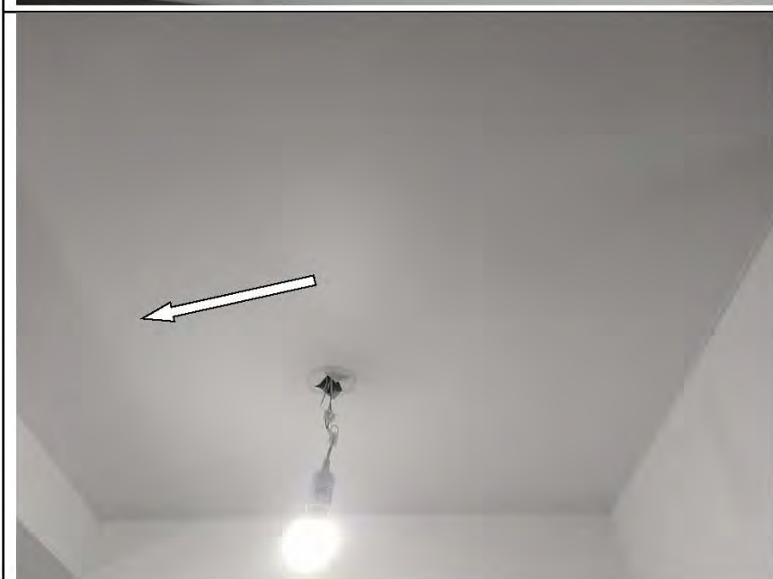
Фото №35. Дефект полотна натяжного потолка в прихожей (брак)
