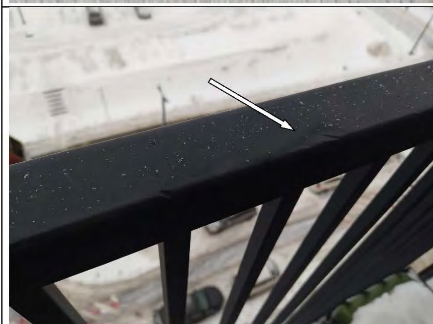
Фото №30. Дефект металлического профиля ограждения летнего помещения в спальне (скол).
