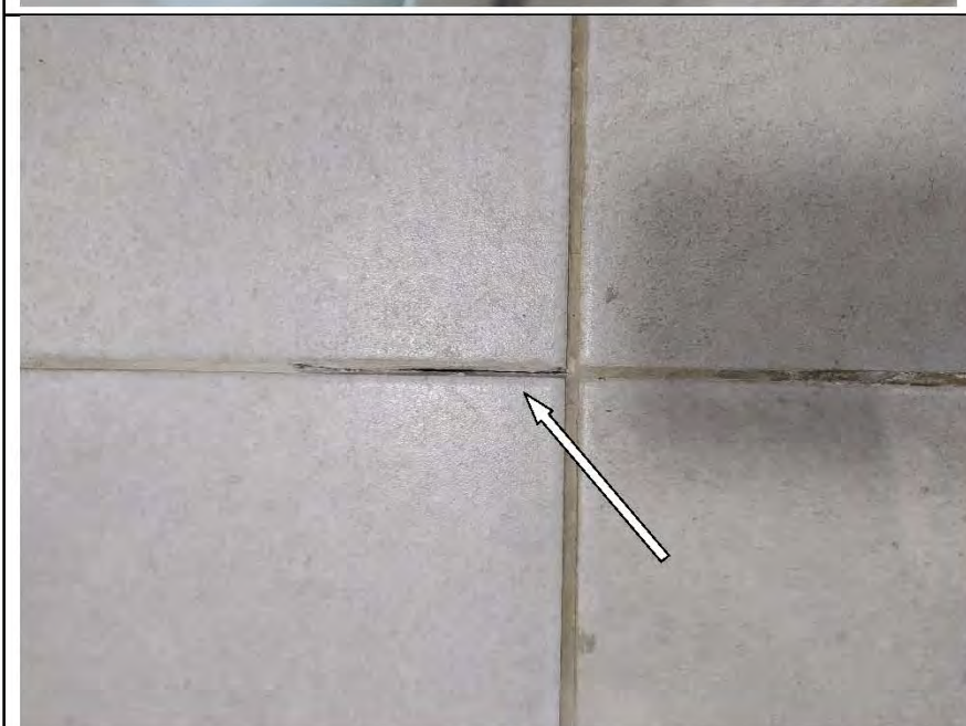
Фото №27. Затирка напольной плитки в ванной комнате выполнена с нарушениями (каверны)
