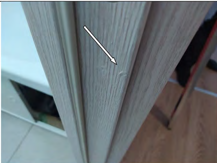
Фото №23. Коробка деревянного дверного блока в ванной комнате имеет дефекты (сколы).
