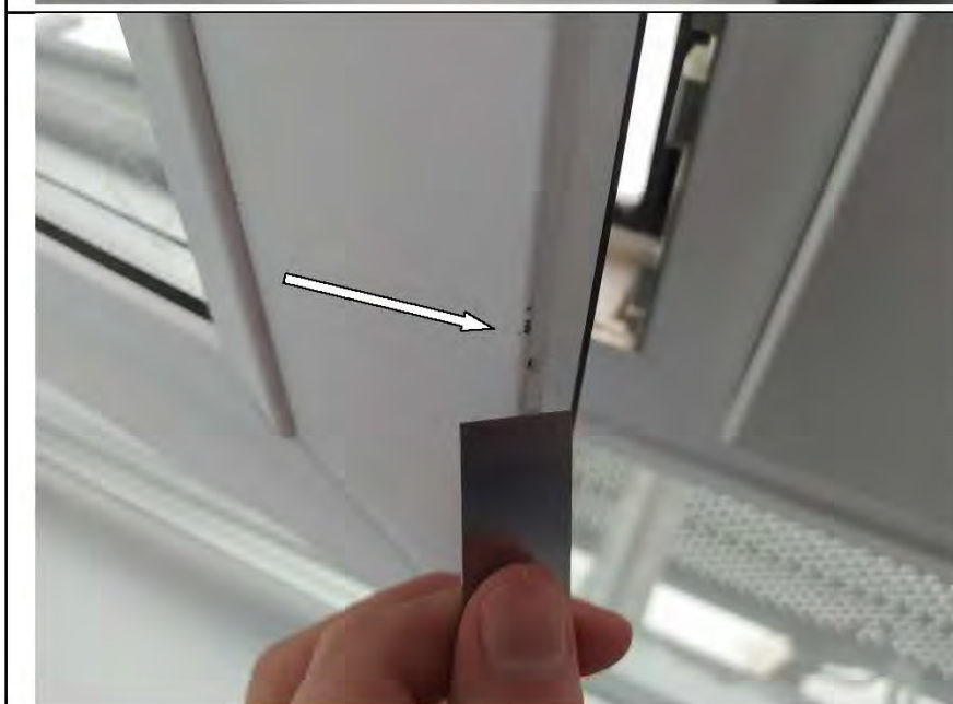
Фото №15. Профиль ПВХ оконного блока в спальне имеет дефекты (окалина).
