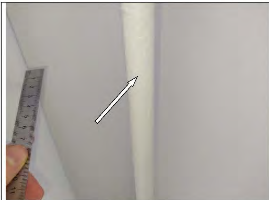
Фото №37. Окрашивание труб отопления выполнено с дефектами в кухне (подтеки).
