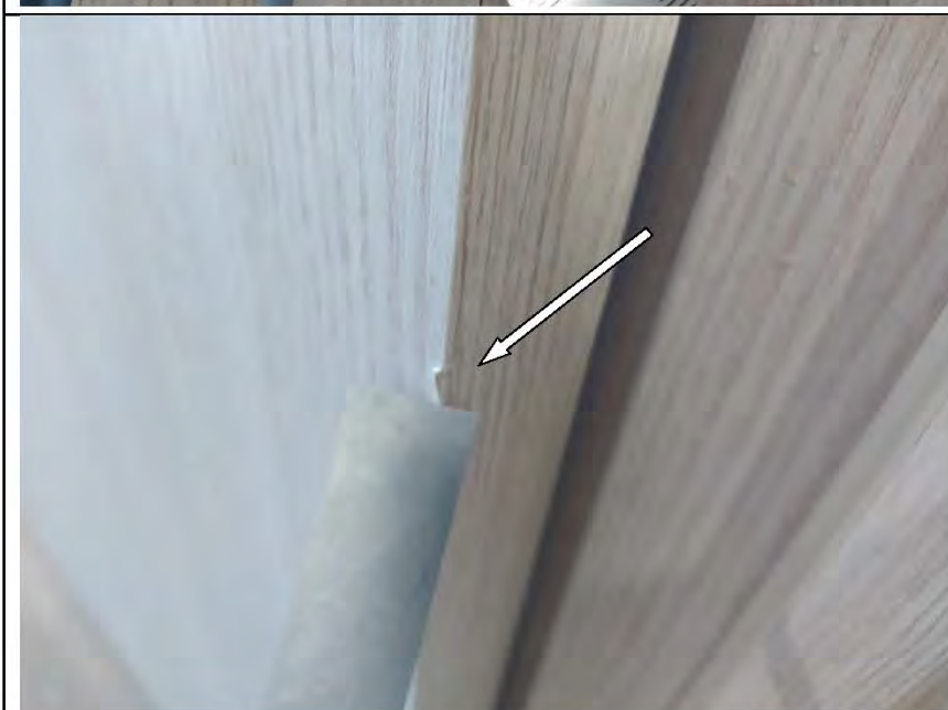
Фото №26. Дефекты (замытие) на лицевой поверхности полотна деревянного дверного блока в спальне
