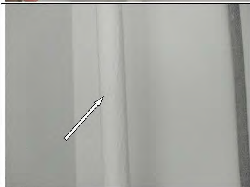
Фото №38. Окрашивание труб отопления выполнено с дефектами в спальне (подтеки).
