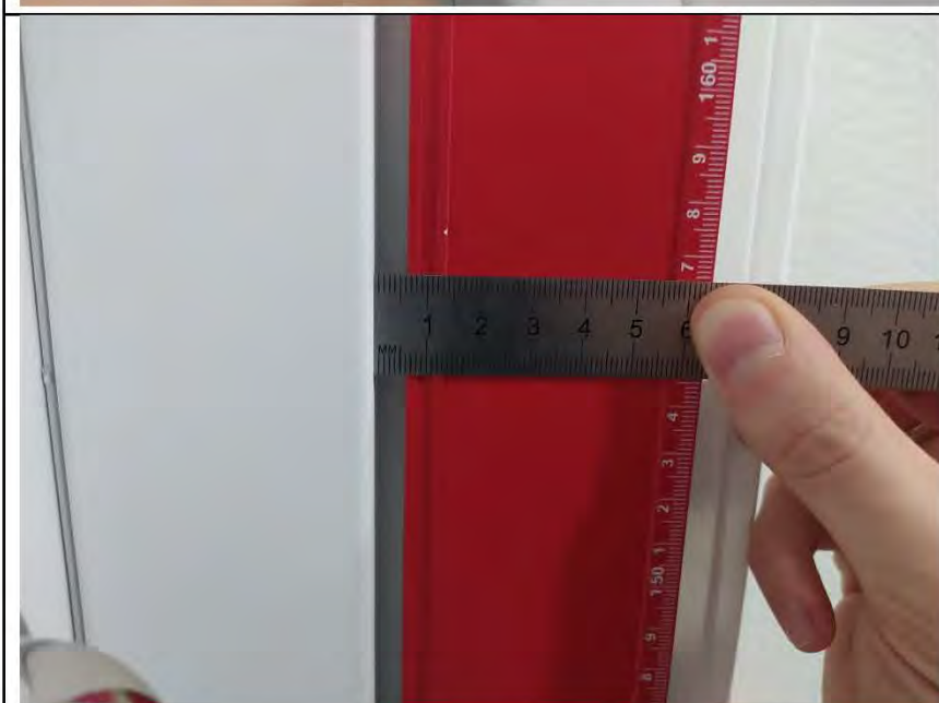
Фото №32 Отклонение коробки входного дверного блока
