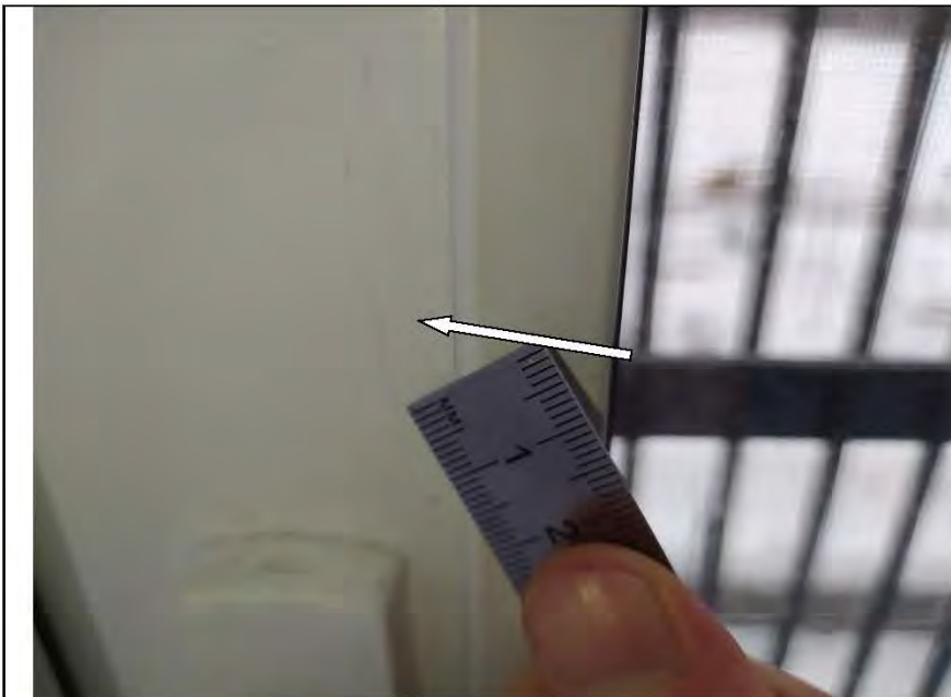
Фото №19. Профиль ПВХ дверного блока в кухне имеет дефекты (царапина).
