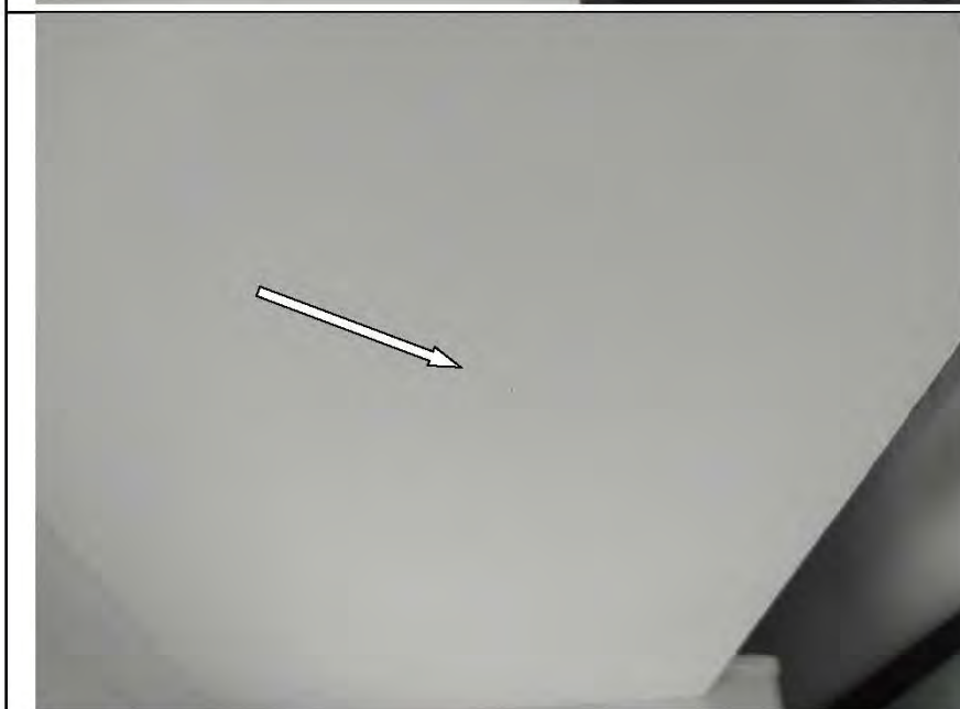
Фото №14. Окрашенные откосы оконного блока в спальне выполнены с дефектами (брызги)
