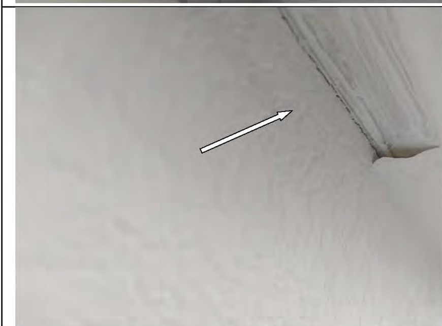
Фото №21. Отверстие под подоконником в спальне не загерметизировано
