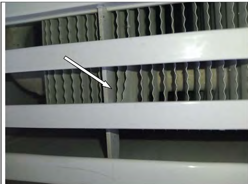
Фото №34. Радиатор в кухне имеет дефекты (замятия).
