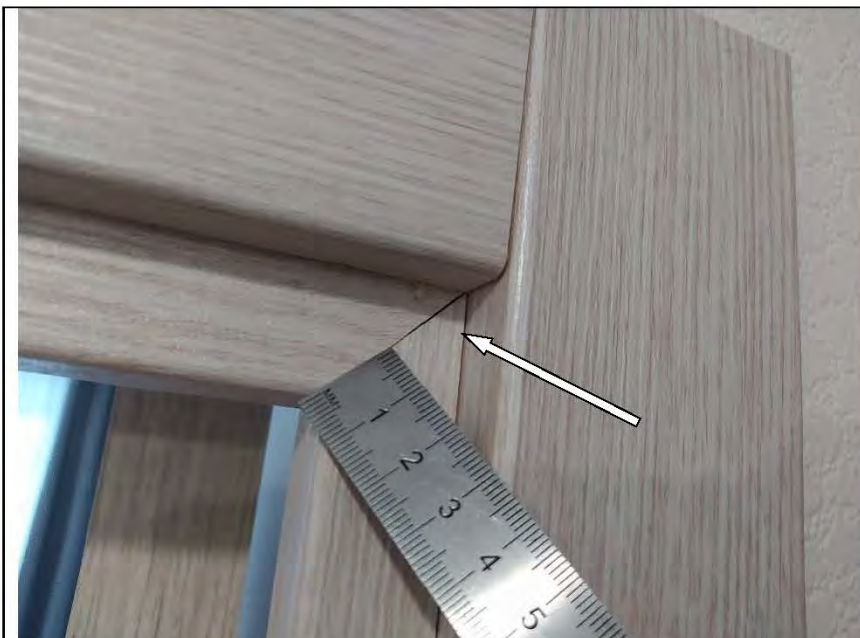
Фото №25. Элементы дверного блока соединены (коробка) не надежно в спальне
