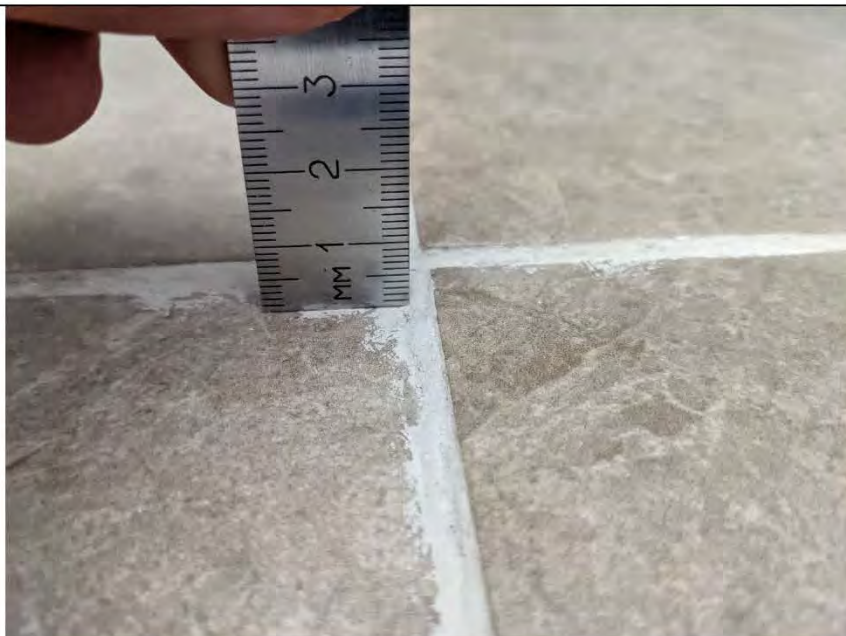
Фото №22. Уступы керамических плиток составляет 1,5 мм в санузле.
