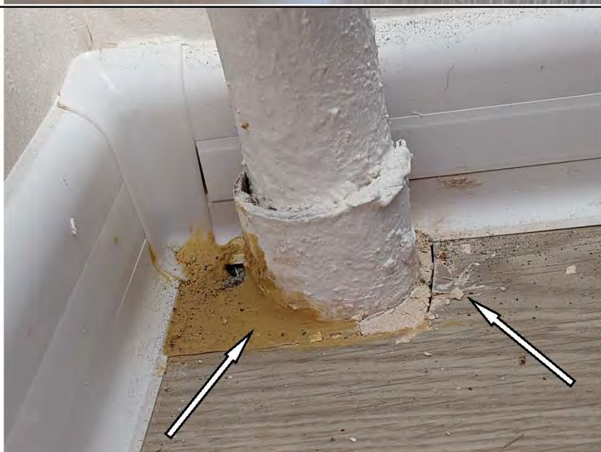
Фото №38. Загрязнения на поверхности ламината, а также заделка отверстия для труб выполнена с нарушением в спальне.
