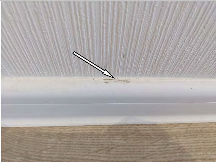
Фото №41. Загрязнение напольного плинтуса в кухне.
