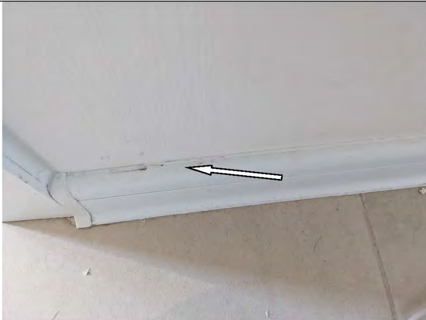
Фото №40. Загрязнение напольного плинтуса в коридоре.
