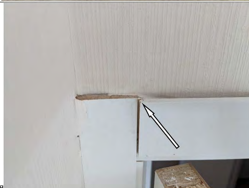
Фото №42. Элементы дверного блока соединены не надежно в спальне.
