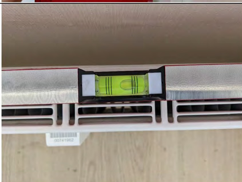
Фото №17. Радиатор смонтирован неровно в спальне.
