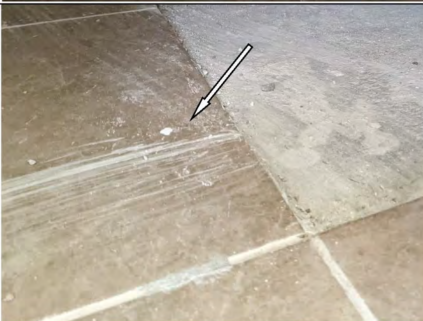
Фото №44. Загрязнение напольной керамической плитки в санузле.
