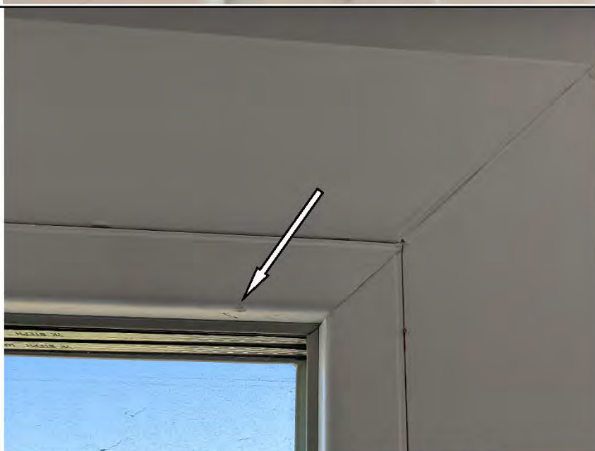
Фото №29. Дефект (царапины) на профиле оконного блока ПВХ в спальне.
