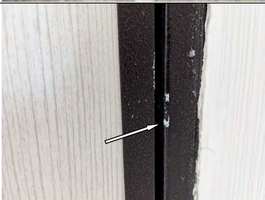
Фото №23. Дефект (загрязнения) на коробке дверного блока входной двери в коридоре.
