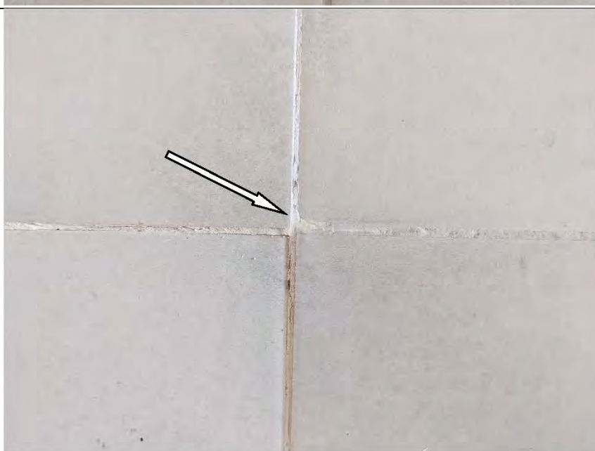
Фото №33. Затирка напольной керамической плитки в коридоре выполнена неравномерно.
