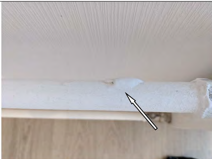
Фото №19. Неровности, загрязнения на трубах отопления в кухне.
