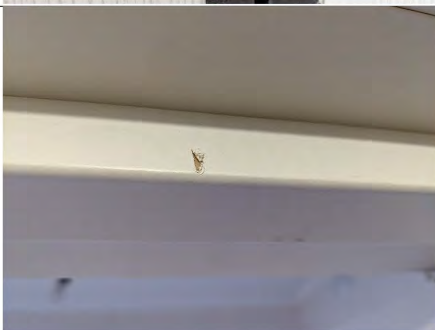
Фото №24. Дефект (скол) на коробке деревянного дверного блока в санузле.
