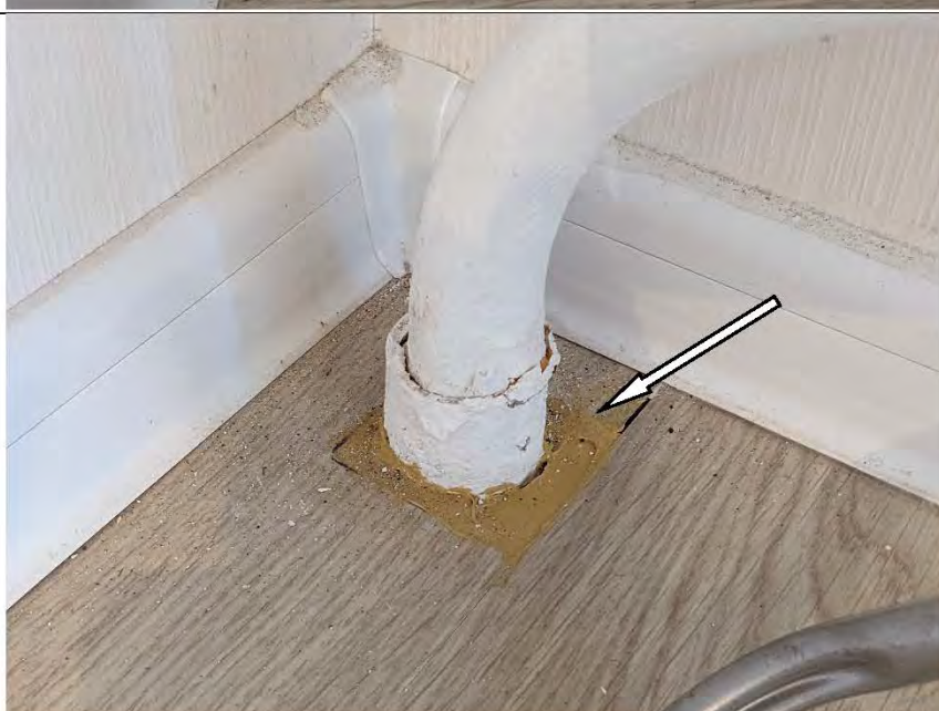
Фото №39. Заделка отверстия для труб выполнена с нарушением в кухне.
