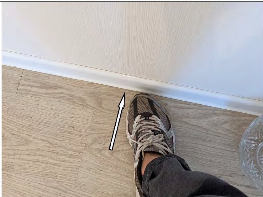
Фото №46. Ламинат прогибается при ходьбе в кухне.
