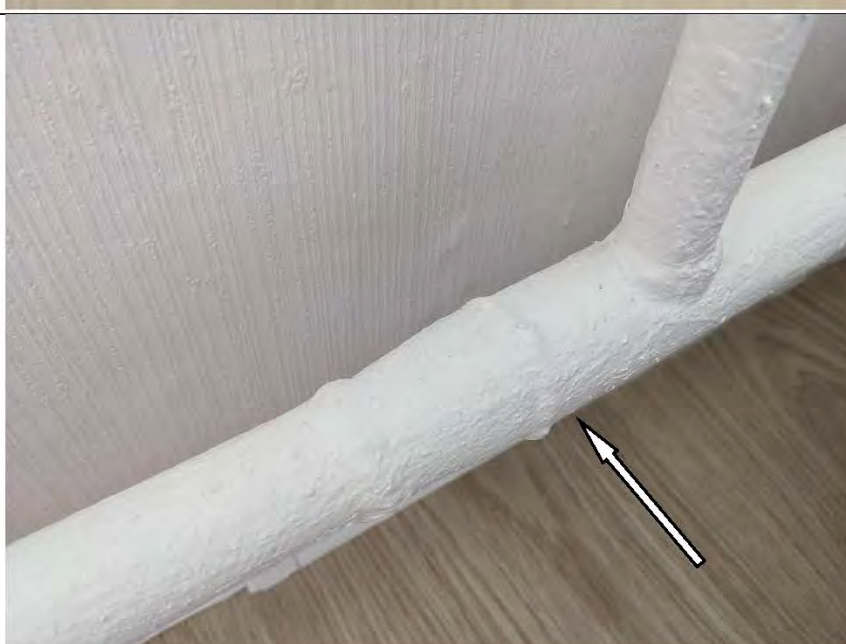
Фото №18. Неровности, загрязнения на трубах отопления в спальне.
