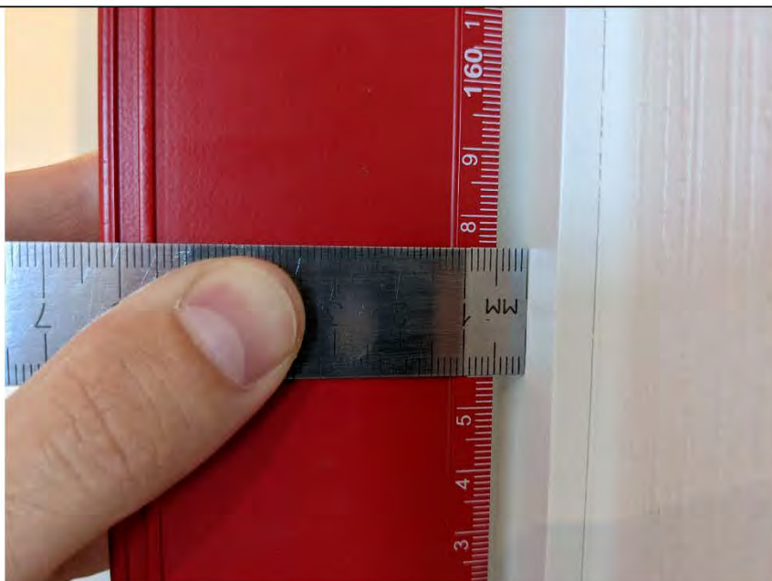
Фото №16. Отклонение коробки дверного блока равно 4,5 мм в кухне.
