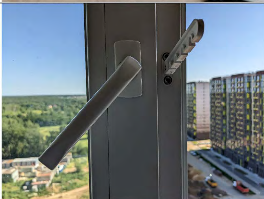
Фото №20. Требуется регулировка фурнитуры оконного блока в спальне.
