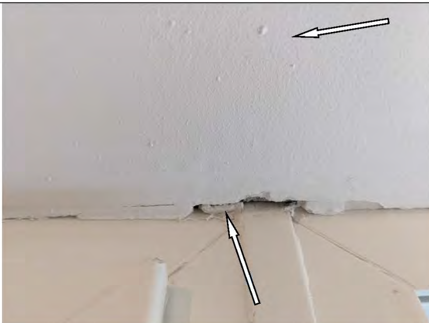
Фото №28. Дефект (неровности, отбитости) на окрашенных откосах оконного блока в кухне.
