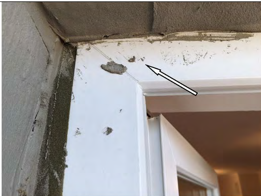
Фото №31. Дефект (загрязнения) на профиле оконного блока ПВХ в лоджии.
