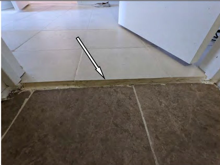
Фото №43. Отсутствует металлический порожек на шве в санузле.
