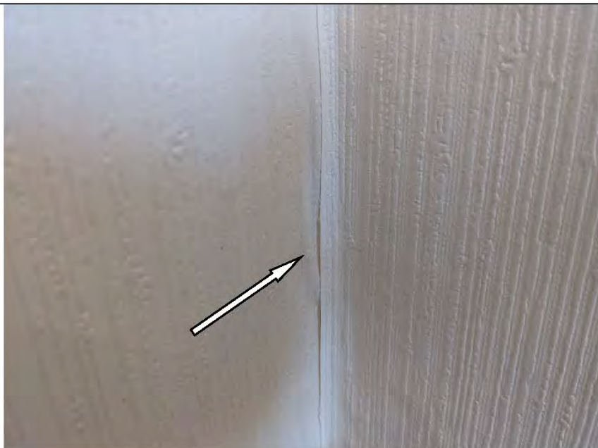
Фото №37. Отслоение, нахлест обоев в кухне.
