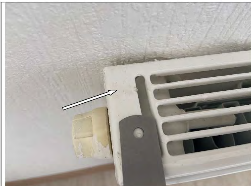
Фото №64. Загрязнения на отопительном приборе в кабинете.
