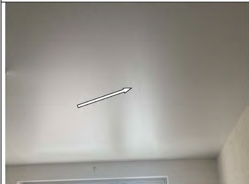
Фото №62. Загрязнения на полотне натяжного потолка в кабинете.
