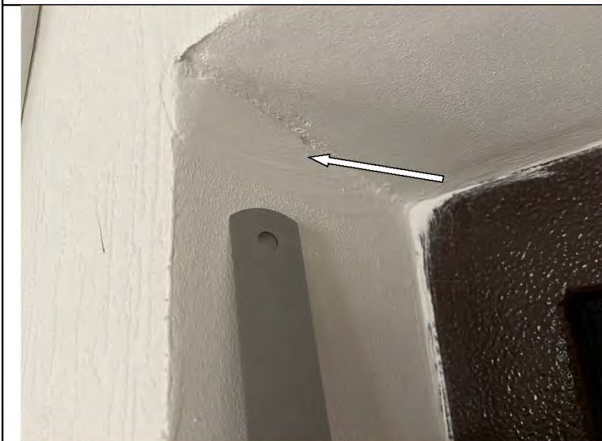
Фото №35. Неровности, сколы, выбоины, подтеки на окрашенных откосах входного дверного блока в коридоре.
