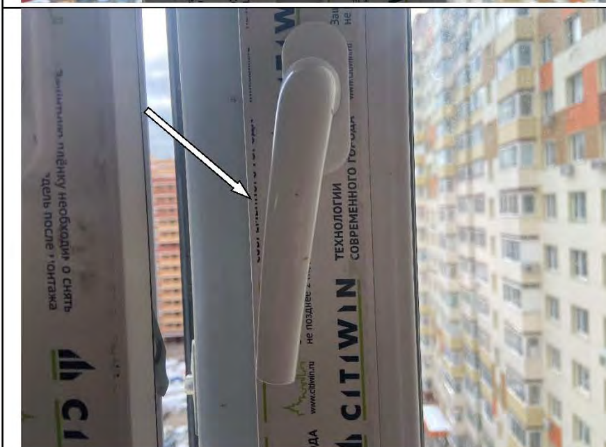
Фото №38. Не отрегулирована фурнитура оконного блока ПВХ в спальне.
