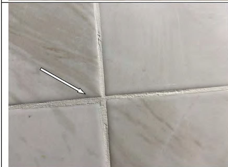
Фото №18. Неровные швы настенной керамической плитки в ванной комнате.
