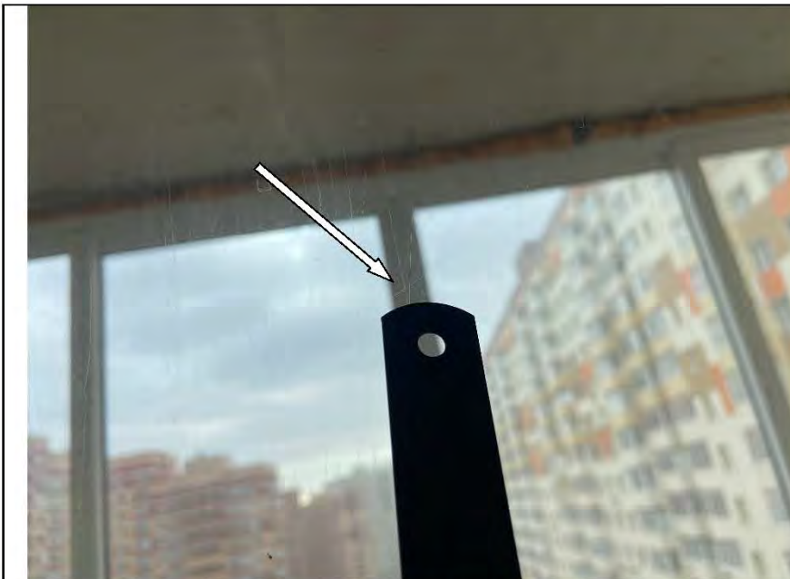
Фото №40. Царапины на стеклопакете оконного блока ПВХ в кухне.
