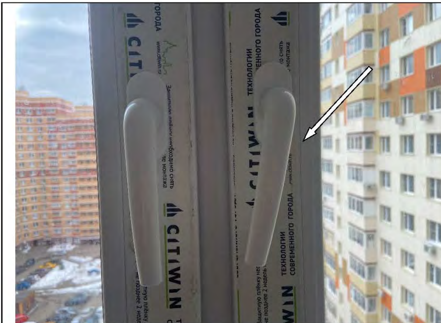
Фото №37. Не отрегулирована фурнитура оконного блока ПВХ в кабинете.
