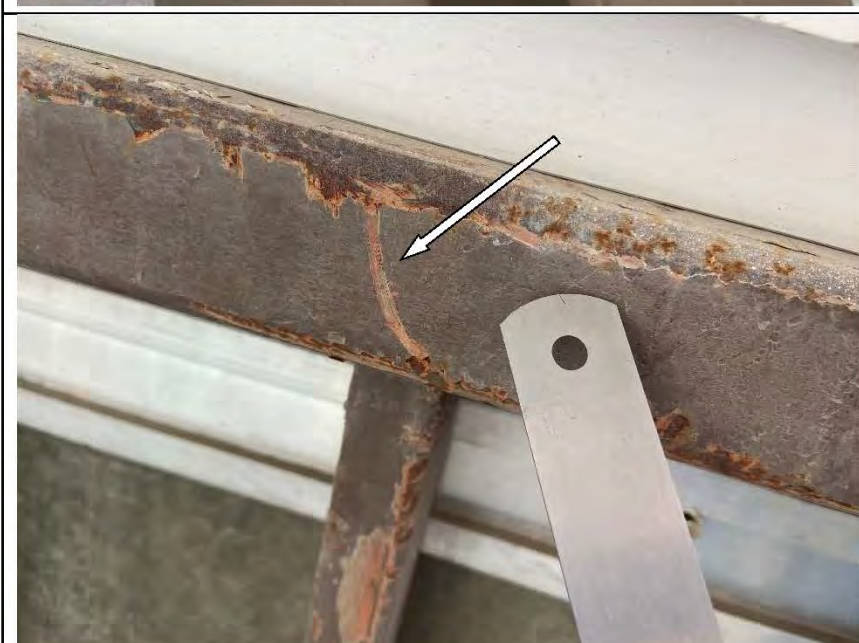
Фото №54. Дефекты на металлическом ограждении на лоджии.
