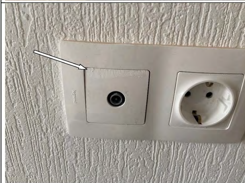
Фото №57. Загрязнения на штепсельных розетках в кухне.
