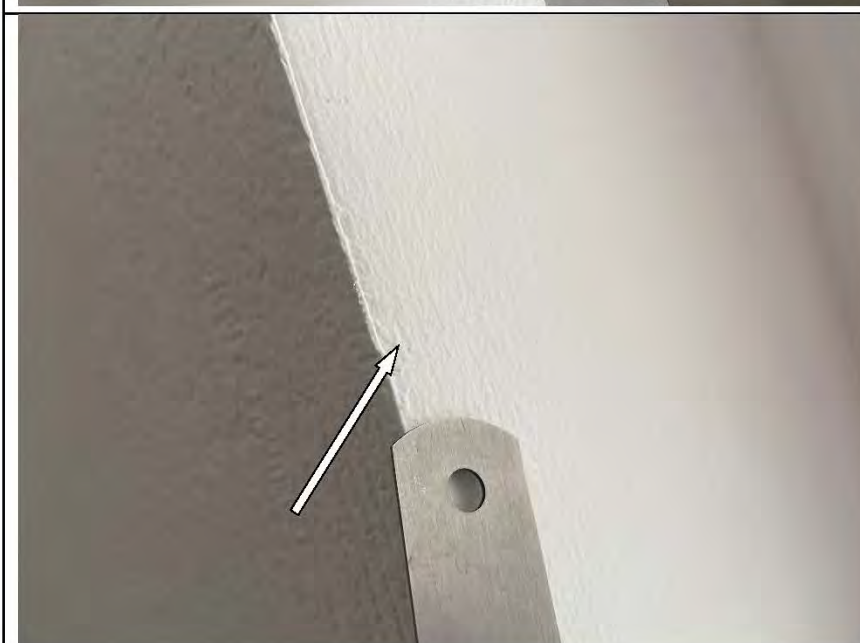
Фото №69. Неровности, сколы, выбоины на окрашенных откосах оконного блока ПВХ в спальне.
