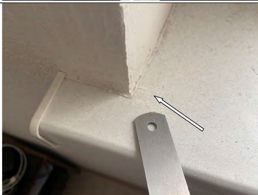
Фото №51. Загрязнения на лицевой стороне подоконной доски в спальне.
