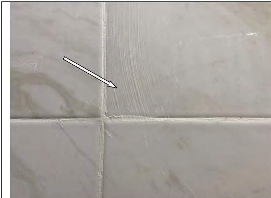
Фото №16. Загрязнения на настенной керамической плитке в ванной комнате.
