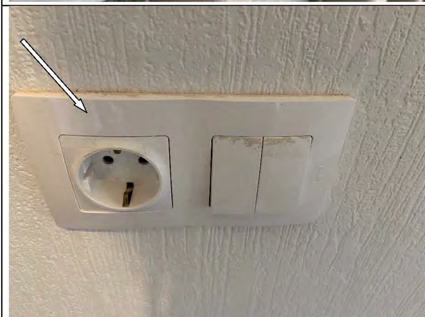
Фото №56. Загрязнения на штепсельных розетках в коридоре.
