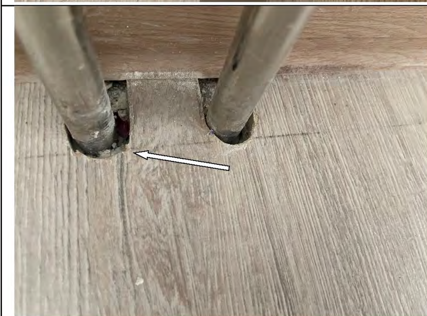
Фото №30. Дефект вставки отопительного прибора в напольное покрытие из ламината в кабинете.
