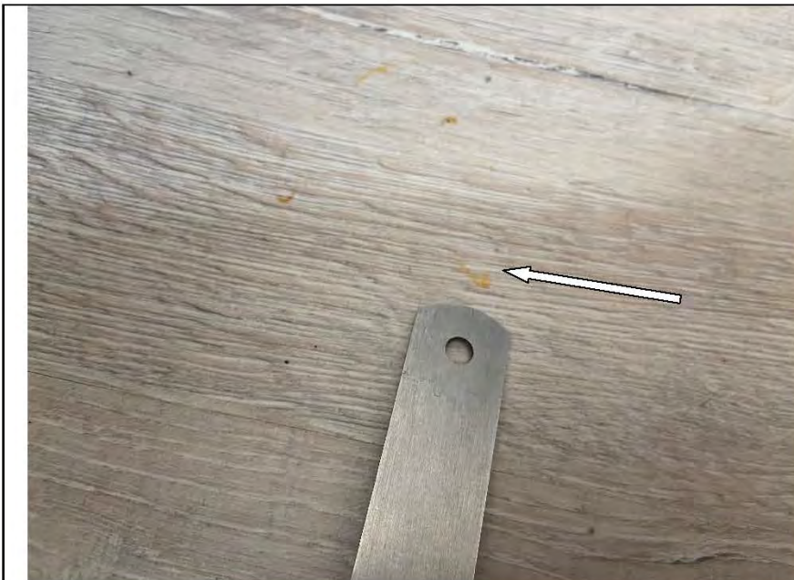
Фото №25. Загрязнения на напольном покрытии из ламината в спальне.
