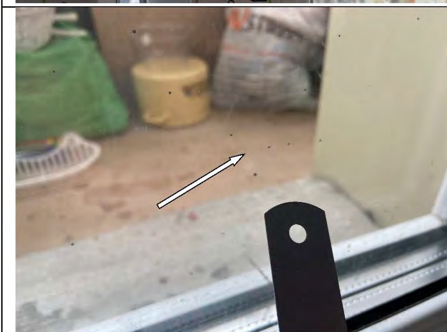
Фото №39. Окалины на стеклопакете оконного блока ПВХ в кухне.
