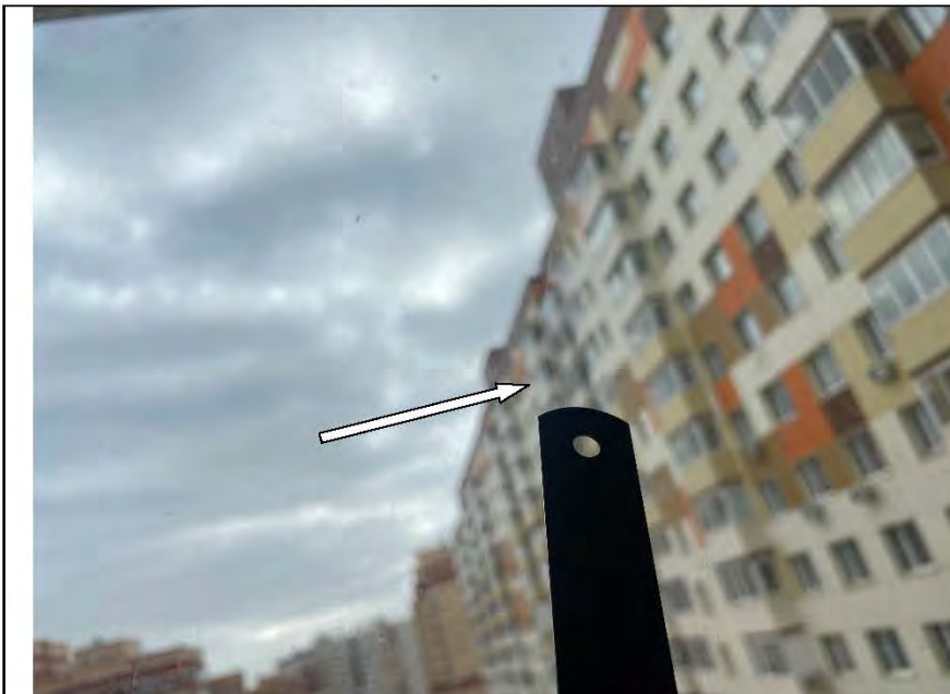
Фото №43. Царапины на стеклопакете оконного блока ПВХ в кабинете.
