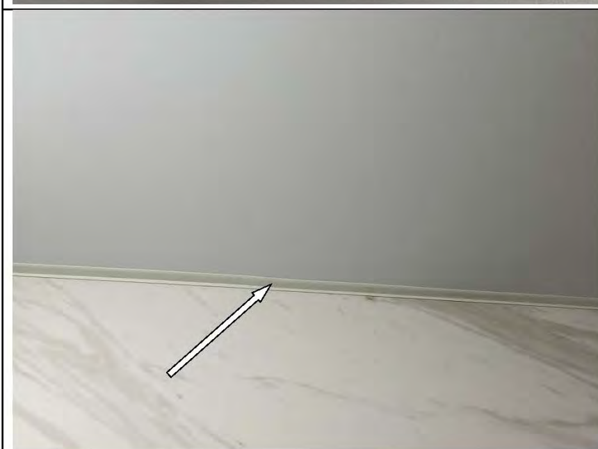
Фото №60. Загрязнения на полотне натяжного потолка в санузле.
