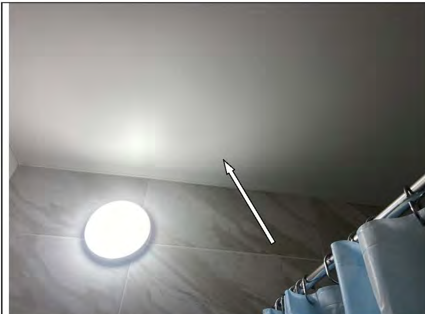
Фото №61. Загрязнения на полотне натяжного потолка в ванной комнате.
