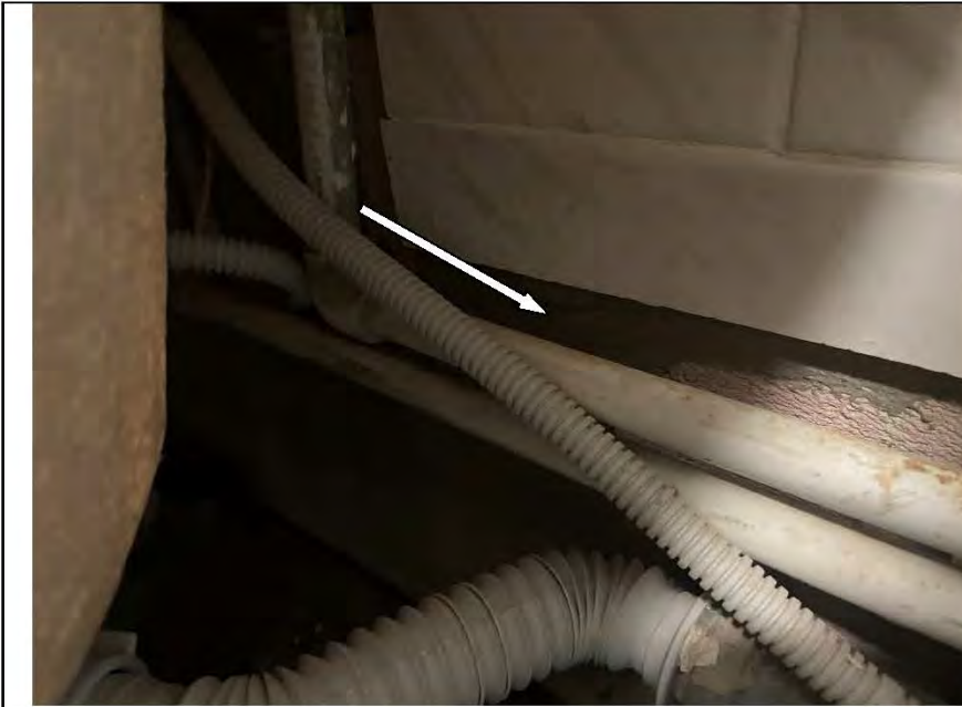
Фото №19. Частично отсутствует настенная керамическая плитка за ванной в ванной комнате.
