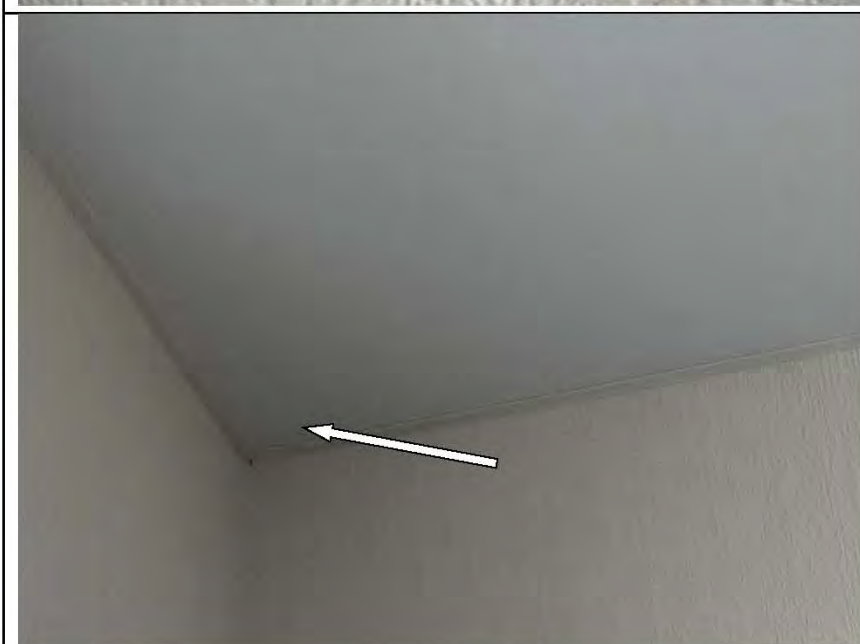
Фото №59. Загрязнения на полотне натяжного потолка в кухне.
