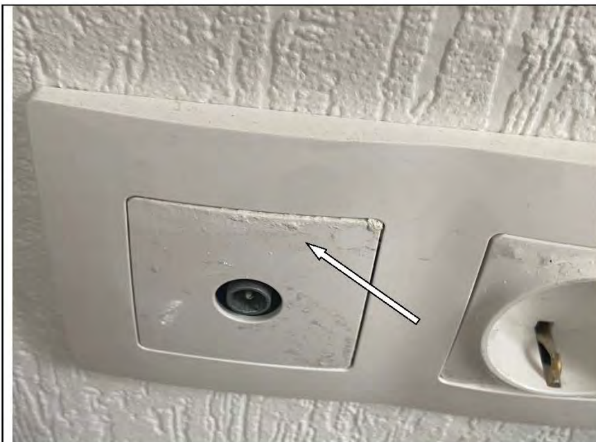
Фото №58. Загрязнения на штепсельных розетках в кабинете.
