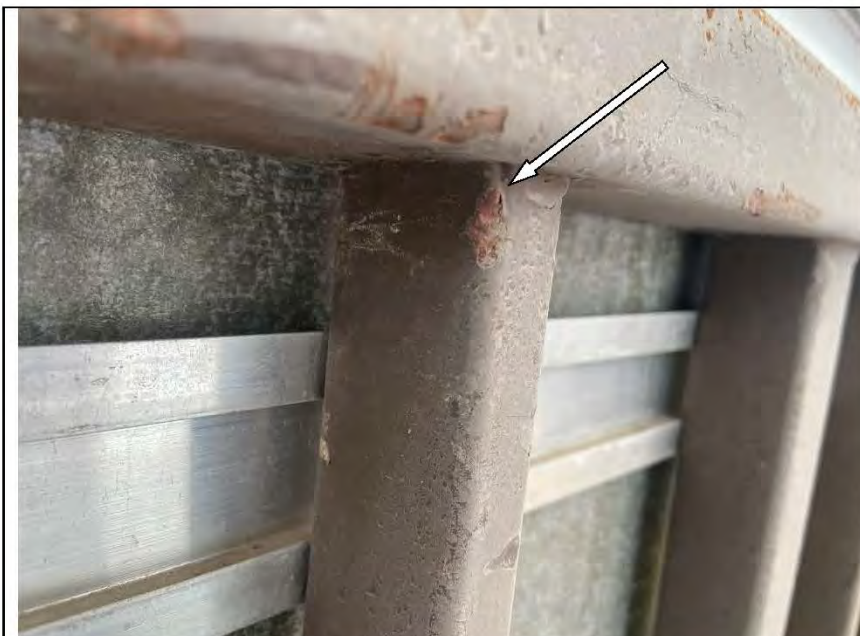
Фото №55. Дефекты на металлическом ограждении на лоджии.
