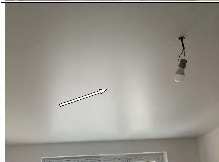
Фото №63. Загрязнения на полотне натяжного потолка в спальне.
