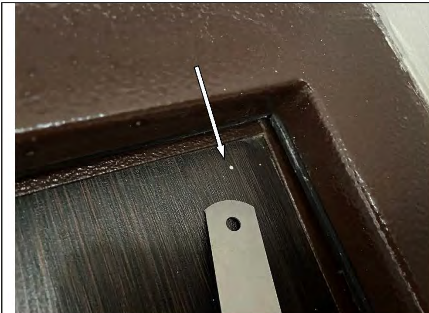
Фото №34. Загрязнения на полотне входного дверного блока в коридоре.
