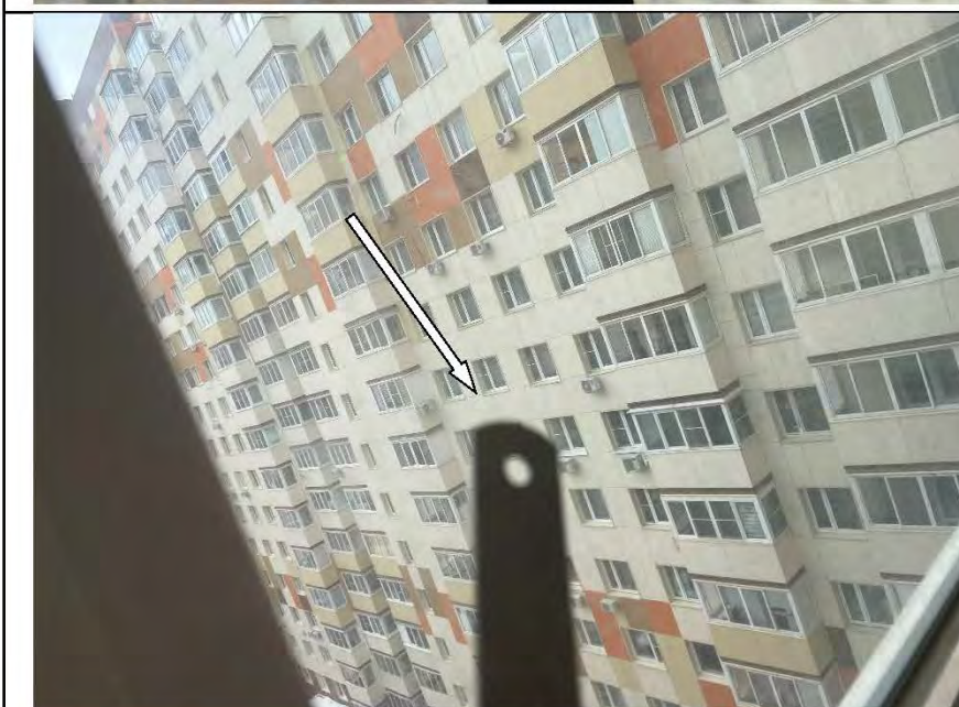
Фото №41. Царапины на стеклопакете оконного блока ПВХ на лоджии.
