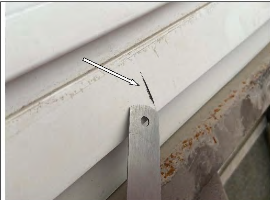
Фото №52. Царапина на алюминиевом профиле оконного блока на лоджии.
