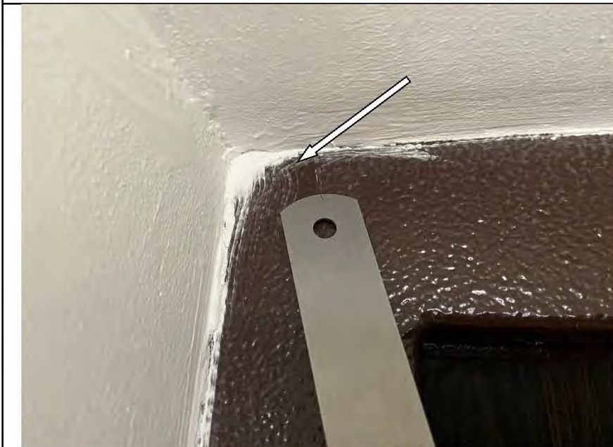
Фото №32. Загрязнения на коробке входного дверного блока в коридоре.
