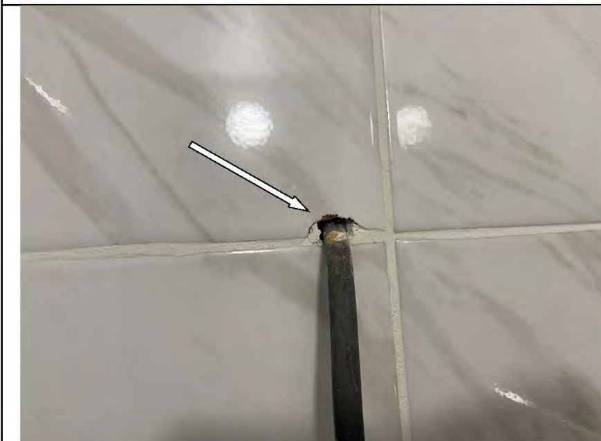
Фото №20. Скол на настенной керамической плитке в ванной комнате.
