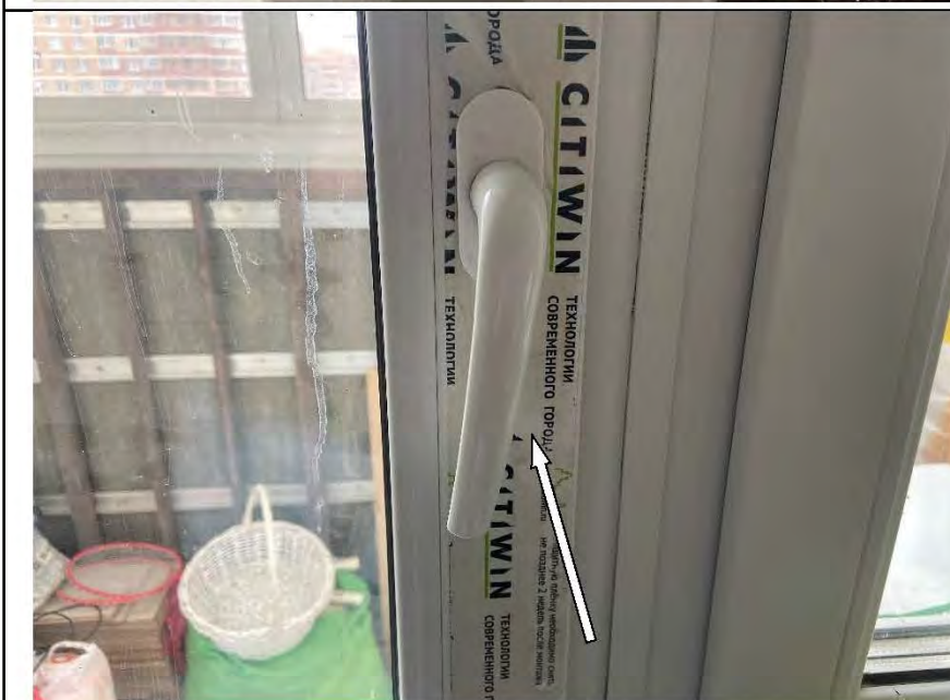
Фото №36. Не отрегулирована фурнитура оконного блока ПВХ в кухне.
