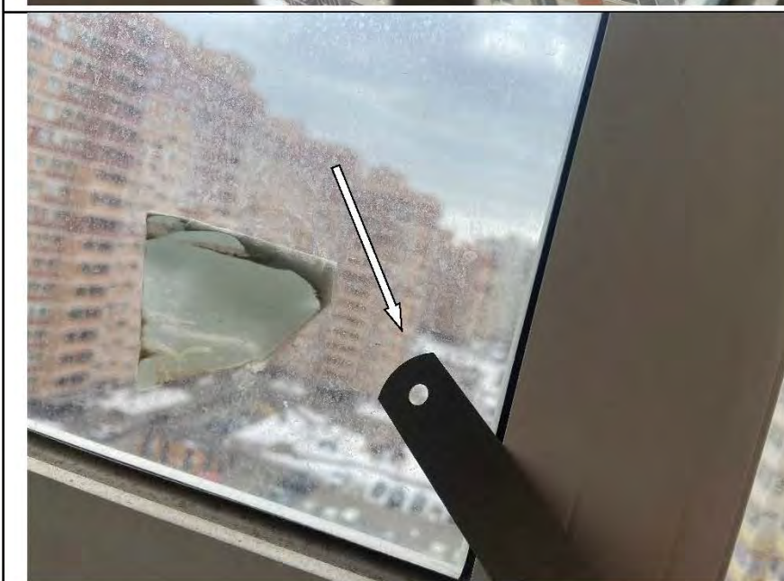
Фото №42. Царапины на стеклопакете оконного блока ПВХ на лоджии.
