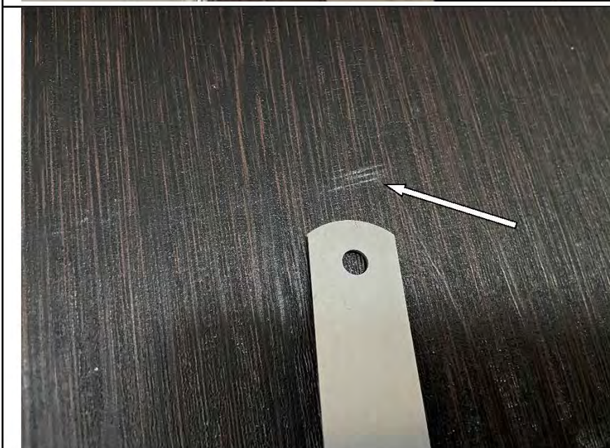
Фото №33. Загрязнения на полотне входного дверного блока в коридоре.
