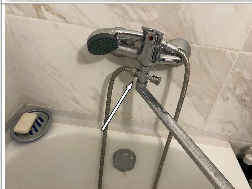
Фото №66. Протечка арматуры смесителя ванны в ванной комнате.
