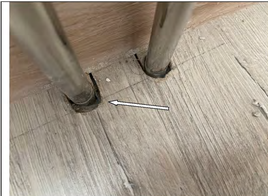
Фото №31. Дефект вставки отопительного прибора в напольное покрытие из ламината в спальне.
