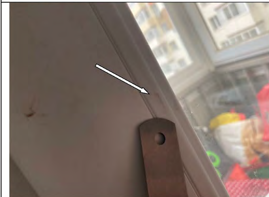
Фото №44. Загрязнения на профиле оконного блока ПВХ в кухне.
