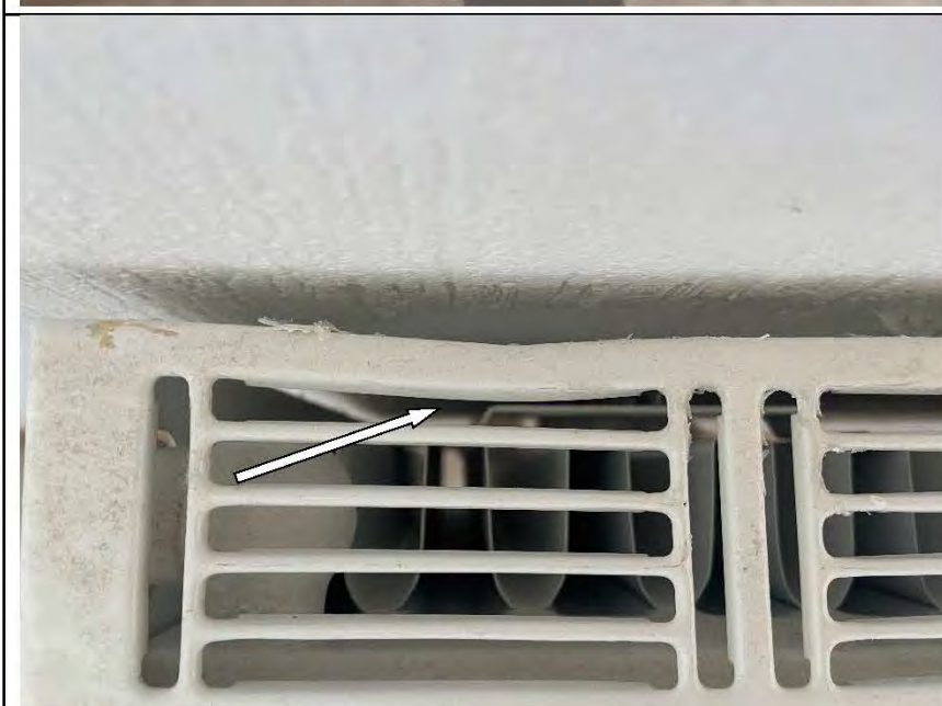
Фото №65. Загиб на отопительном приборе в спальне.
