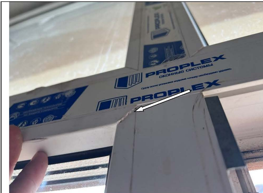
Фото №31. Зазоры в стыке профилей оконного блока ПВХ в гостиной.
