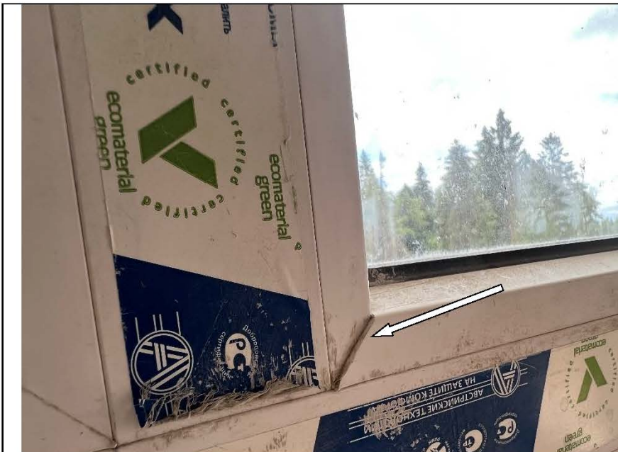
Фото №34. Зазоры в стыке профилей оконного блока ПВХ в спальне.
