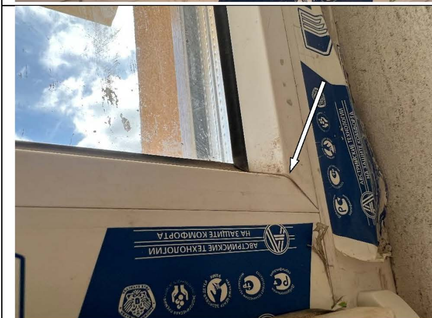
Фото №35. Зазоры в стыке профилей оконного блока ПВХ в спальне.
