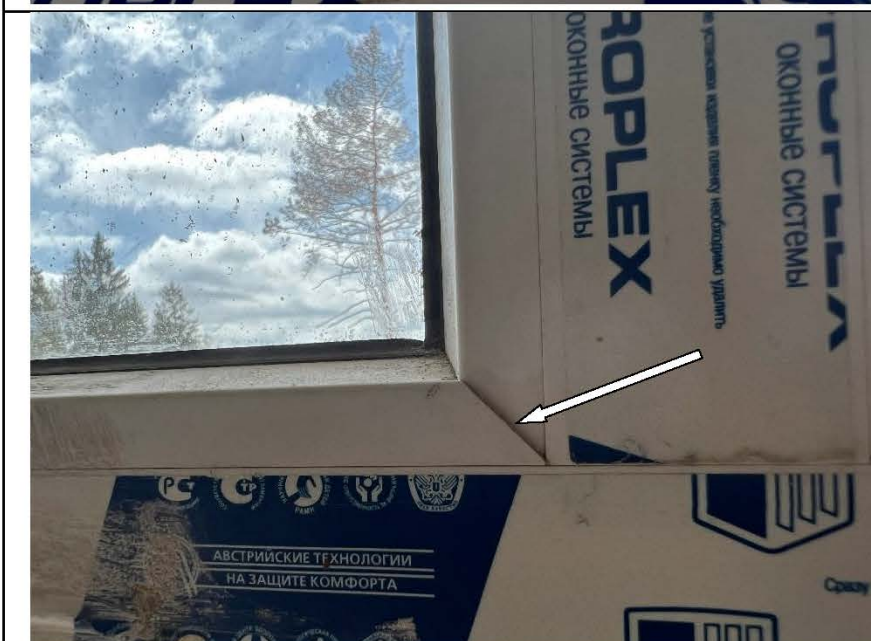
Фото №33. Зазоры в стыке профилей оконного блока ПВХ в спальне.
