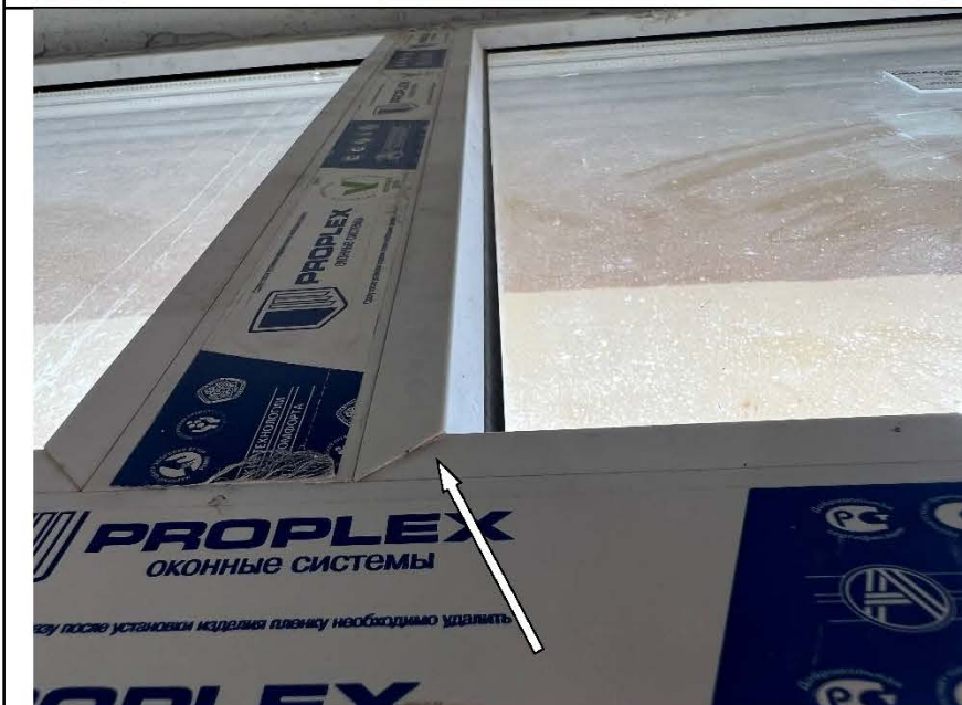
Фото №32. Зазоры в стыке профилей оконного блока ПВХ в гостиной.
