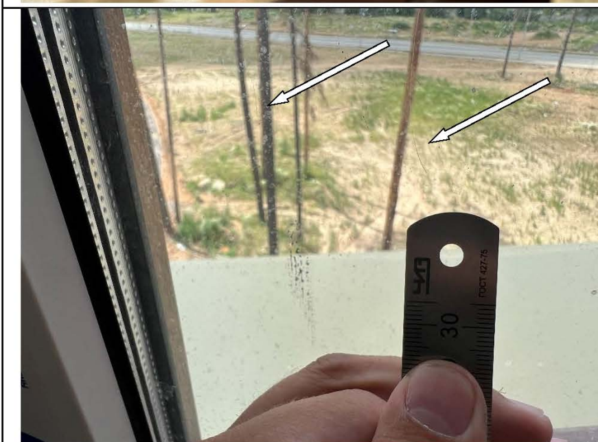
Фото №27. Царапина на стеклопакете оконного блока ПВХ в спальне.
