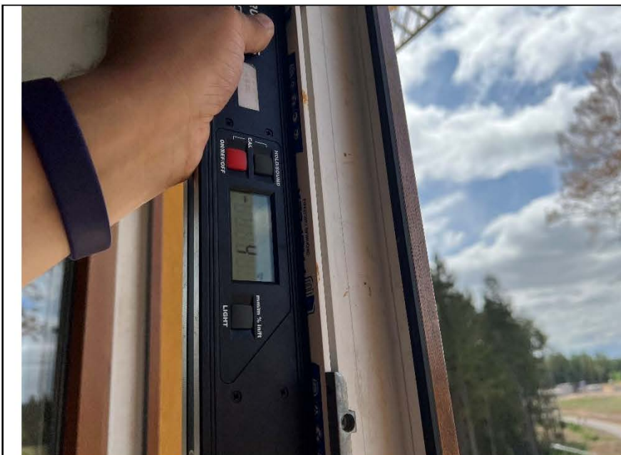
Фото №43. Отклонение оконного блока ПВХ в спальне по уровню вертикальности составляет 4 мм.
