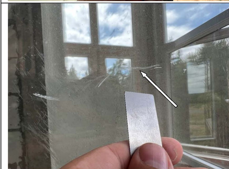
Фото №30. Царапина на стеклопакете дверного блока ПВХ в кухне.
