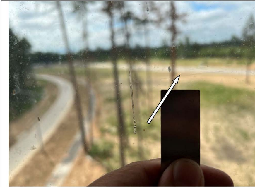
Фото №25. Царапина на стеклопакете оконного блока ПВХ в гостиной.
