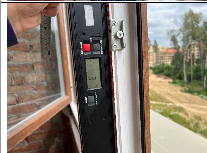
Фото №41. Отклонение оконного блока ПВХ на лоджии по уровню вертикальности составляет 3 мм.
