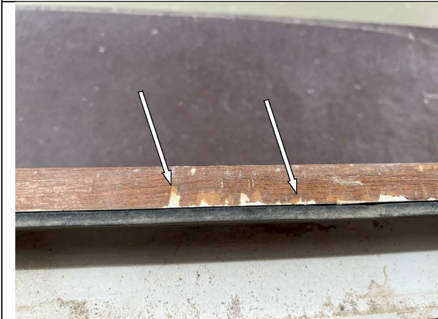
Фото №38. Механические повреждения (царапины) профиля ПВХ оконного блока в спальне.
