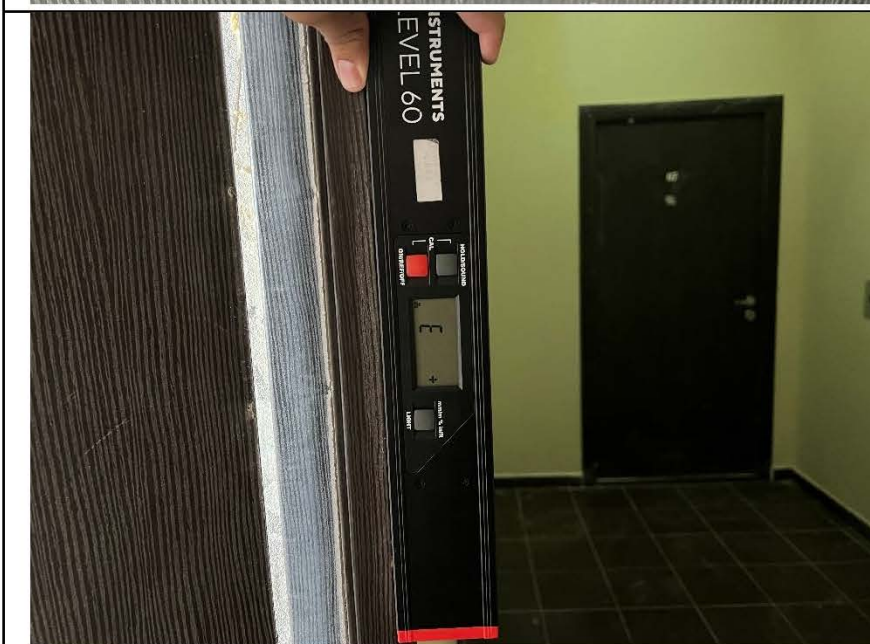
Фото №48. Отклонение коробки от плоскостности и прямолинейности деревянного входного дверного блока равняется 3 мм.
