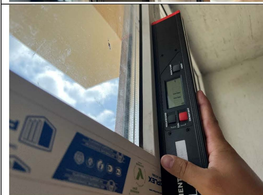
Фото №45. Отклонение оконного блока ПВХ в спальне по уровню вертикальности составляет 11 мм.
