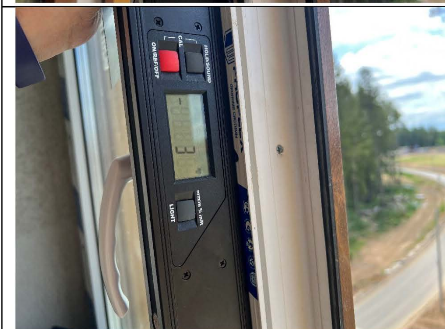
Фото №44. Отклонение оконного блока ПВХ в спальне по уровню вертикальности составляет 3 мм.
