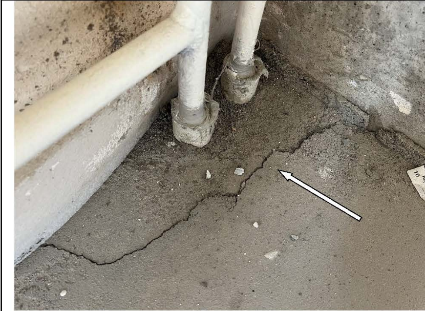
Фото №16. Трещина готовой стяжки пола в гостиной.
