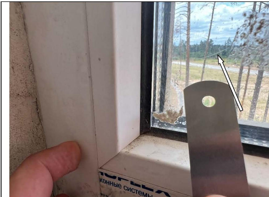
Фото №28. Царапина на стеклопакете оконного блока ПВХ в спальне.
