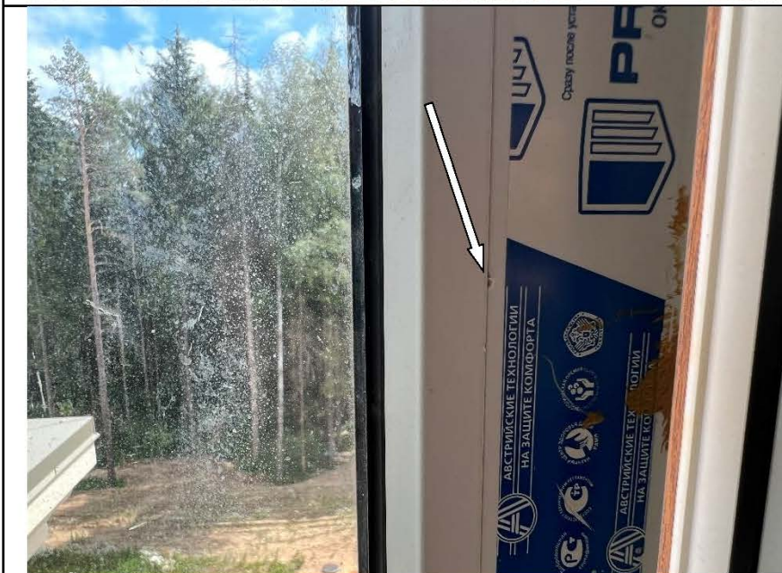
Фото №39. Механические повреждения профиля ПВХ оконного блока в спальне.
