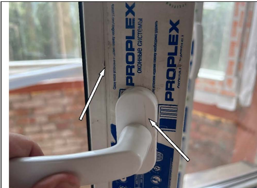
Фото №40. Механические повреждения профиля ПВХ дверного блока в кухне.
