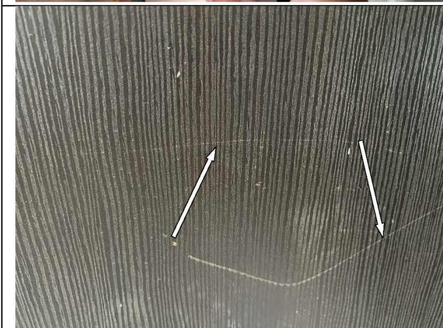
Фото №47. Царапины на лицевой поверхности полотна деревянного дверного входного блока.
