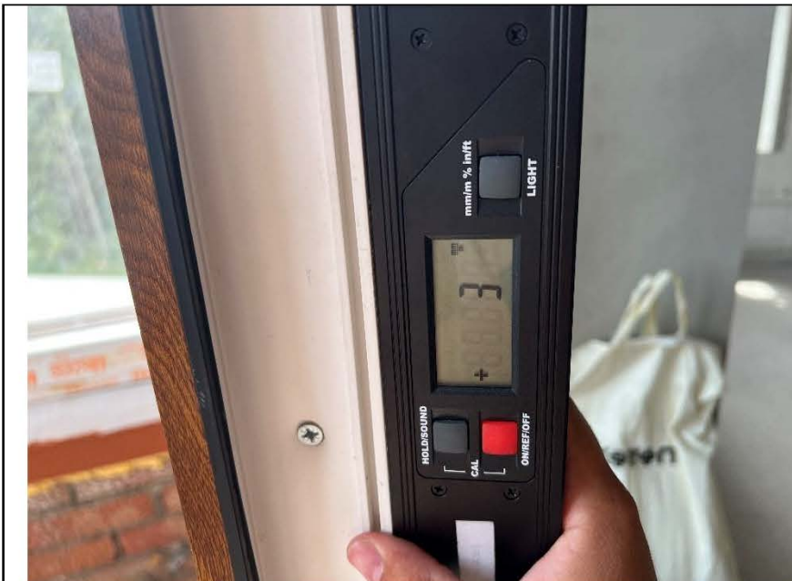
Фото №46. Отклонение оконного блока ПВХ в кухне по уровню вертикальности составляет 3 мм.
