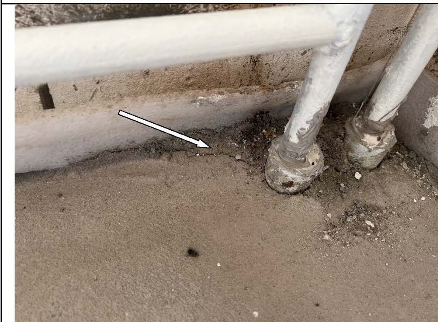
Фото №17. Трещина готовой стяжки пола в спальне.
