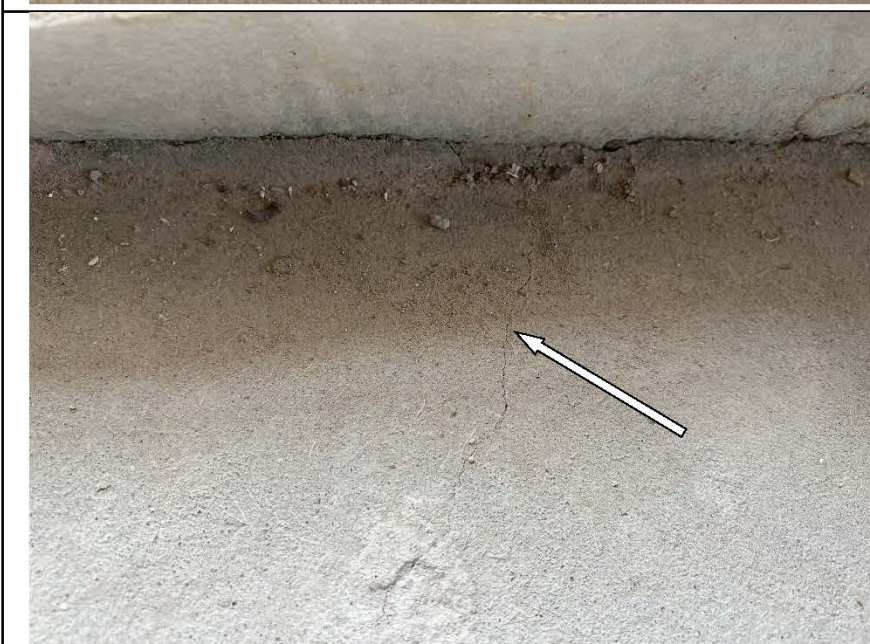
Фото №18. Трещина готовой стяжки пола в кухне.
