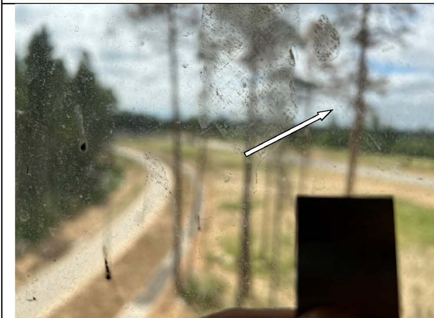
Фото №26. Царапина на стеклопакете оконного блока ПВХ в гостиной.
